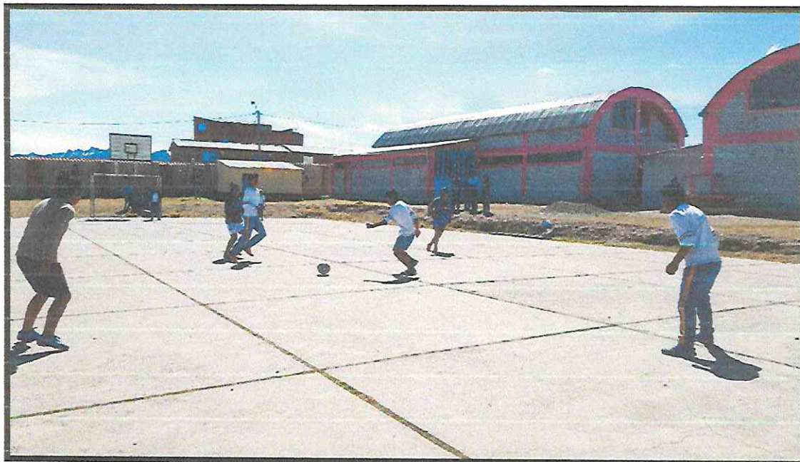
Imagen 15: A simple vista se aprecia el mala estado de la única losa deportiva.
