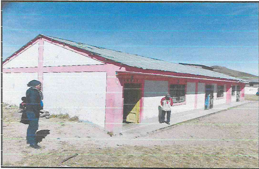
Figura 5. Techos con de pendiente, que acumularan nevada y granizo, son inadecuados a la zona Fuente. Propia
