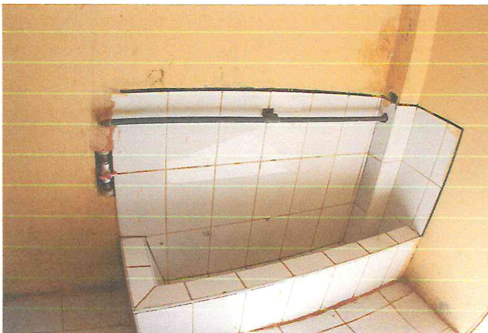
Foto: Estado actual de los servicios higiénicos.
