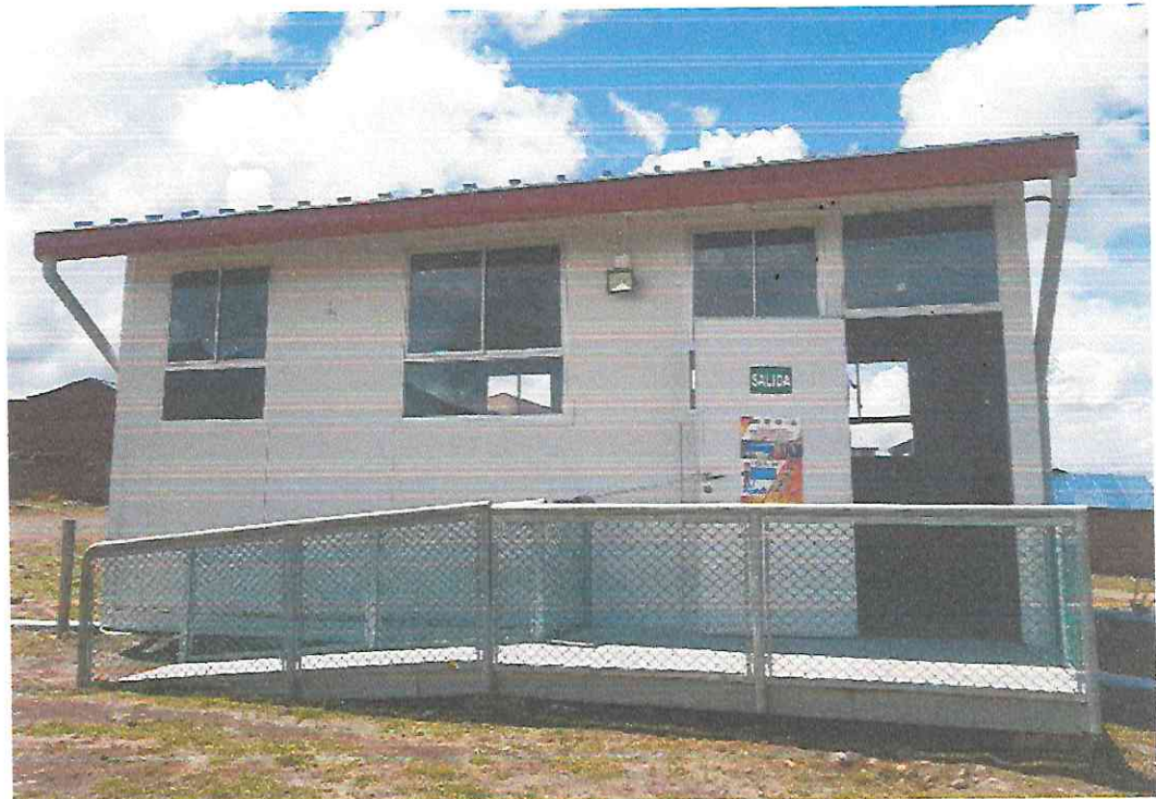
MÓDULO INSTALADO EN CALIDAD DE PRÉSTAMO, NO ES DEL TIPO HELADA.
