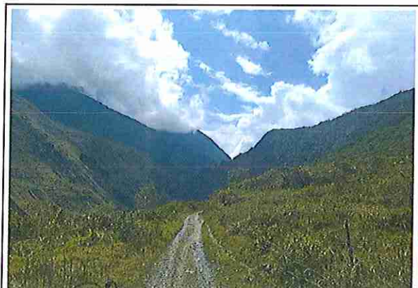
foto 89: KM 22 + 250, Ausencia de material de afirmado, con presencia de deformaciones y erosiones.
