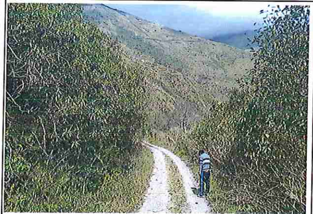
foto 436: KM 21 + 750, Ausencia de material de afirmado, con presencia de deformaciones y erosiones.
