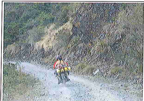
foto 186: KM 09 + 250. Talud margen Der. Ausencia de material de afirmado, con presencia de deformaciones y erosiones.
