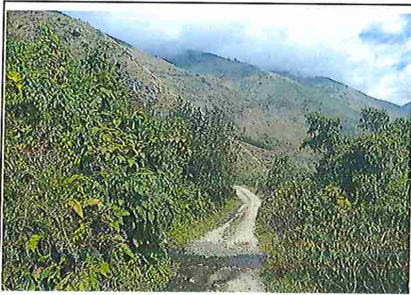
foto 427: KM 21 + 300, Ausencia de material de afirmado, con presencia de deformaciones y erosiones.
