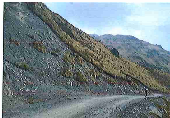
Foto 14: KM 00 + 650, donde se puede observar que tiene la capa de rodadura tiene erosión
