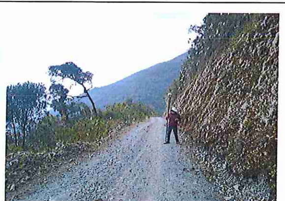
foto 300: KM 14 + 950, talud margen Der. Ausencia de material de afirmado, con presencia de deformaciones y erosione.
