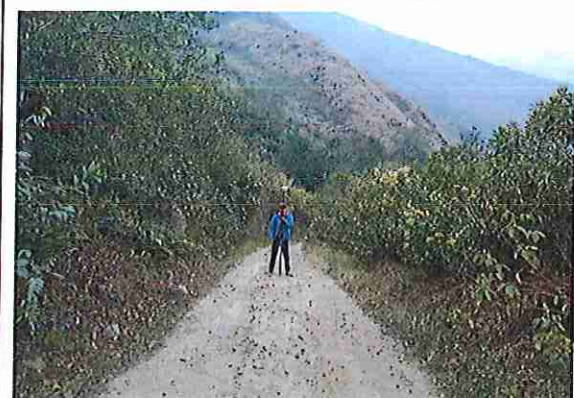
foto 402: KM 20 + 050. Ausencia de material de afirmado, con presencia de deformaciones y ahuellamiento.
