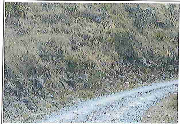
foto 142: KM 07 + 050, Ausencia de material de afirmado, con presencia de deformaciones y erosiones.
