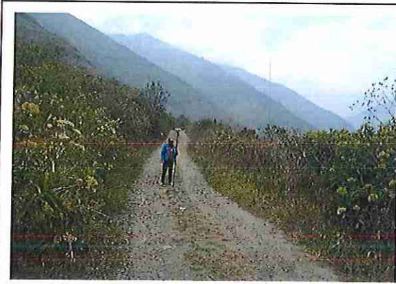
foto 319: KM 15 + 900, Ausencia de material de afirmado, con presencia de deformaciones y erosiones
