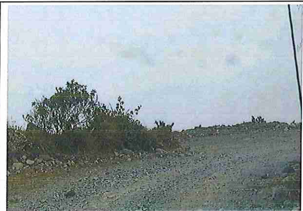
foto 195: KM 09 + 700 Ausencia de material de afirmado, con presencia de deformaciones y erosiones.
