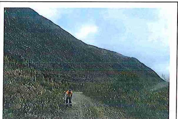
foto 28: KM 01 + 350, Ausencia de material de afirmado, con presencia de deformaciones y erosiones.
