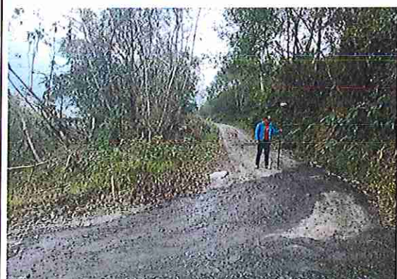
foto 246: KM 12 + 250, donde se puede observar que la capa de rodadura tiene baches y ausencia de material.
