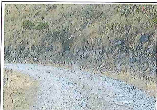
foto 29: KM 07 + 000, Talud margen Der. Ausencia de material de afirmado, con presencia de deformaciones y erosiones.
