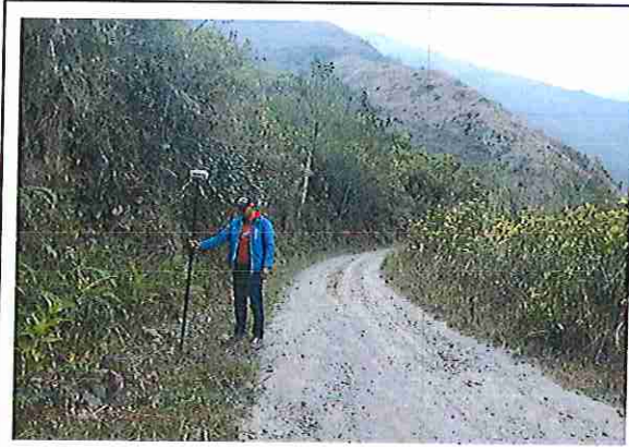
foto 415: KM 20 + 700, Ausencia de material de afirmado, con presencia de deformaciones y erosiones.
