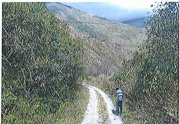
foto 389: KM 19 + 400, Ausencia de material de afirmado, con presencia de deformaciones y erosiones.
