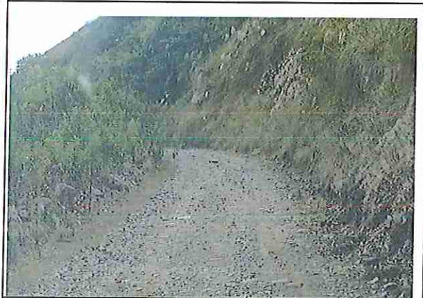
foto 50: KM 12 + 250, talud margen Der. Ausencia de material de afirmado, con presencia de deformaciones y erosione.
