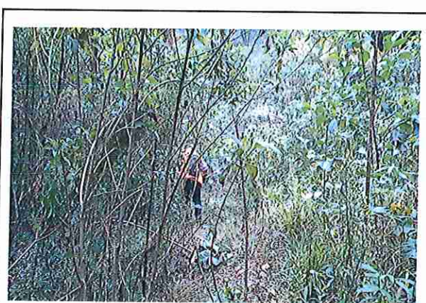
foto 132: KM 06 + 550, Ausencia de material de afirmado, con presencia de deformaciones y erosiones
