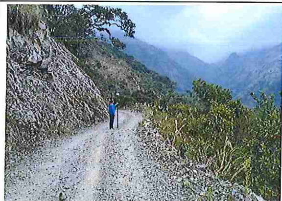
foto 155: KM 07 + 700, Ausencia de material de afirmado, con presencia de deformaciones y erosiones.
