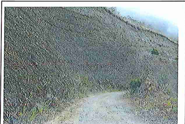
foto 56: KM 02 + 750, Ausencia de material de afirmado, con presencia de deformaciones y erosiones.
