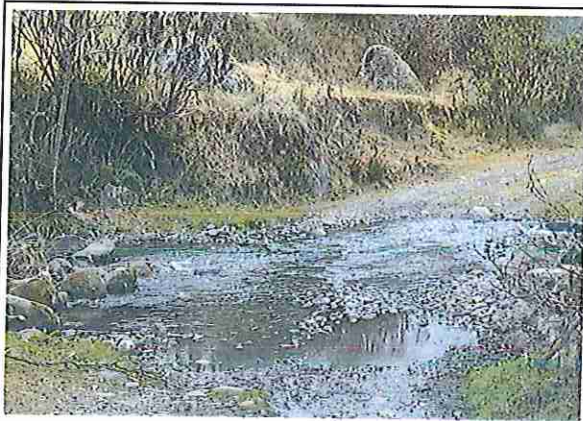
foto 07: KM 01 + 500, Ausencia de material de afirmado, con presencia de deformaciones y erosiones.
