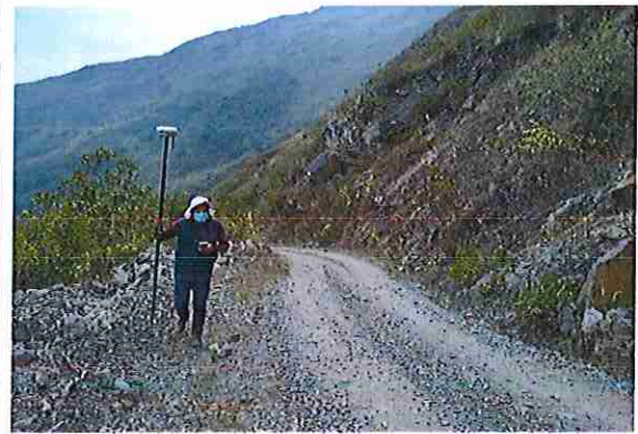
foto 326: KM 16 + 250, Ausencia de material de afirmado, con presencia de deformaciones y erosiones
