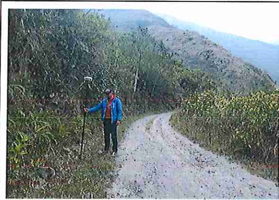
foto 379: KM 18 + 900, Ausencia de material de afirmado, con presencia de deformaciones y erosiones.
