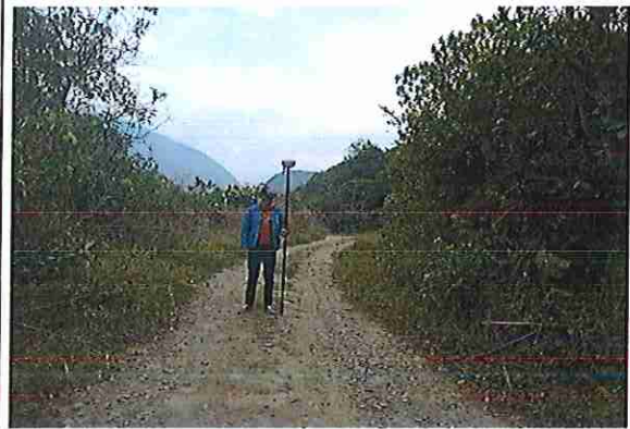
foto 230: KM 11 + 450, donde se puede observar que la capa de rodadura tiene baches y ausencia de material.
