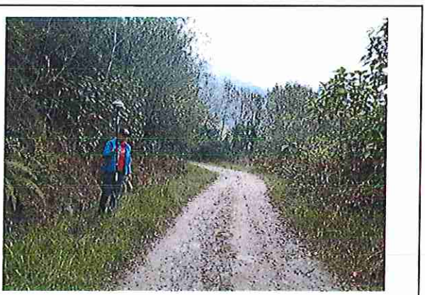
foto 310: KM 15 + 450, Ausencia de material de afirmado, con presencia de deformaciones y erosiones
