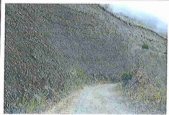
Foto 72: KM 03 + 550, donde se puede observar que tiene la capa de rodadura tiene erosión
