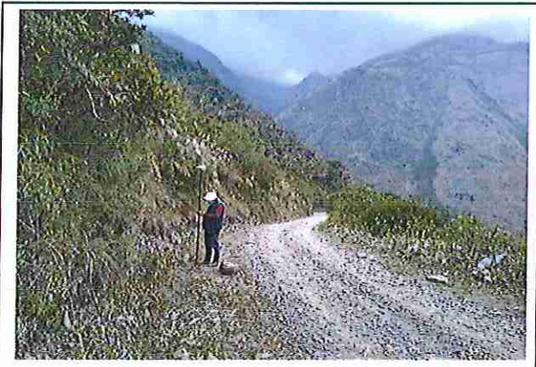
foto 202: KM 10 + 050, Talud margen Der.Ausencia de material de afirmado, con presencia de deformaciones y erosiones.
