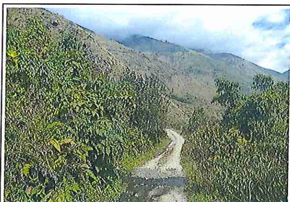
foto 442: KM 22 + 100, Ausencia de material de afirmado, con presencia de deformaciones y erosiones.
