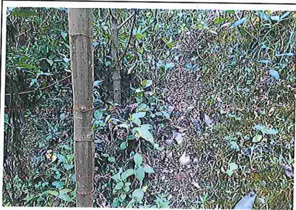
foto 145: KM 07 + 200, Ausencia de material de afirmado, con presencia de deformaciones y erosiones
