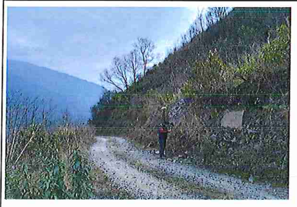
foto 394: KM 19 + 650, Ausencia de material de afirmado, con presencia de deformaciones y ahuellamiento.
