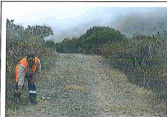
foto 33: KM 01 + 600, Ausencia de material de afirmado, con presencia de deformaciones y erosiones.
