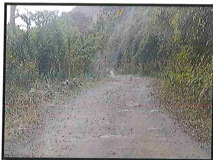
FOTO N° 13 Se puede apreciar el estado de la superficie de rodadura entre el Km 12 + 001- Km 13 + 000
