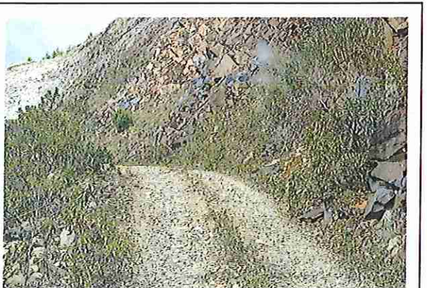
foto 60: KM 02 + 950, Ausencia de material de afirmado, con presencia de deformaciones y erosiones.
