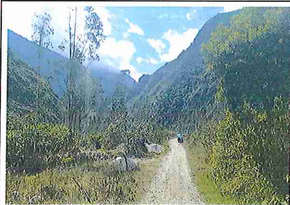
foto 446: KM 22 + 300 ,Ausencia de material de afirmado, con presencia de deformaciones y erosiones.
