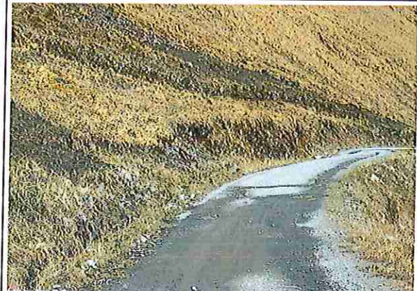
foto 08: KM 00 + 350, donde se puede observar el desgaste de la capa de rodadura y afuencía de agua.
