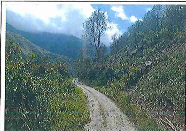
foto 409: KM 20 + 400, Ausencia de material de afirmado, con presencia de deformaciones y erosiones.
