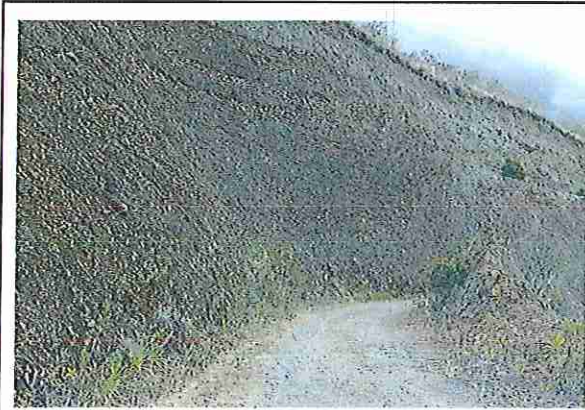
foto 61: KM 03 + 000, Ausencia de material de afirmado, con presencia de deformaciones y erosiones.
