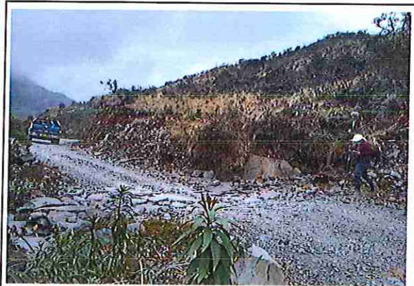
Foto 04: baden KM 04 + 700, se encuentra en regular estado requiere de limpieza.
