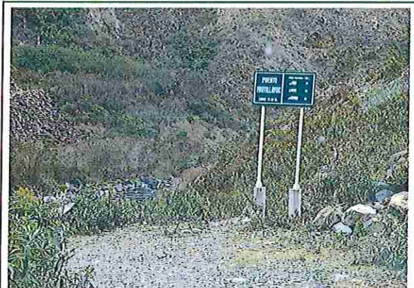
FOTO N°03: SEÑAL INFORMATIVA 06 + 700, estado regular. Falta pintura.
