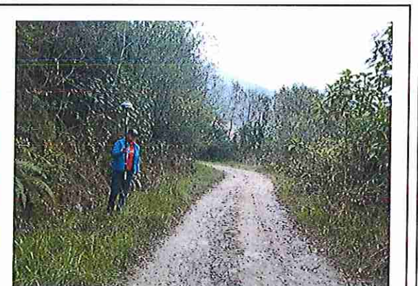
foto 311: KM 15 + 500, Ausencia de material de afirmado, con presencia de deformaciones y erosiones
