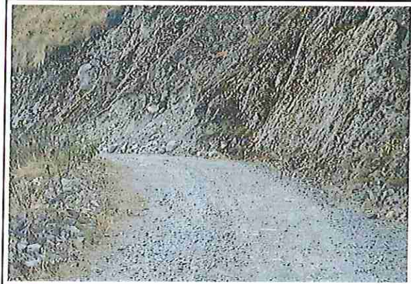
foto 184: KM 09 + 150, Ausencia de material de afirmado, con presencia de deformaciones y erosiones.
