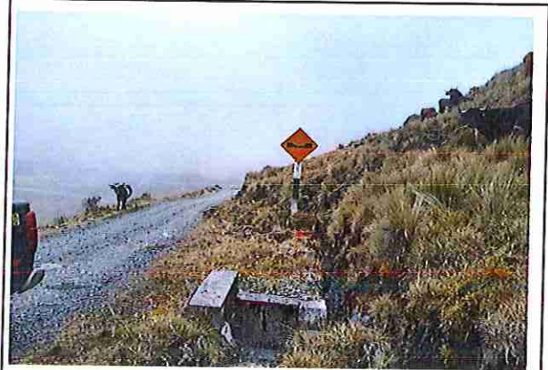
FOTO N° 02: SEÑAL PREVENTIVA KM 06 + 110, estado regular. Falta pintura.
