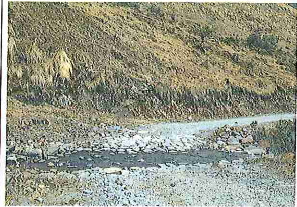
foto 16: KM 03 + 750,Ausencia de material de afirmado, con presencia de deformaciones y erosiones.
