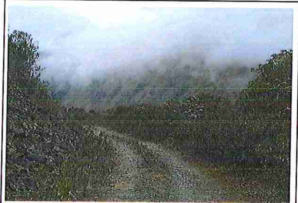
foto 04: KM 00 + 750, Ausencia de material de afirmado, con presencia de deformaciones y erosiones.
