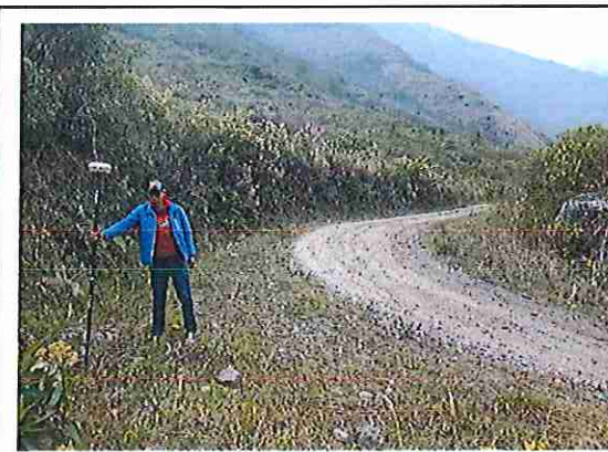
foto 260: KM 12 + 950, donde se puede observar que la capa de rodadura tiene baches y ausencia de material.
