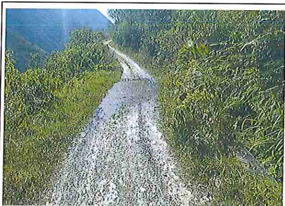
foto 83: KM 20 + 500, Ausencia de material de afirmado, con presencia de deformaciones y erosiones.
