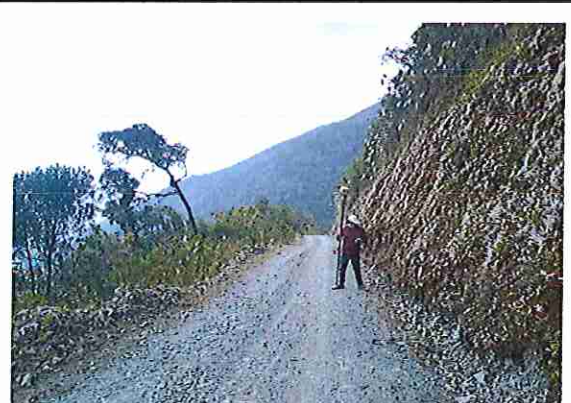
foto 300: KM 14 + 950 Terreno ondulado con un ancho de superficie de 3.97 m.
