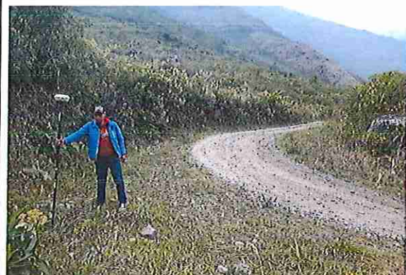
foto 232: KM 11 + 550, donde se puede observar que la capa de rodadura tiene baches y ausencia de material.
