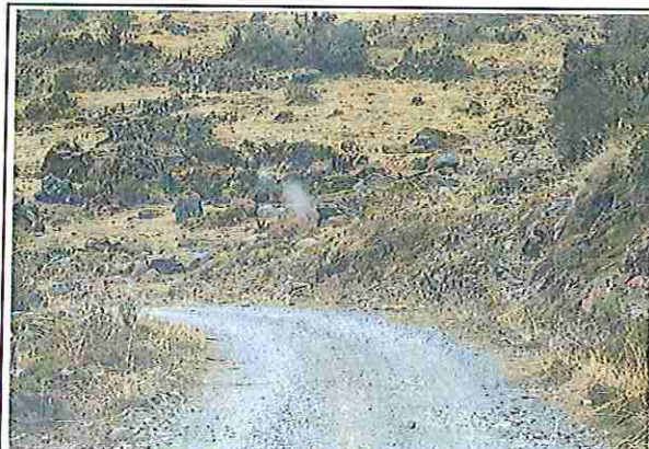
foto 34: KM 08 + 250, Ausencia de material de afirmado, con presencia de deformaciones y erosiones.
