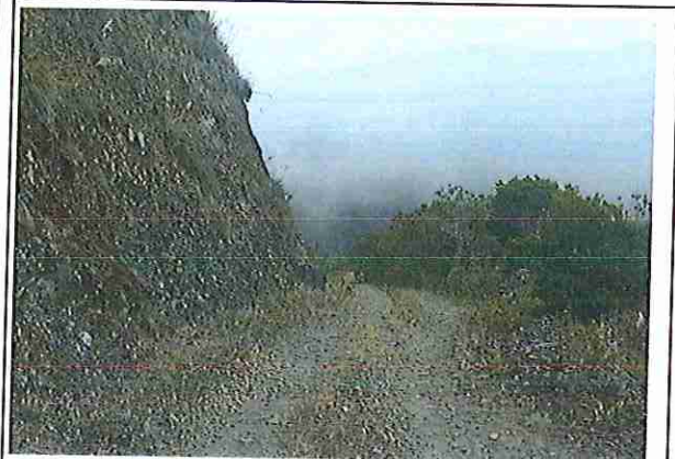
foto 14: KM 03 + 250, Ausencia de material de afirmado, con presencia de deformaciones y erosiones.
