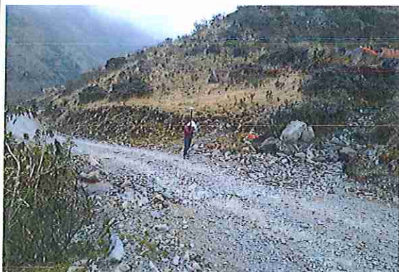
foto 23: KM 01 + 100, donde se puede observar que tiene la capa de rodadura tiene erosión.
