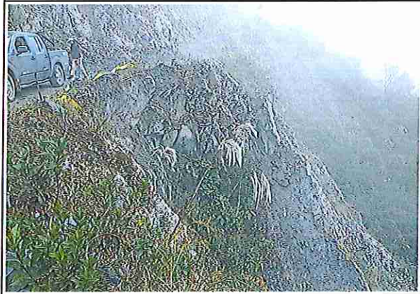
foto 01: KM 18 + 500, derrumbe de plataforma
