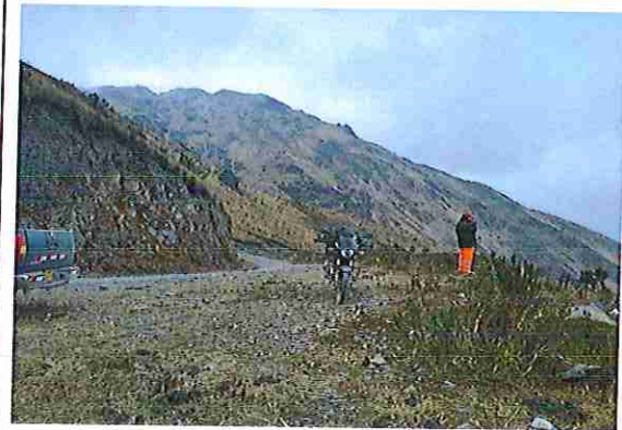
foto 70: KM 03 + 450, Ausencia de material de afirmado, con presencia de deformaciones y erosiones.
