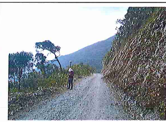
foto 274: KM 13 + 650, donde se puede observar que el camino vecinal esta encalaminado
