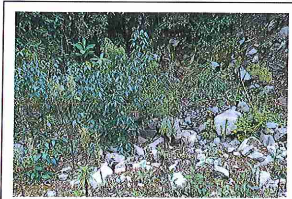
foto 116: KM 05 + 750, Ausencia de material de afirmado, con presencia de deformaciones y erosiones
