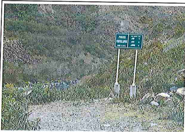
foto 15: KM 03 + 500, donde se puede observar que tiene la capa de rodadura tiene erosión
