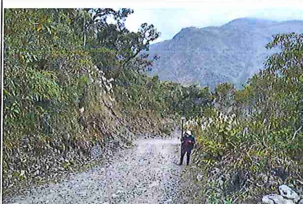
foto 227: KM 11 + 300, Ausencia de material de afirmado, con presencia de deformaciones y erosiones
