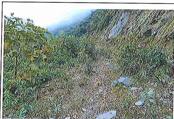
foto 131: KM 06 + 500, Ausencia de material de afirmado, con presencia de deformaciones y erosiones
