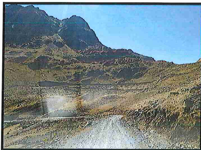
FOTO N° 01 Se puede apreciar el estado de la superficie de rodadura entre el Km 00+000 - Km 01 +000
