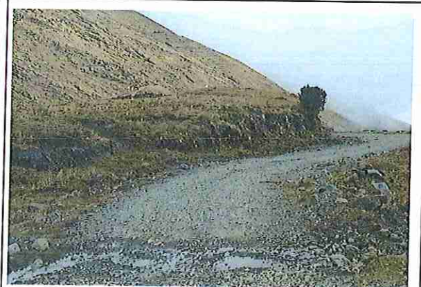
foto 78: KM 03 + 850, Ausencia de material de afirmado, con presencia de deformaciones y erosiones.
