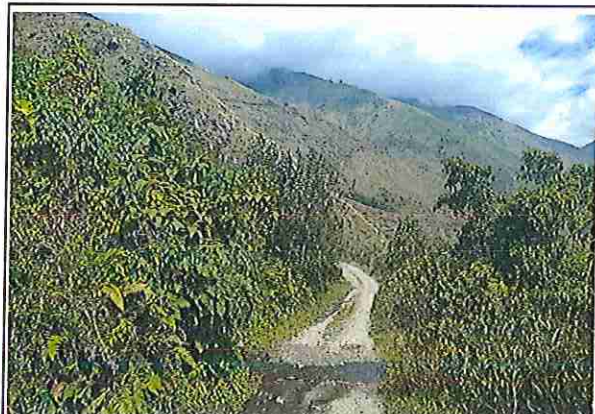
foto 440: KM 21 + 950, Ausencia de material de afirmado, con presencia de deformaciones y erosiones.
