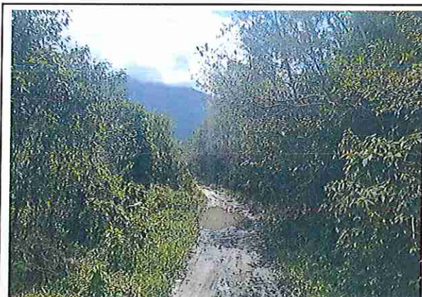
foto 401: KM 20 + 000, Ausencia de material de afirmado y erosiones por falta de badén.
