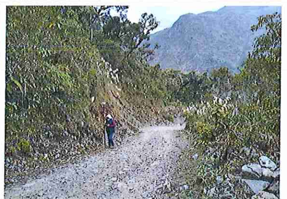
foto 228: KM 11 + 350, Talud margen Der. Ausencia de material de afirmado, con presencia de deformaciones y erosiones
