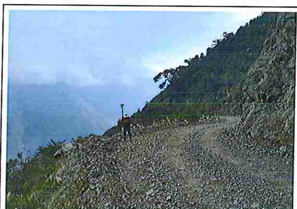
foto 154: KM 07 + 650, Ausencia de material de afirmado, con presencia de deformaciones y erosiones.
