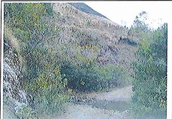
foto 06: KM 01 + 250, Ausencia de material de afirmado, con presencia de deformaciones y erosiones.
