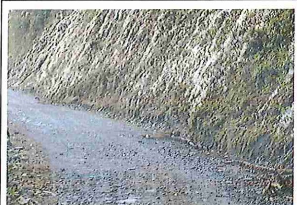
Foto 194: KM 09 + 650, Talud margen Der. Ausencia de material de afirmado, con presencia de deformaciones y erosiones.
