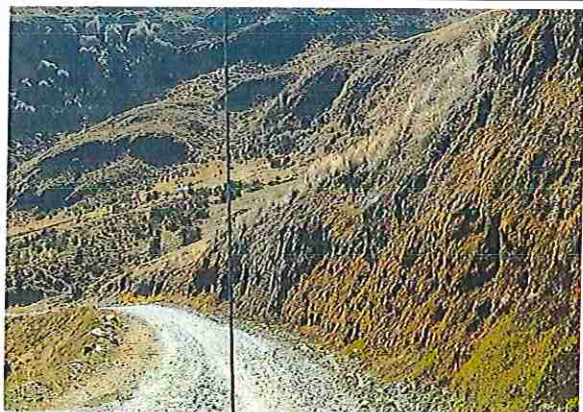
foto 45: KM 02 + 200, donde se puede observar que tiene la capa de rodadura tiene erosión
