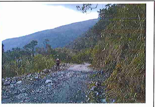
Foto 198: KM 09 + 850, Talud margen Der. Ausencia de material de afirmado, con presencia de deformaciones y erosiones.
