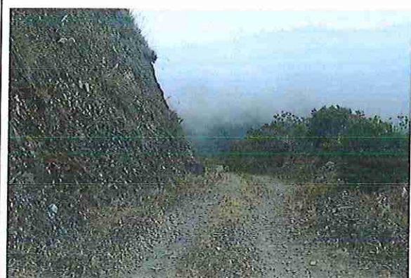
foto 34: KM 0 + 650, Ausencia de material de afirmado, con presencia de deformaciones y erosiones.
