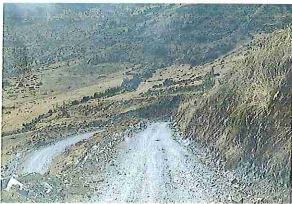
foto 15: KM 03 + 500,Ausencia de material de afirmado, con presencia de deformaciones y erosiones.
