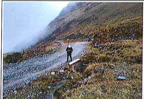
foto 02: Alcantarilla KM 00+610, se encuentra en regular estado requiere de limpieza.
