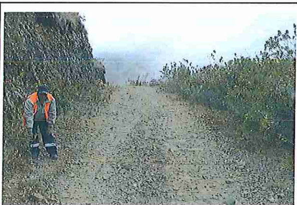
foto 011: KM 00 + 500, Ausencia de material de afirmado, con presencia de deformaciones y erosiones.
