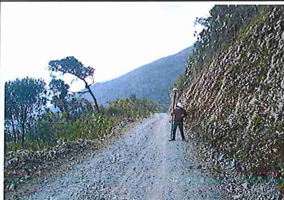
foto 302: KM 15+ 050 Terreno ondulado con un ancho de superficie de 3.96 m.
