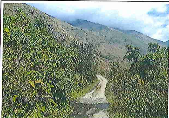
foto 423: KM 21 + 100, Ausencia de material de afirmado, con presencia de deformaciones y erosiones.
