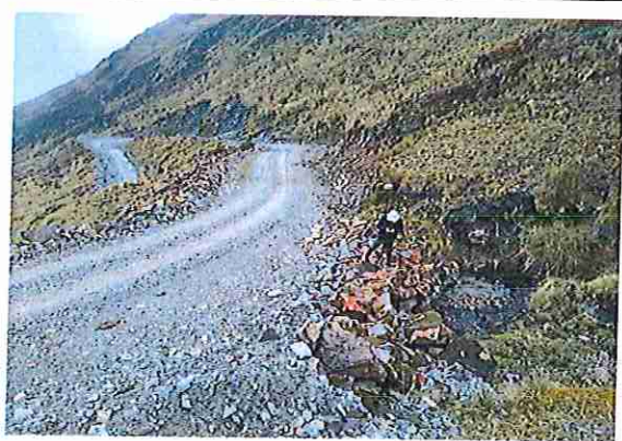
foto 87: KM 04 + 300, Ausencia de material de afirmado, con presencia de deformaciones y erosiones.
