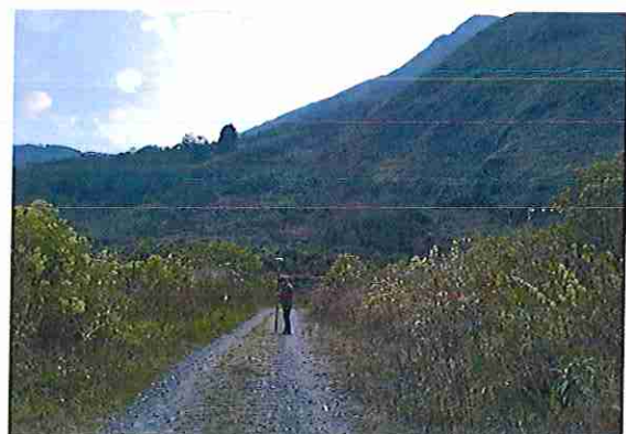
foto 347: KM 17 + 300, Ausencia de material de afirmado, con presencia de deformaciones y ahuellamiento.
