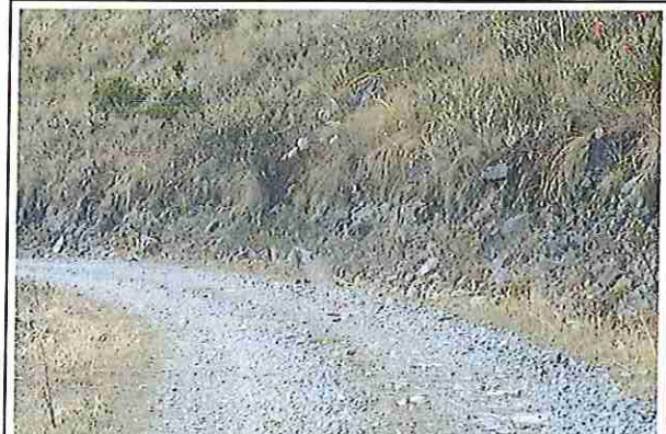
foto 108: KM 05 + 350, Talud margen der. Ausencia de material de afirmado, con presencia de deformaciones y erosiones.
