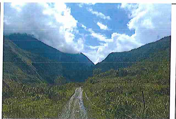
foto 432: KM 21 + 550, Ausencia de material de afirmado, con presencia de deformaciones y erosiones.
