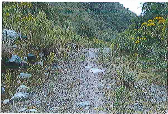
foto 111: KM 05 + 500, donde se puede observar que tiene la capa de rodadura tiene erosión
