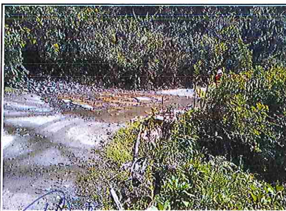
foto 06: KM 01 + 820, baden se encuentra en estado regular.
