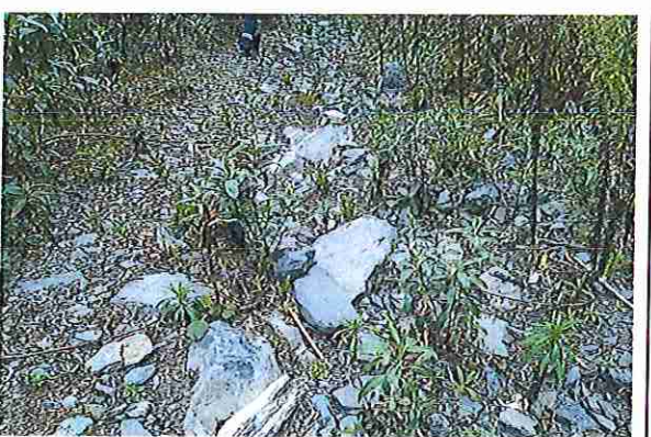
foto 119: KM 05 + 900, Ausencia de material de afirmado, con presencia de deformaciones y erosiones
