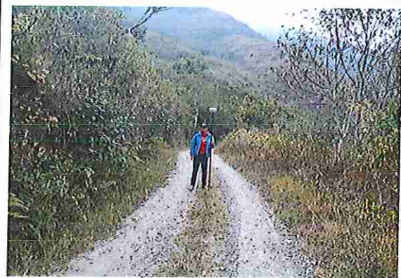
foto 238: KM 11 + 850, donde se puede observar que la capa de rodadura tiene baches y ausencia de material.
