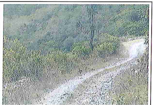
foto 309: KM 15 + 400, Ausencia de material de afirmado, con presencia de deformaciones y erosiones
