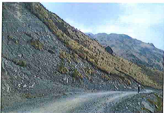
foto 11: KM 00 + 500, donde se puede observar que tiene la capa de rodadura tiene erosión
