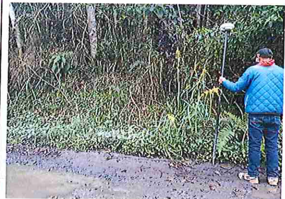
foto 316: KM 15 + 750, Ausencia de material de afirmado, con presencia de deformaciones y erosiones
