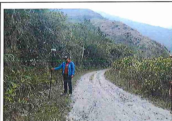
foto 339: KM 16 + 900, Ausencia de material de afirmado, con presencia de deformaciones y erosiones.
