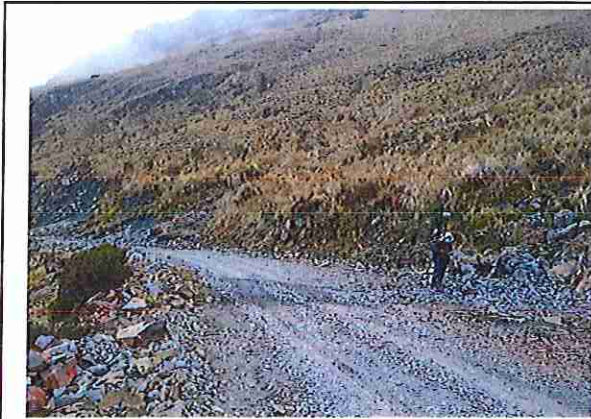
foto 01: Tajea , KM 00 + 320, estado regular.
