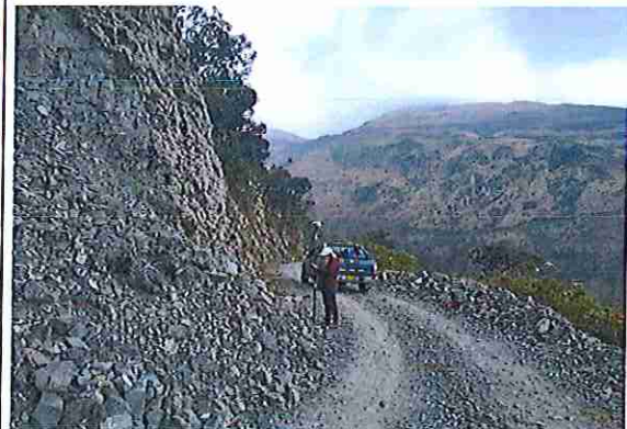
foto 192: KM 09 + 550. Talud margen Izq. Ausencia de material de afirmado, con presencia de deformaciones y erosiones.
