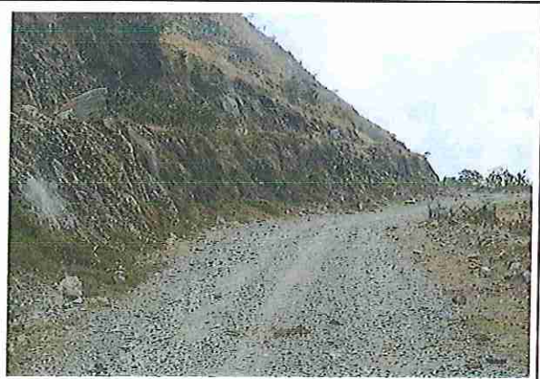
foto 105: KM 05 + 200, Talud margen izq. Ausencia de material de afirmado, con presencia de deformaciones y erosiones.
