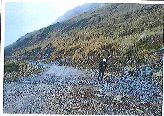
foto 68: KM 03 + 350, Ausencia de material de afirmado, con presencia de deformaciones y erosiones.
