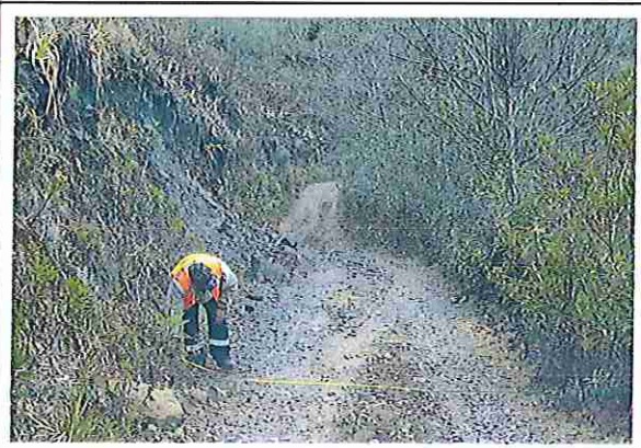
foto 08: KM 00 + 0350, Ausencia de material de afirmado, con presencia de deformaciones y erosiones.
