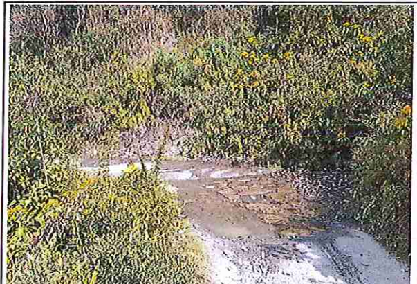
foto 22: badén KM 18 + 700 en regular estado pero está semi obstruida.
