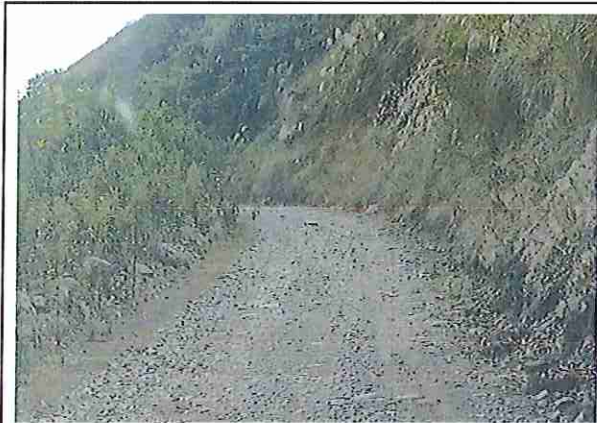
foto 229: KM 11 + 400, donde se puede observar que la capa de rodadura tiene baches y ausencia de material.
