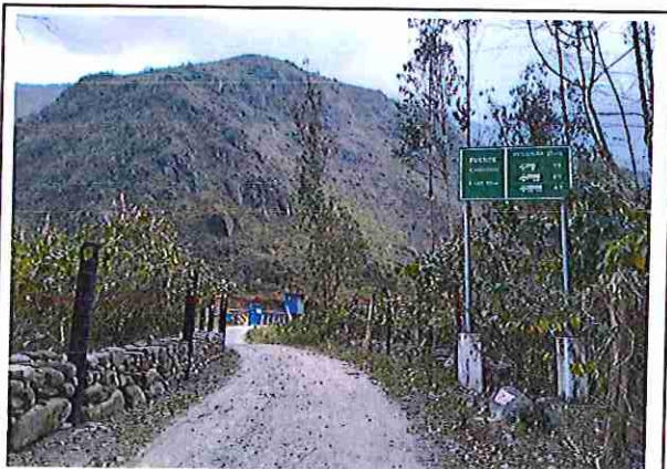
FOTO N° 05: SEÑAL INFORMATIVA KM 22 + 894, estado regular. Falta pintura
