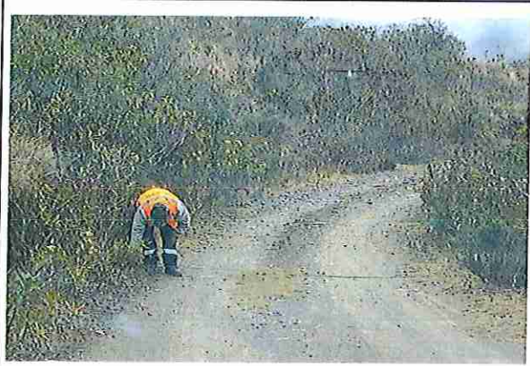
foto 13: KM 00 + 600, Ausencia de material de afirmado, con presencia de deformaciones y erosiones.
