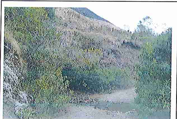
foto 14: KM 00 + 650, Ausencia de material de afirmado, con presencia de deformaciones y erosiones.
