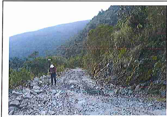
Foto 200: KM 09 + 950, Talud margen Der.Ausencia de material de afirmado, con presencia de deformaciones y erosiones.
