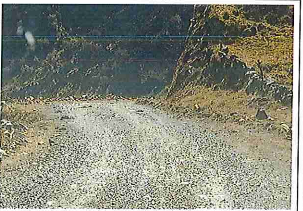
foto 41: KM 02 + 000, donde se puede observar que tiene la capa de rodadura tiene erosión
