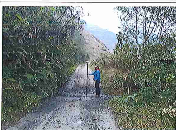
foto 414: KM 20 + 650, Ausencia de material de afirmado, con presencia de deformaciones y erosiones.
