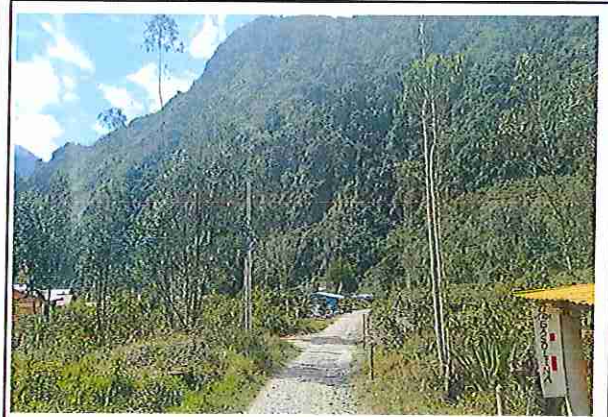
foto 451: KM 22 + 550 ,Ausencia de material de afirmado, con presencia de deformaciones y erosiones.
