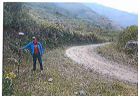
foto 240: KM 11 + 950, donde se puede observar que la capa de rodadura tiene baches y ausencia de material.
