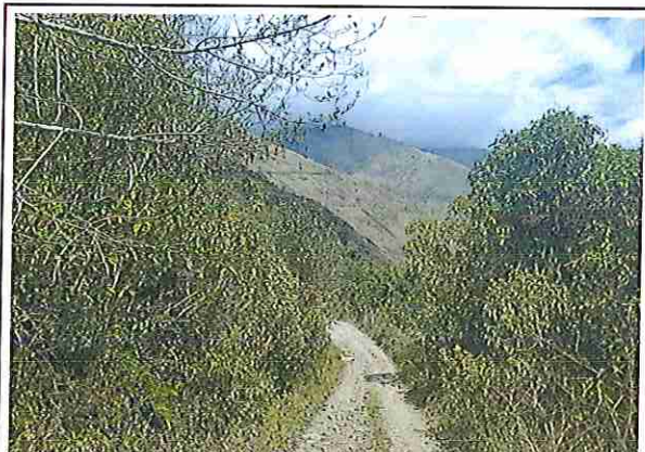
foto 75: KM 18 + 500, Ausencia de material de afirmado, con presencia de deformaciones y erosiones.
