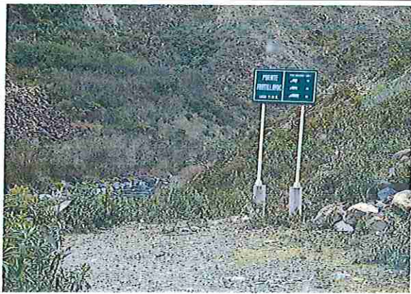
foto 81: KM 04 + 000, donde se puede observar que tiene la capa de rodadura tiene erosión
