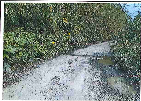
foto 13: baden KM 05 + 910 en regular estado.
