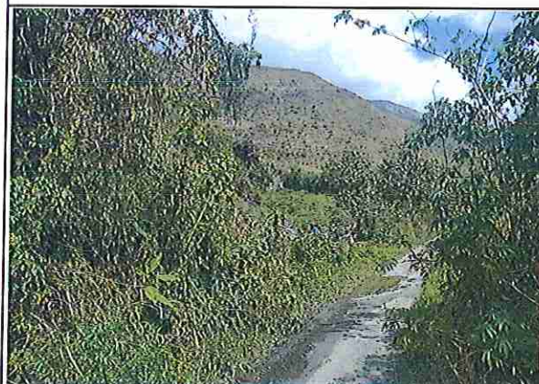
foto 426: KM 21 + 250, Ausencia de material de afirmado, con presencia de deformaciones y erosiones.
