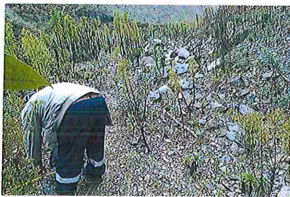
foto 123: KM 06 + 100, Ausencia de material de afirmado, con presencia de deformaciones y erosiones
