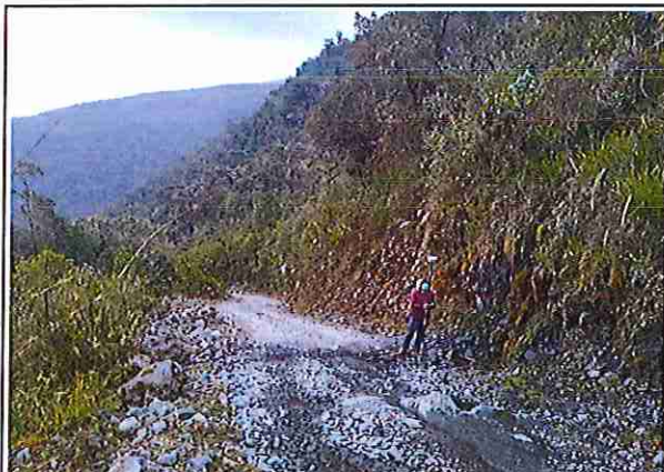
foto 05: KM 0 1+ 620 tajea se encuentra en regular estado requiere de limpieza.
