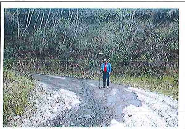
Foto 196: KM 09 + 750, Ausencia de material de afirmado, con presencia de deformaciones y erosiones.
