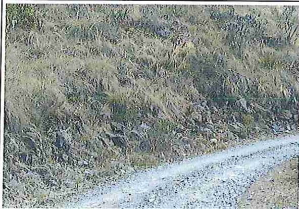
foto 159: KM 07 + 900, Ausencia de material de afirmado, con presencia de deformaciones y erosiones.
