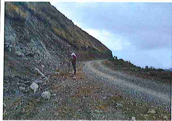
foto 28: KM 01 + 350, donde se puede observar que tiene la capa de rodadura tiene erosión.
