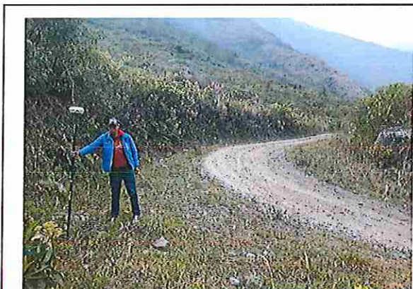
foto 259: KM 12 + 900, donde se puede observar que la capa de rodadura tiene baches y ausencia de material.
