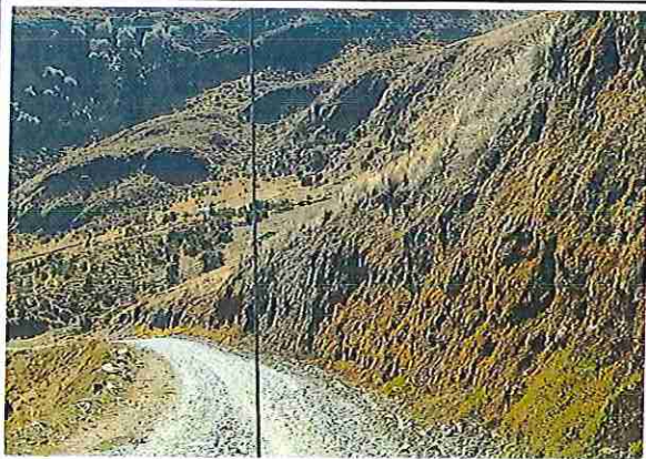
foto 51: KM 02 + 500, Ausencia de material de afirmado, con presencia de deformaciones y erosiones.
