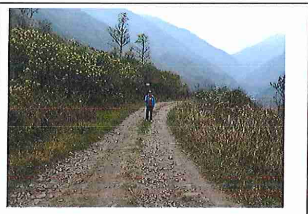
foto 308: KM 15 + 350, Ausencia de material de afirmado, con presencia de deformaciones y erosiones
