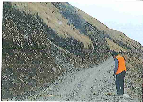
foto 93: KM 04 + 600, Ausencia de material de afirmado, con presencia de deformaciones y erosiones.
