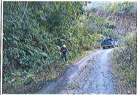
foto 398: KM 19 + 850, Ausencia de material de afirmado, con presencia de deformaciones y ahuellamiento.
