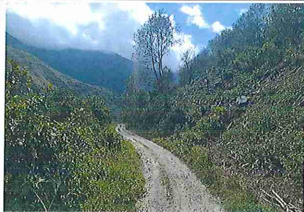
foto 393: KM 19 + 600, Ausencia de material de afirmado, con presencia de deformaciones y ahuellamiento.
