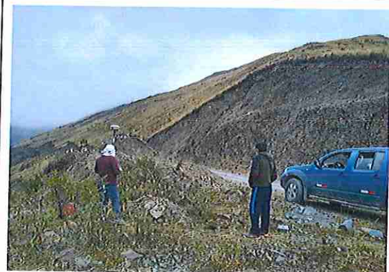
foto 72: KM 03 + 550, Ausencia de material de afirmado, con presencia de deformaciones y erosiones.
