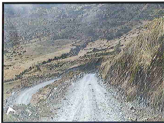
FOTO N° 04 Se puede apreciar el estado de la superficie de rodadura entre el Km 3 + 001- Km 4 + 000
