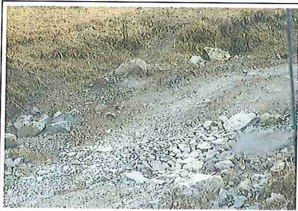
foto 25: KM 06 + 000, baden de piedra donde se puede observar que la capa de rodadura presenta ahuellamiento
