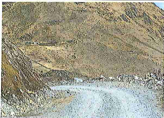
foto 29: KM 01 + 400, donde se puede observar que tiene la capa de rodadura tiene erosión.
