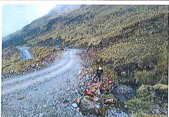
foto 35: KM 01 + 700, donde se puede observar que tiene la capa de rodadura tiene erosión
