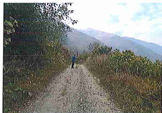
foto 252: KM 12 + 550, Ausencia de material de afirmado, con presencia de deformaciones y ahuellamiento.
