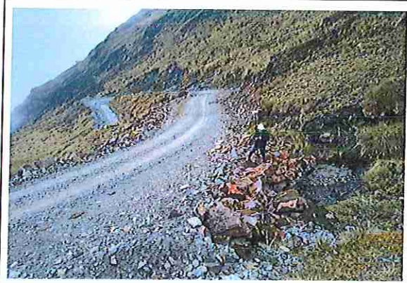
foto 100: KM 04 + 950, Ausencia de material de afirmado, con presencia de deformaciones y erosiones.
