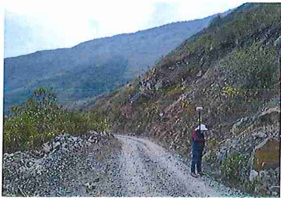
foto 219: KM 10 + 900, donde se puede observar que la capa de rodadura tiene baches y ausencia de material.
