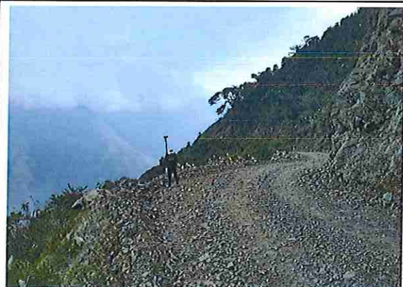
foto 162: KM 08 + 050, Ausencia de material de afirmado, con presencia de deformaciones y erosiones.
