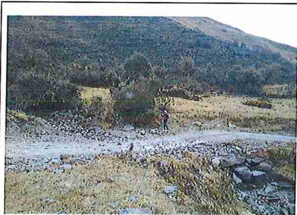
foto 123: KM 06 + 100, baden de piedra donde se puede observar que la capa de rodadura presenta ahuellamiento
