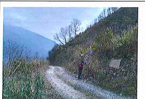
foto 396: KM 19 + 750, Ausencia de material de afirmado, con presencia de deformaciones y ahuellamiento.
