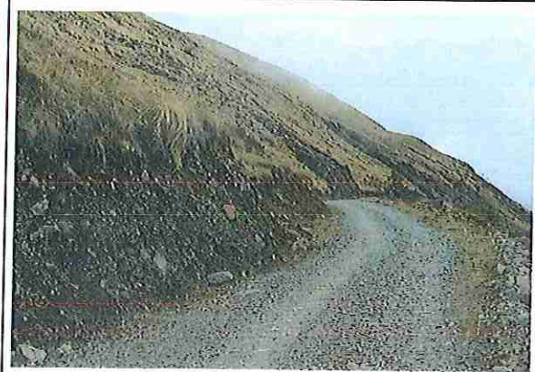
foto 98: KM 04 + 850, Ausencia de material de afirmado, con presencia de deformaciones y erosiones.
