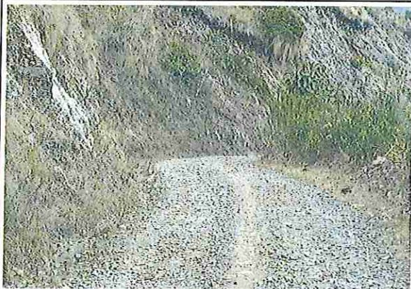
foto 47: KM 11 + 500, Ausencia de material de afirmado, con presencia de deformaciones y erosione
