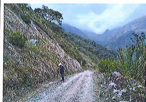
foto 210: KM 10 + 450, donde se puede observar que la capa de rodadura tiene baches y ausencia de material.
