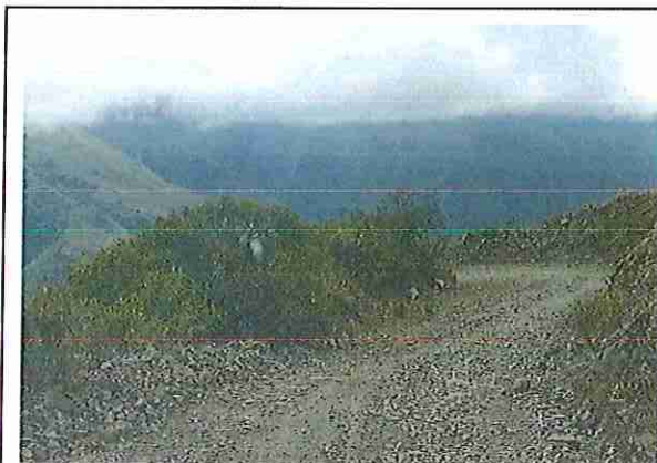
foto 56: KM 13 + 750, donde se puede observar que la capa de rodadura tiene baches y ausencia de material.
