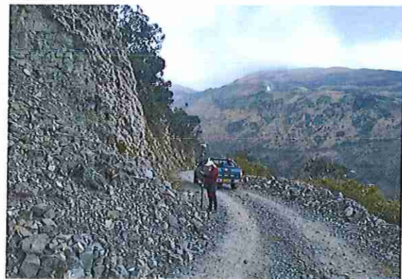
foto 143: KM 07 + 100, Talud margen Izq. Ausencia de material de afirmado, con presencia de deformaciones y erosiones.
