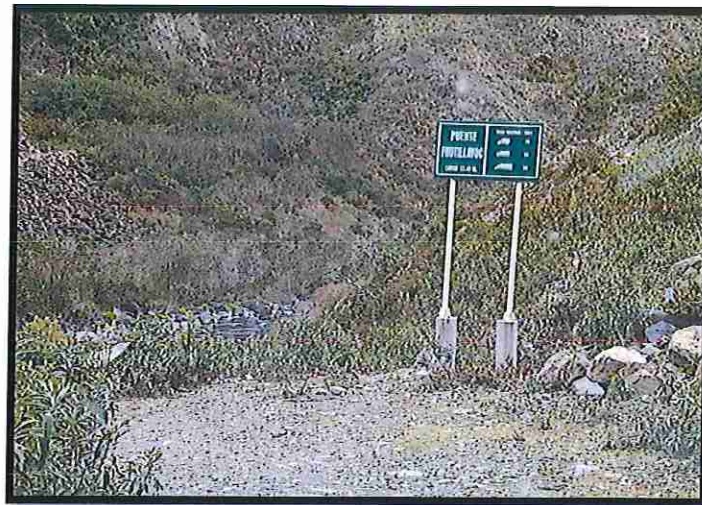
FOTO N° 05 Se puede apreciar el estado de la superficie de rodadura entre el Km 4 + 001- Km 5 + 000
