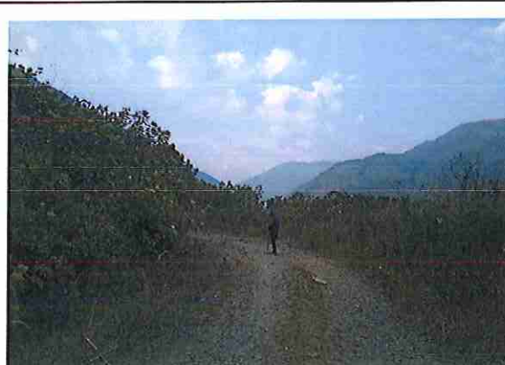
foto 342: KM 17 + 050, Ausencia de material de afirmado, con presencia de deformaciones y ahuellamiento.
