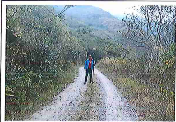
foto 391: KM 19 + 500, Ausencia de material de afirmado, con presencia de deformaciones y erosiones.
