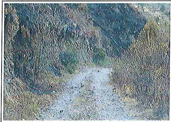
foto 02: KM 00 + 250, Ausencia de material de afirmado, con presencia de deformaciones y erosiones.
