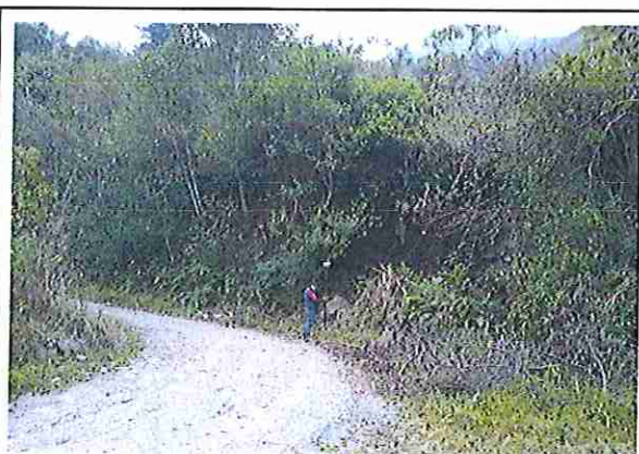
foto 72: KM 17 + 750, Ausencia de material de afirmado, con presencia de deformaciones y ahuellamiento.
