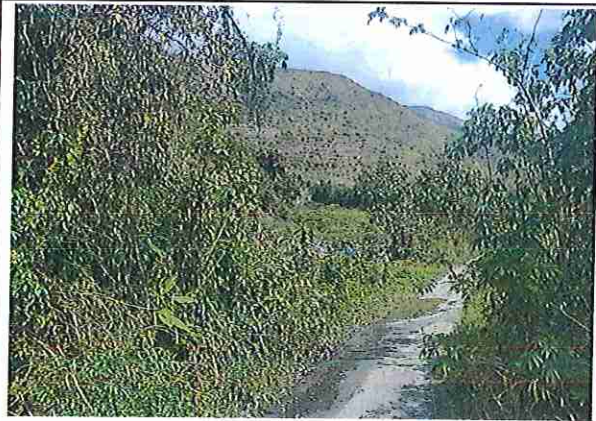
foto 433: KM 21 + 600, Ausencia de material de afirmado, con presencia de deformaciones y erosiones.
