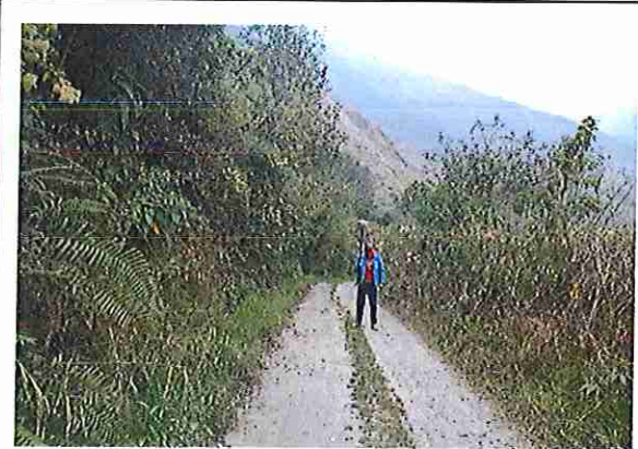
foto 318: KM 15 + 850, Ausencia de material de afirmado, con presencia de deformaciones y erosione
