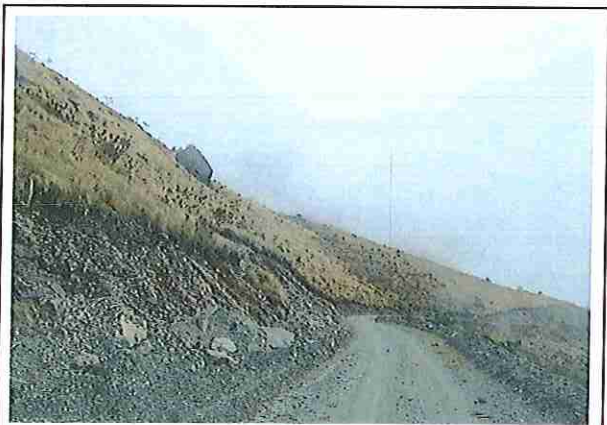
foto 137: KM 06 + 800, Talud margen lzd. Ausencia de material de afirmado, con presencia de deformaciones y erosiones.
