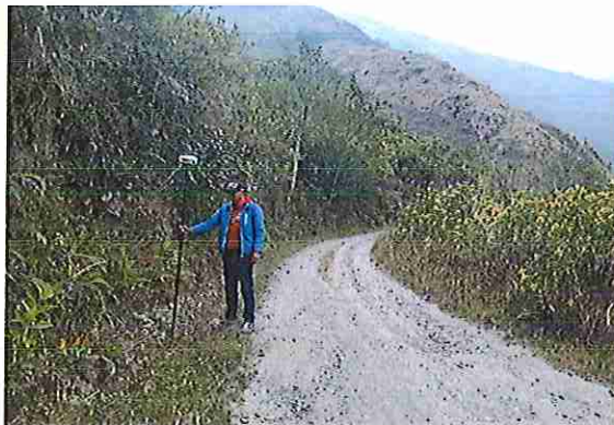
foto 255: KM 12 + 700, Ausencia de material de afirmado, con presencia de deformaciones .
