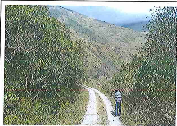
foto 79: KM 19 + 500, Ausencia de material de afirmado, con presencia de deformaciones y erosiones.
