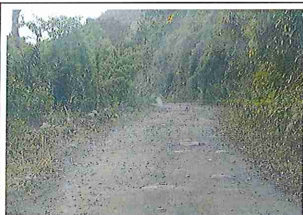
foto 261: KM 13 + 000, donde se puede observar que la capa de rodadura tiene baches y ausencia de material.
