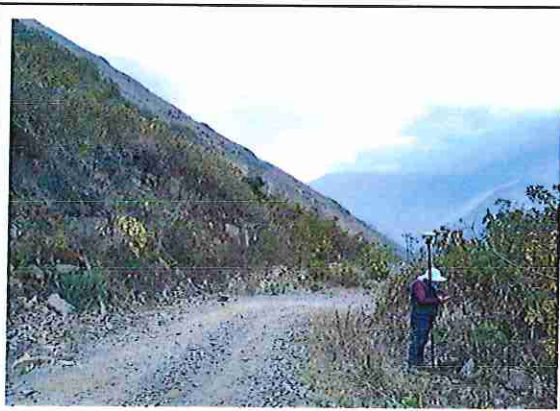
foto 334: KM 16 + 650, Ausencia de material de afirmado, con presencia de deformaciones y ahuellamiento.
