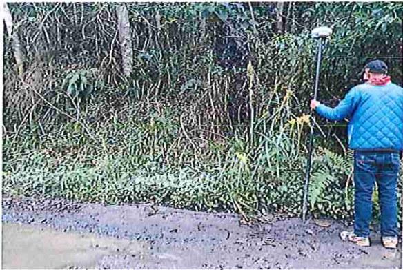
foto 387: KM 19 + 300, Ausencia de material de afirmado, con presencia de deformaciones y erosiones.
