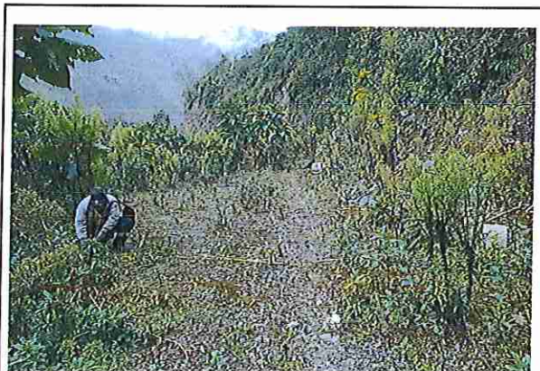
foto 126: KM 06 + 250, Ausencia de material de afirmado, con presencia de deformaciones y erosiones
