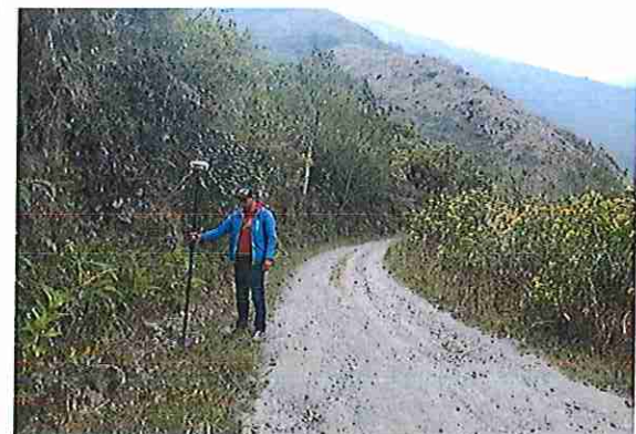
foto 224: KM 11 + 150, donde se puede observar que la capa de rodadura tiene baches y ausencia de material.
