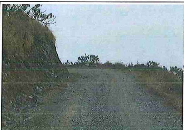
foto 165: KM 08 + 200, Ausencia de material de afirmado, con presencia de deformaciones y erosiones.
