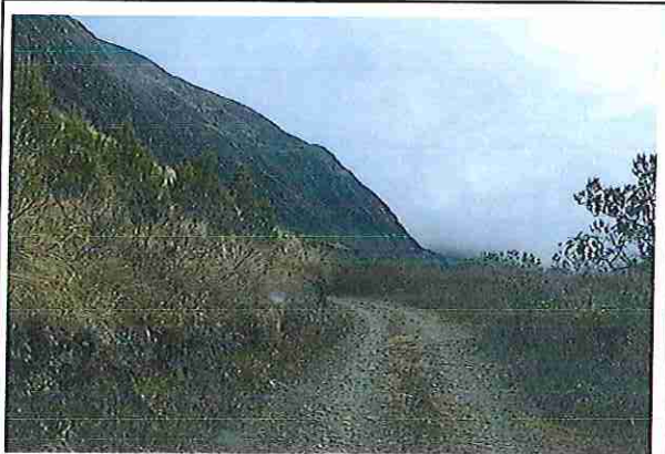
foto 15: KM 00 + 700, Ausencia de material de afirmado, con presencia de deformaciones y erosiones.
