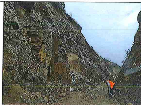
Tramo Pumachaca - Mapuraya Foto n° 2: FALLA GEOLOGICA, zona de deslizamiento de la vía, derrumbe de talud, 05+550.
