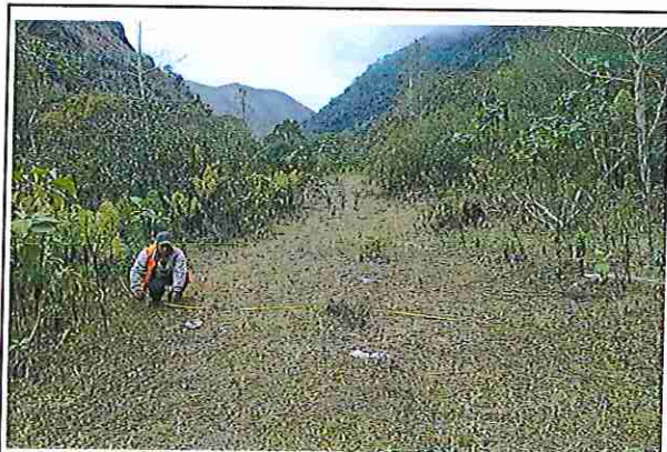
foto 135: KM 06 + 700, Ausencia de material de afirmado, con presencia de deformaciones y erosiones
