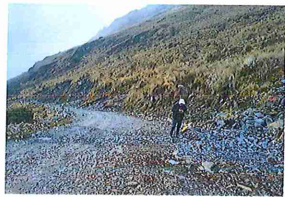
foto 50: KM 02 + 450, Ausencia de material de afirmado, con presencia de deformaciones y erosiones.
