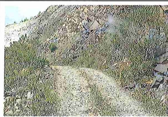
foto 63: KM 03 + 100, Ausencia de material de afirmado, con presencia de deformaciones y erosiones.
