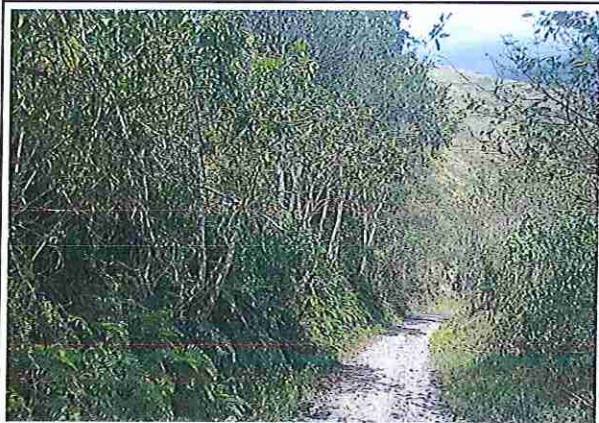
foto 397: KM 19 + 800, Ausencia de material de afirmado, con presencia de deformaciones y ahuellamiento.
