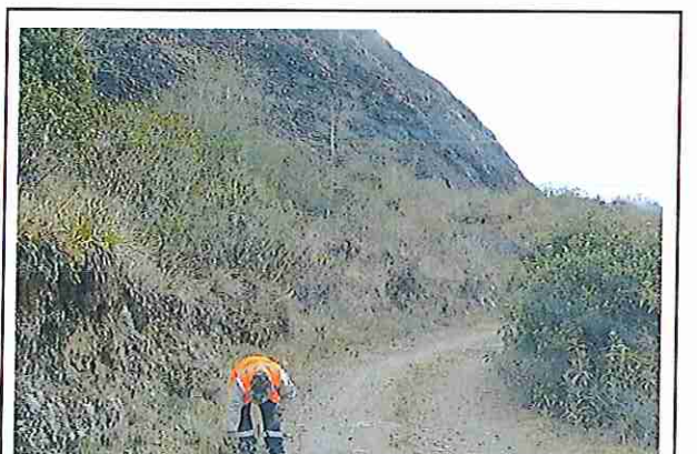
foto 18: KM 00 + 850, Ausencia de material de afirmado, con presencia de deformaciones y erosiones.
