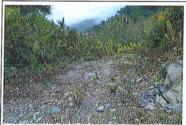
foto 118: KM 05 + 850, Ausencia de material de afirmado, con presencia de deformaciones y erosiones
