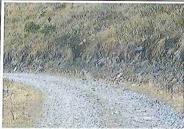
foto 141: KM 07 + 000, Ausencia de material de afirmado, con presencia de deformaciones y erosiones.
