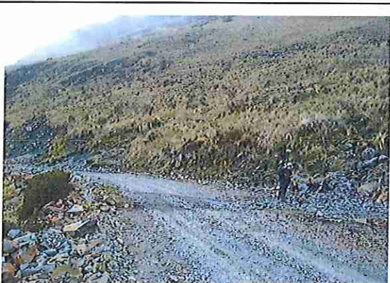
foto 47: KM 02 + 300, donde se puede observar que tiene la capa de rodadura tiene erosión
