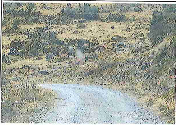
foto 99: KM 04 + 900, Ausencia de material de afirmado, con presencia de deformaciones y erosiones.
