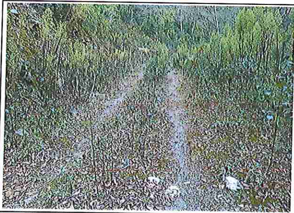
foto 19: KM 04 + 500, donde se puede observar que tiene la capa de rodadura tiene erosión
