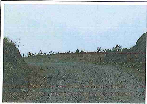
foto 133: KM 06 + 600, Talud margen lzd. Ausencia de material de afirmado, con presencia de deformaciones y erosiones.
