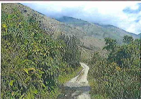
foto 377: KM 18 + 800, Ausencia de material de afirmado, erosiones por falta de baden.
