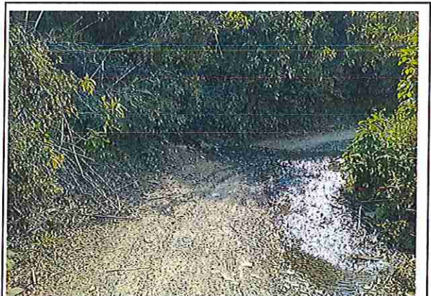
foto 06: baden KM 05 + 350, se encuentra en mal estado y se encuentra regularmente saturado.
