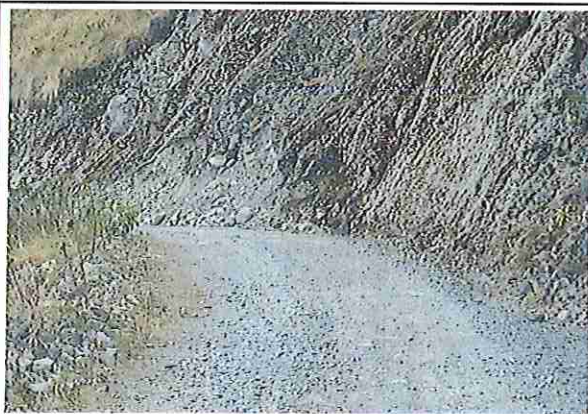
foto 185: KM 09 + 200, Talud margen Der. Ausencia de material de afirmado, con presencia de deformaciones y erosiones.
