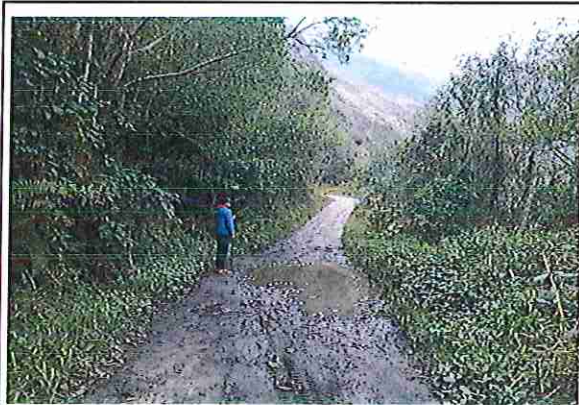
foto 411: KM 20 + 500, Ausencia de material de afirmado, con presencia de deformaciones y erosiones.
