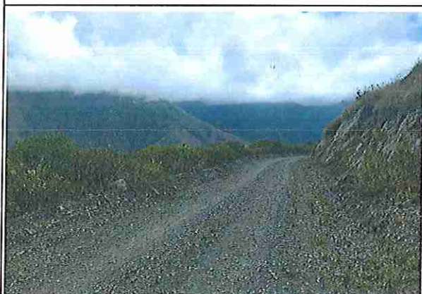
foto 59: KM 14 + 500, donde se puede observar que la capa de rodadura tiene baches y ausencia de material.
