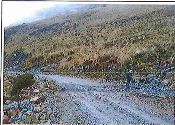
foto 07: KM 01 + 500, donde se puede observar que tiene la capa de rodadura tiene erosión.
