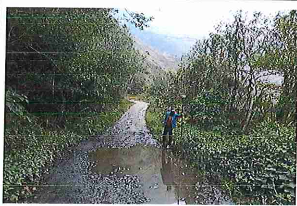
foto 315: KM 15 + 700, Ausencia de material de afirmado, con presencia de deformaciones y erosiones
