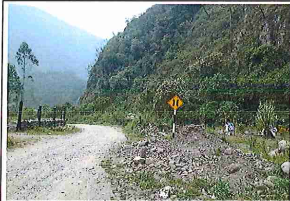
FOTO N°03: SEÑAL PREVENTIVA KM 11 + 610, estado regular. Falta pintura
