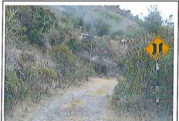
FOTO N°02: SEÑAL PREVENTIVA KM 4+400, estado regular. Falta pintura
