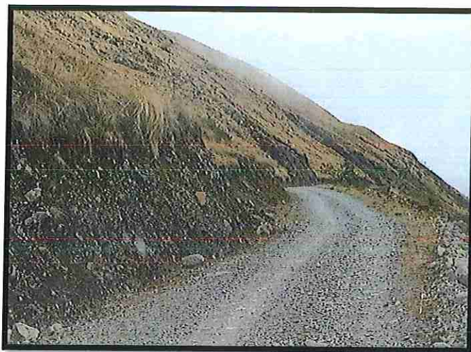
FOTO N° 05 Se puede apreciar el estado de la superficie de rodadura entre el Km 4 + 001- Km 5 + 000
