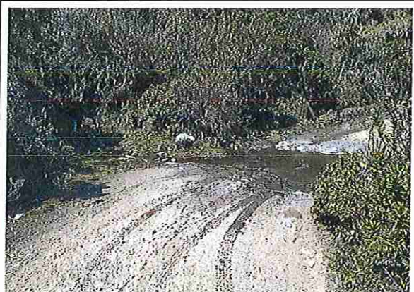
foto 12: baden KM 05+310, baden se encuentra en buen estado, pero requiere de limpieza
