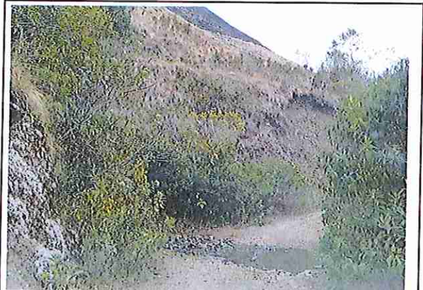
foto 06: KM 01 + 250, Ausencia de material de afirmado, con presencia de deformaciones y erosiones.
