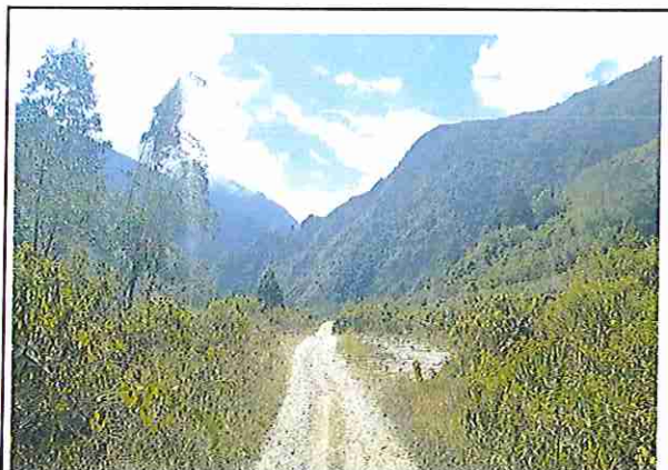
foto 443: KM 22 + 150, Ausencia de material de afirmado, con presencia de deformaciones y erosiones.
