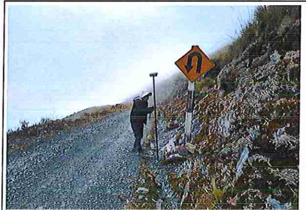
FOTO N°04: SEÑAL PREVENTIVA KM 17 + 110, se encuentra en mal estado.
