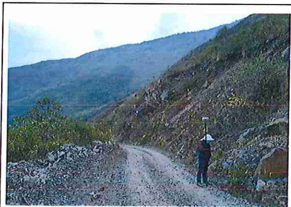
foto 332: KM 16 + 550, Ausencia de material de afirmado, con presencia de deformaciones y ahuellamiento.
