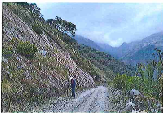
foto 207: KM 10 + 300, donde se puede observar que la capa de rodadura tiene baches y ausencia de material.
