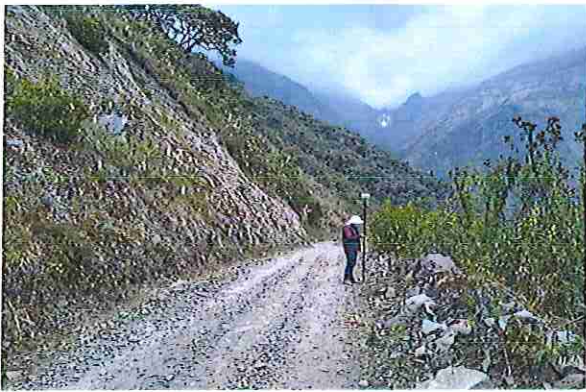
foto 327: KM 16 + 300, Ausencia de material de afirmado, con presencia de deformaciones y erosiones
