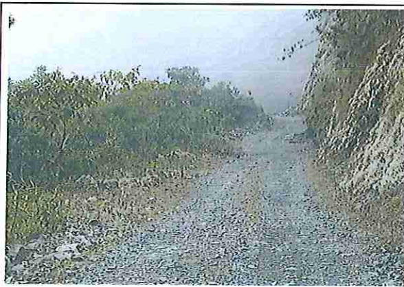
foto 179: KM 08 + 900, Ausencia de material de afirmado, con presencia de deformaciones y erosiones.
