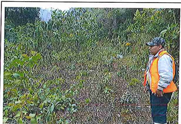
foto 140: KM 06 + 950, Ausencia de material de afirmado, con presencia de deformaciones y erosiones
