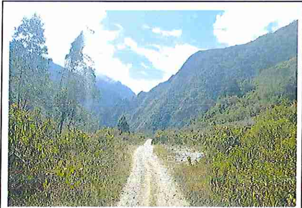
foto 445: KM 22 + 250, Ausencia de material de afirmado, con presencia de deformaciones y erosiones.
