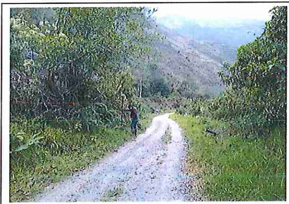
foto 355: KM 17 + 700, Ausencia de material de afirmado, con presencia de deformaciones y erosiones.
