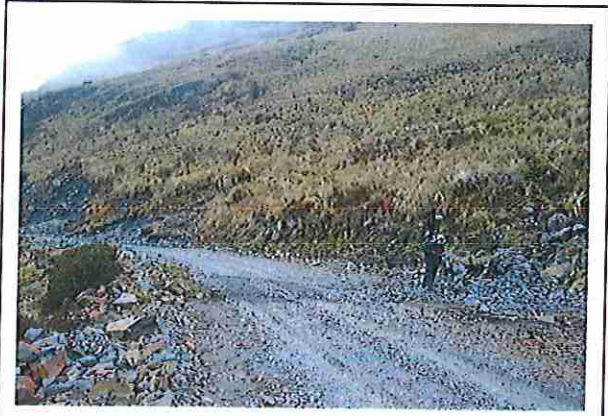
foto 116: KM 05 + 750, Ausencia de material de afirmado, con presencia de deformaciones y erosiones.
