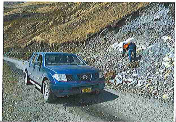
foto 14: KM 03 + 250,baden de piedra donde se puede observar que la capa de rodadura presenta ahuellamiento
