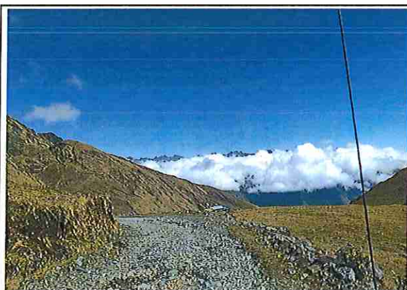
foto 17: KM 00 + 800, donde se puede observar que tiene la capa de rodadura tiene erosión severa.
