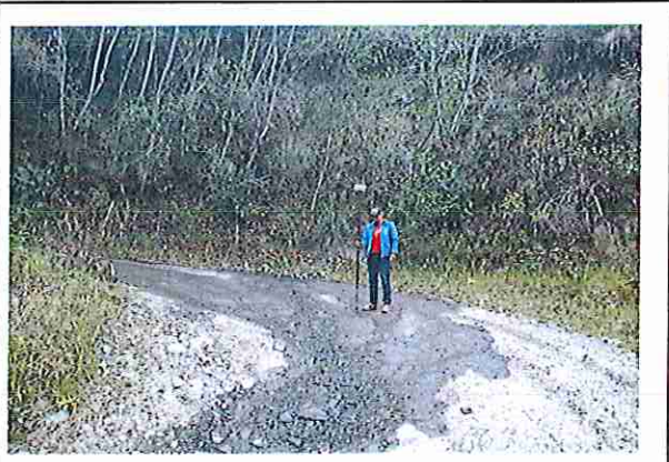
Foto 196: KM 09 + 750, Ausencia de material de afirmado, con presencia de deformaciones y erosiones.
