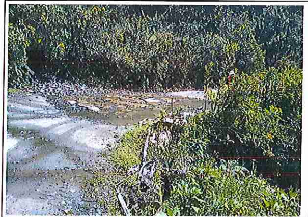
foto 20: baden KM 13 + 980 en regular estado pero está semi obstruida.
