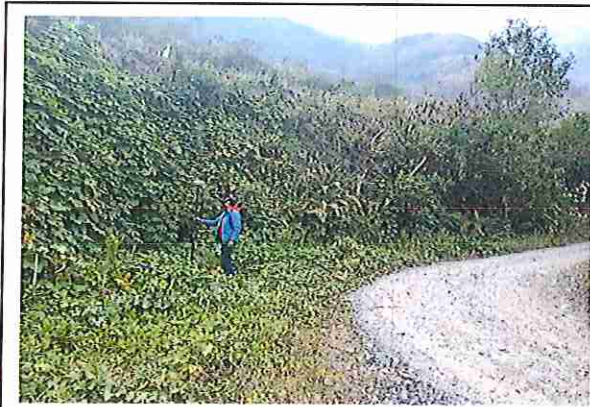
foto 295: KM 14 + 700, donde se puede observar que la capa de rodadura tiene baches y ausencia de material.
