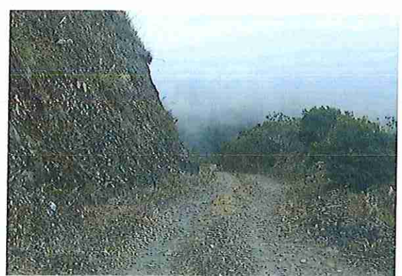
foto 71: KM 03 + 500, donde se puede observar que tiene la capa de rodadura tiene erosión
