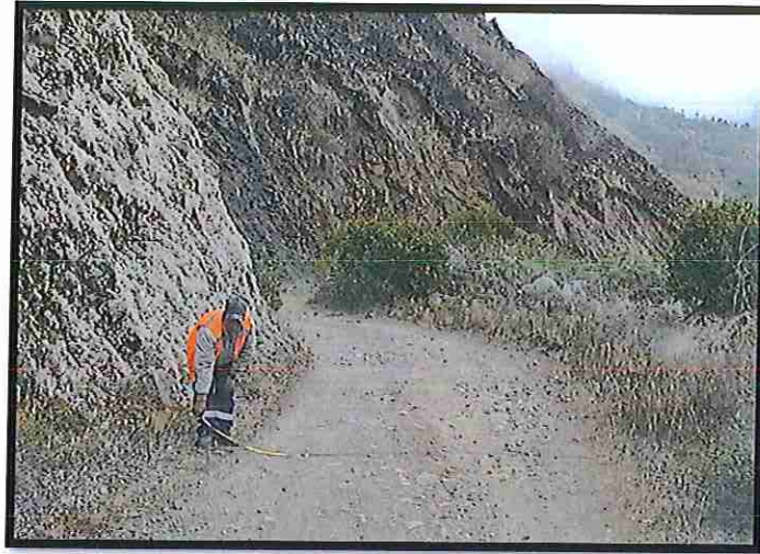
FOTO N° 03 Se puede apreciar el estado de la superficie de rodadura entre el Km 2 + 001- Km 3 + 000
