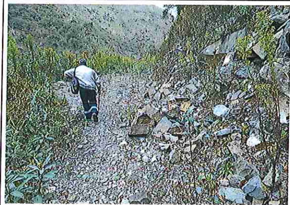
Foto 98: KM 04 + 850, donde se puede observar que tiene la capa de rodadura tiene erosión
