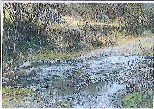
foto 03: baden, KM 02 + 050 se encuentra en regular estado requiere de limpieza.
