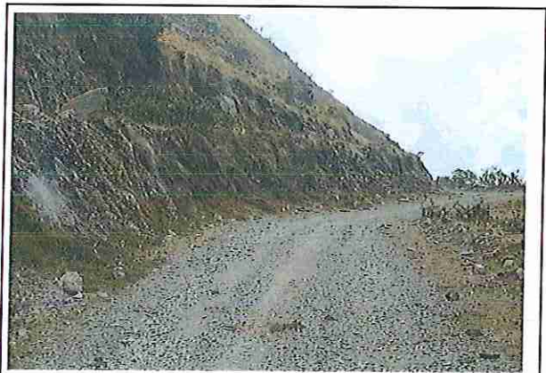
foto 130: KM 06 + 450, Talud margen Izd. Ausencia de material de afirmado, con presencia de deformaciones y erosiones.
