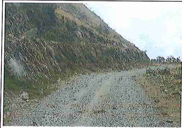
foto 140: KM 06 + 950, Ausencia de material de afirmado, con presencia de deformaciones y erosiones.
