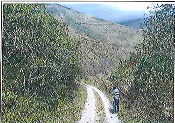
foto 405: KM 20 + 200, Ausencia de material de afirmado y erosiones por falta de baden.
