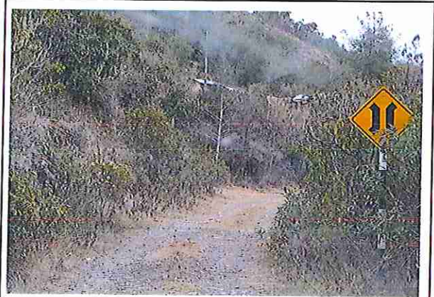
FOTO N°02: SEÑAL PREVENTIVA KM 4+400, estado regular. Falta pintura
