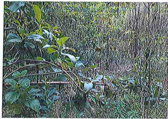
foto 158: KM 07 + 900, Ausencia de material de afirmado, con presencia de deformaciones y erosiones
