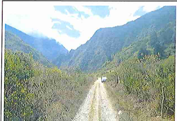
foto 447: KM 22 + 350, Ausencia de material de afirmado, con presencia de deformaciones y erosiones.
