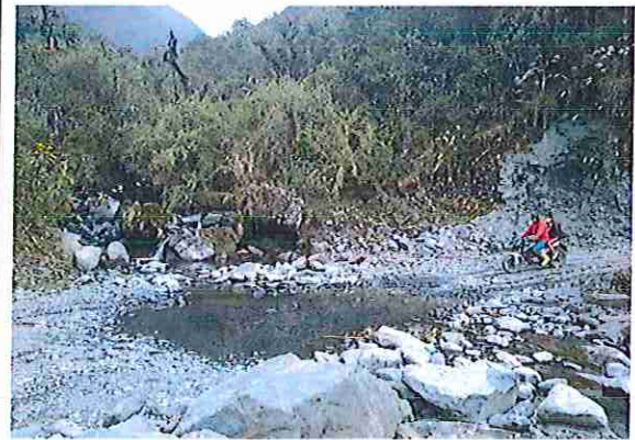
foto 10: baden KM 02 + 890, se encuentra en regular estado y parcialmente obstruida.
