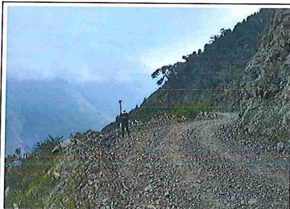
foto 32: KM 07 + 750, Talud margen lzd. Ausencia de material de afirmado, con presencia de deformaciones y erosiones.
