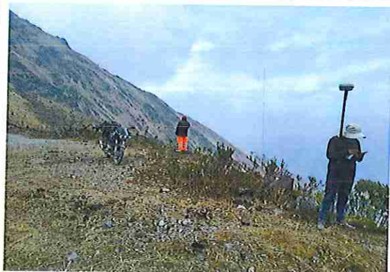
foto 71: KM 03 + 500, Ausencia de material de afirmado, con presencia de deformaciones y erosiones.
