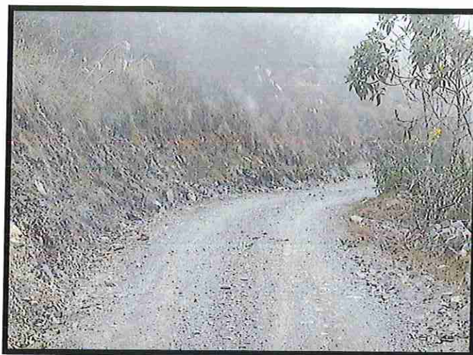
FOTO N° 09 Se puede apreciar el estado de la superficie de rodadura entre el Km 8 + 001- Km 09 + 000
