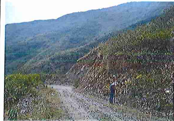
foto 220: KM 10 + 950, donde se puede observar que la capa de rodadura tiene baches y ausencia de material.
