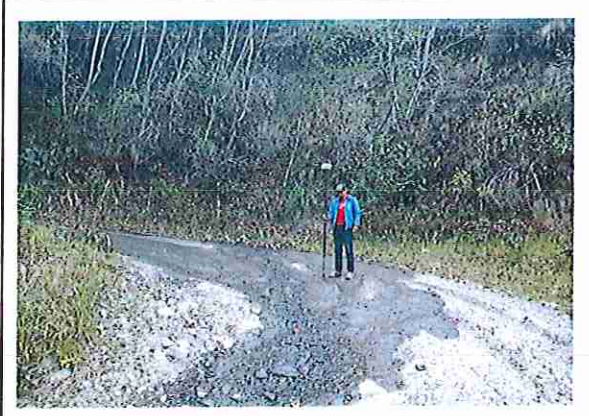
foto 358: KM 17 + 850, Ausencia de material de afirmado, con presencia de deformaciones y erosiones.
