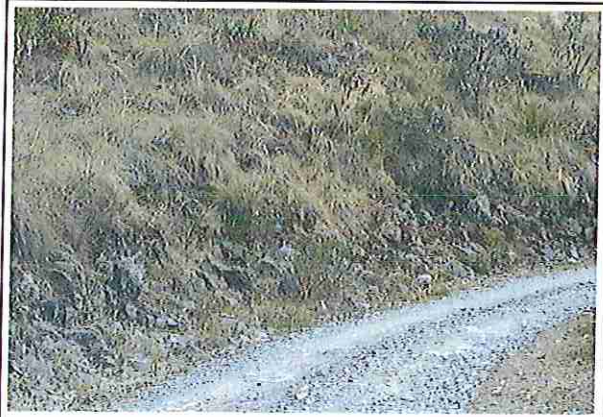
foto 136: KM 06 + 750, Ausencia de material de afirmado, con presencia de deformaciones y erosiones.
