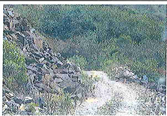
foto 57: KM 02 + 800, Ausencia de material de afirmado, con presencia de deformaciones y erosiones.
