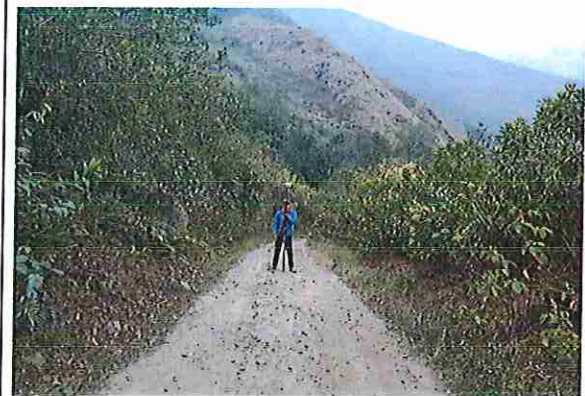
foto 400: KM 19 + 950, Ausencia de material de afirmado, con presencia de deformaciones y ahuellamiento.
