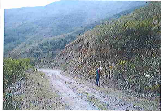
foto 218: KM 10 + 850, donde se puede observar que la capa de rodadura tiene baches y ausencia de material.
