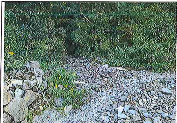
Foto 88: KM 04 + 350, donde se puede observar que tiene la capa de rodadura tiene erosión
