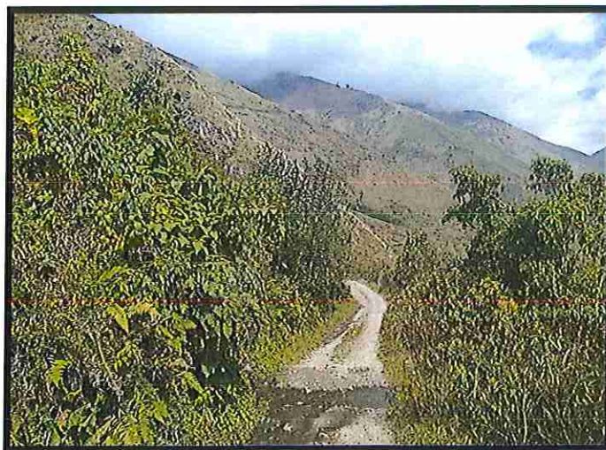
FOTO N° 19 Se puede apreciar el estado de la superficie de rodadura entre el Km 18 + 001- Km 19 + 000
