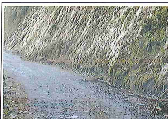
foto 164: KM 08 + 150, Ausencia de material de afirmado, con presencia de deformaciones y erosiones.
