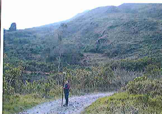
foto 348: KM 17 + 350, Ausencia de material de afirmado, con presencia de deformaciones y ahuellamiento.
