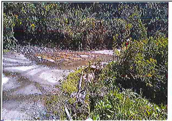
foto 06: KM 01 + 820, baden se encuentra en estado regular.
