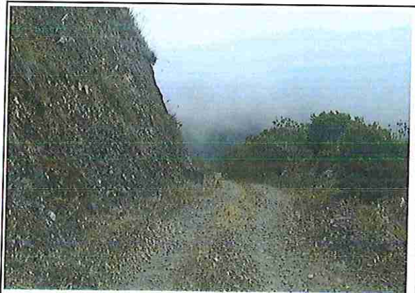
foto 10: KM 02 + 250, Ausencia de material de afirmado, con presencia de deformaciones y erosiones.
