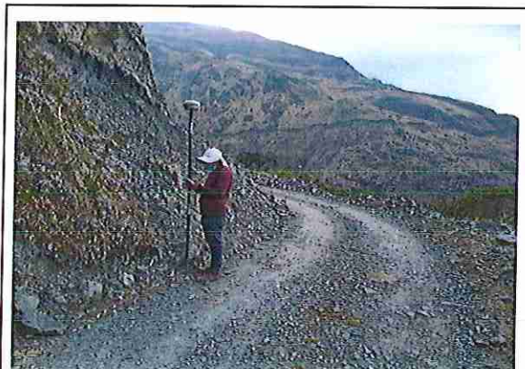
foto 148: KM 07 + 350 , Talud margen Der. Ausencia de material de afirmado, con presencia de deformaciones y erosiones.
