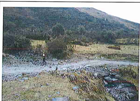
foto 38: KM 01 + 850, donde se puede observar que tiene la capa de rodadura tiene erosión severa.
