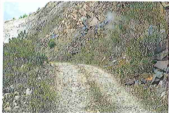
foto 40: KM 01 + 950, Ausencia de material de afirmado, con presencia de deformaciones y erosiones.
