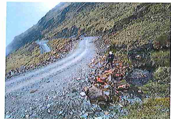
foto 46: 02 + 250, Ausencia de material de afirmado, con presencia de deformaciones y erosiones.
