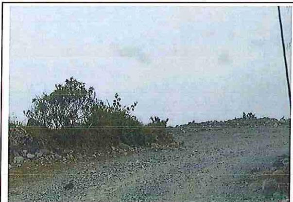
foto 195: KM 09 + 700 Ausencia de material de afirmado, con presencia de deformaciones y erosiones.
