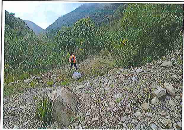
foto 28: KM 06 + 750, Ausencia de material de afirmado, con presencia de deformaciones y erosiones
