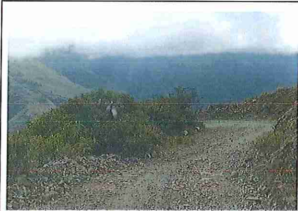
foto 277: KM 13 + 800, donde se puede observar que la capa de rodadura tiene baches y ausencia de material.
