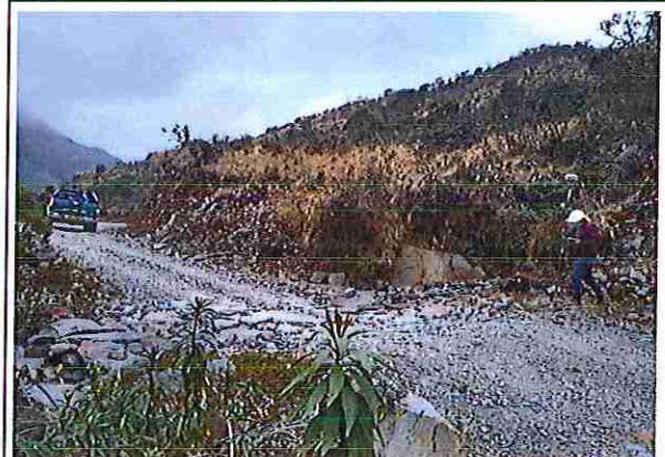
foto 04: baden KM 00 + 960, se encuentra en regular estado requiere de limpieza.
