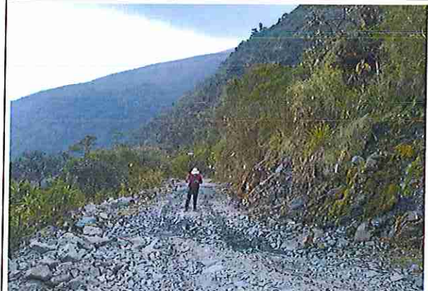
foto 54: KM 13 + 250, donde se puede observar que la capa de rodadura tiene baches y ausencia de material.
