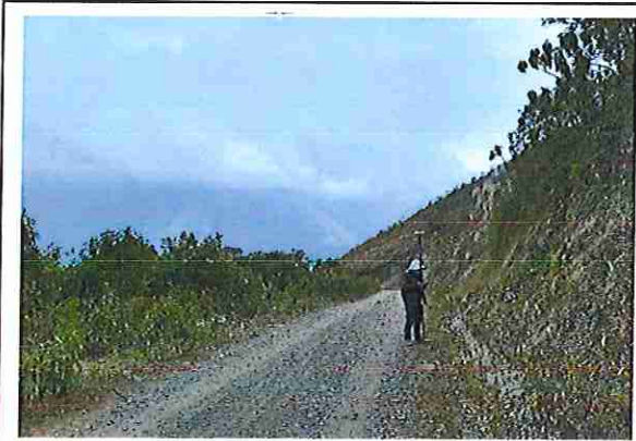
foto 283: KM 14 + 100, talud margen lsd. Ausencia de material de afirmado, con presencia de deformaciones y erosione.
