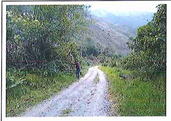
foto 356: KM 17 + 750, Ausencia de material de afirmado, con presencia de deformaciones y erosiones.
