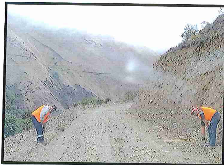
FOTO N° 07 Se puede apreciar el estado de la superficie de rodadura entre el Km 6 + 001- Km 7 + 000
