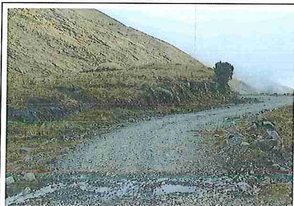
foto 19: KM 04 + 500, Ausencia de material de afirmado, con presencia de deformaciones y erosiones.
