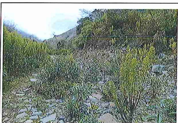
foto 89: KM 04 + 400, donde se puede observar que tiene la capa de rodadura tiene erosión
