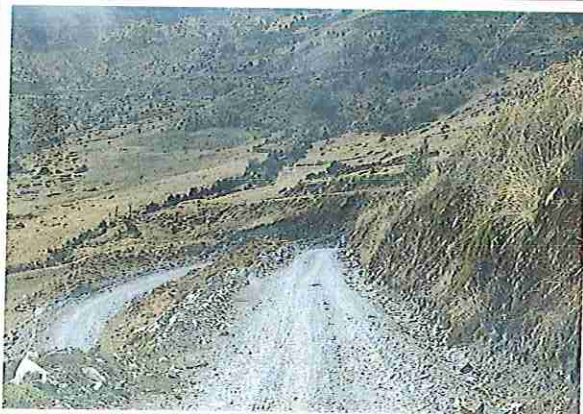
foto 69: KM 03 + 400, Ausencia de material de afirmado, con presencia de deformaciones y erosiones.
