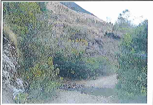
foto 22: KM 01 + 050, Ausencia de material de afirmado, con presencia de deformaciones y erosiones.
