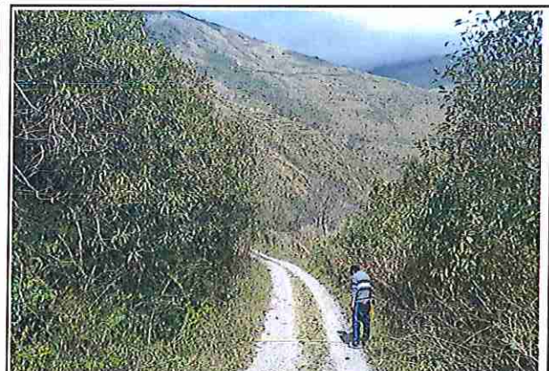
foto 459: KM 22 + 450 ,Ausencia de material de afirmado, con presencia de deformaciones y erosiones.
