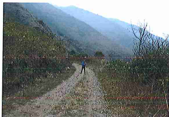
foto 404: KM 20 + 150. Ausencia de material de afirmado, con presencia de deformaciones y ahuellamiento.
