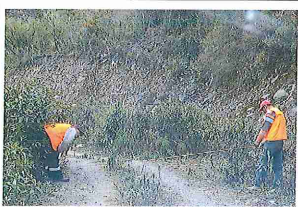
foto 87: KM 04 + 300, donde se puede observar que tiene la capa de rodadura tiene erosión
