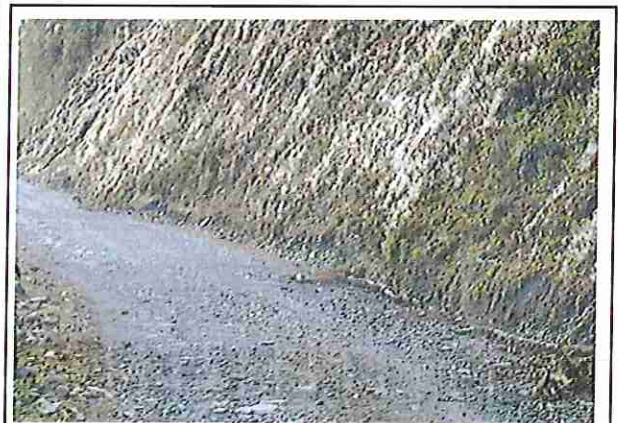
foto 172: KM 08 + 550, Ausencia de material de afirmado, con presencia de deformaciones y erosiones.
