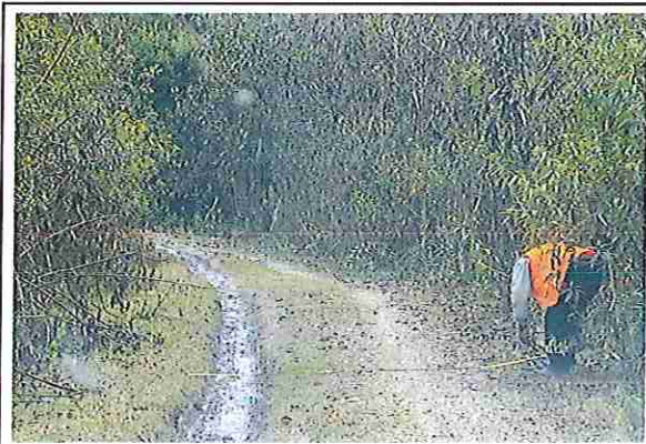
foto 55: KM 02 + 700, Ausencia de material de afirmado, con presencia de deformaciones y erosiones.
