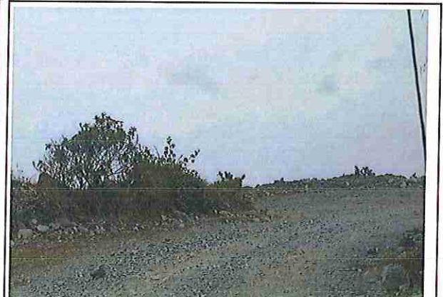
foto 178: KM 08 + 850, Ausencia de material de afirmado, con presencia de deformaciones y erosiones.
