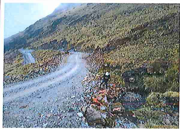
foto 26: KM 01 + 250, donde se puede observar que tiene la capa de rodadura tiene erosión.
