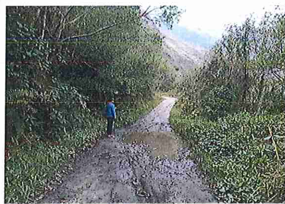
foto 264: KM 13 + 150, donde se puede observar que la capa de rodadura tiene baches y ausencia de material.
