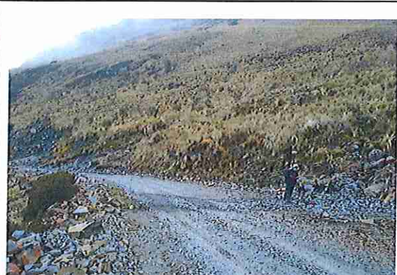
foto 36: KM 01 + 750, donde se puede observar que tiene la capa de rodadura tiene erosión severa.
