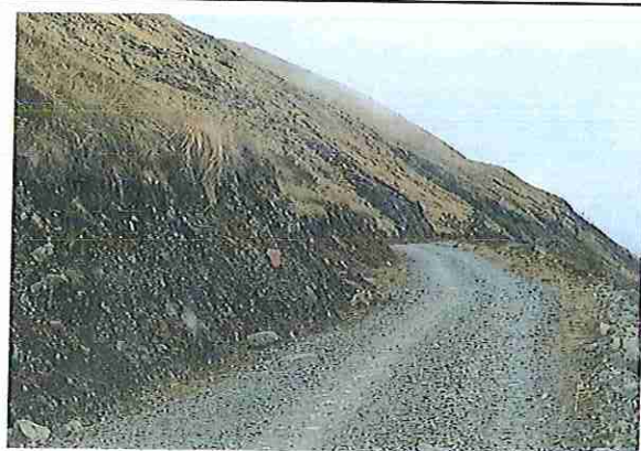
foto 89: KM 04 + 400, Ausencia de material de afirmado, con presencia de deformaciones y erosiones.
