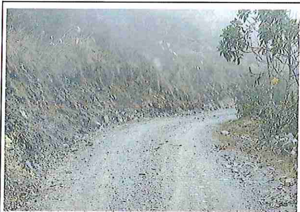
foto 188: KM 09 + 350. Ausencia de material de afirmado, con presencia de deformaciones y erosiones.
