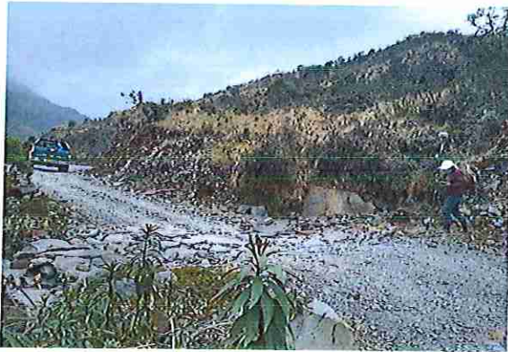
foto 63: KM 03 + 100 ,baden de piedra donde se puede observar que la capa de rodadura presenta ahuellamiento
