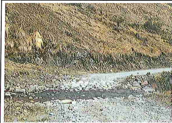
foto 19: badén KM 13 + 340, se encuentra en buen estado, pero requiere de limpieza
