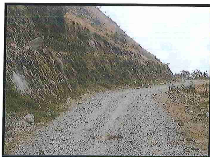
FOTO N° 06 Se puede apreciar el estado de la superficie de rodadura entre el Km 5 + 001- Km 6 + 000
