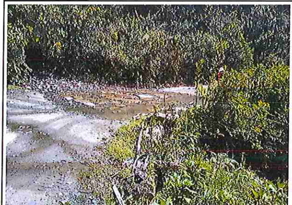
foto 20: badén KM 13 + 980 en regular estado pero está semi obstruida.
