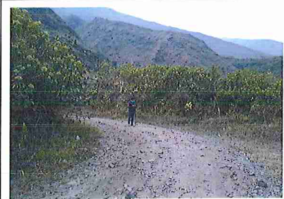
foto 304: KM 15+ 150, donde se puede observar que la capa de rodadura tiene baches y ausencia de material.
