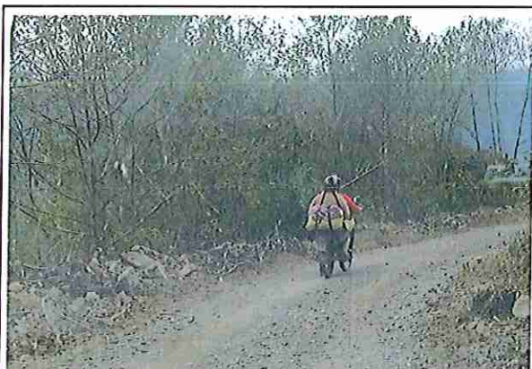
foto 269: KM 13 + 400, donde se puede observar que la capa de rodadura tiene baches y ausencia de material.
