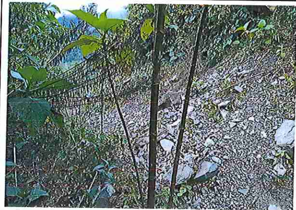
foto 146: KM 07 + 250, Ausencia de material de afirmado, con presencia de deformaciones y erosiones
