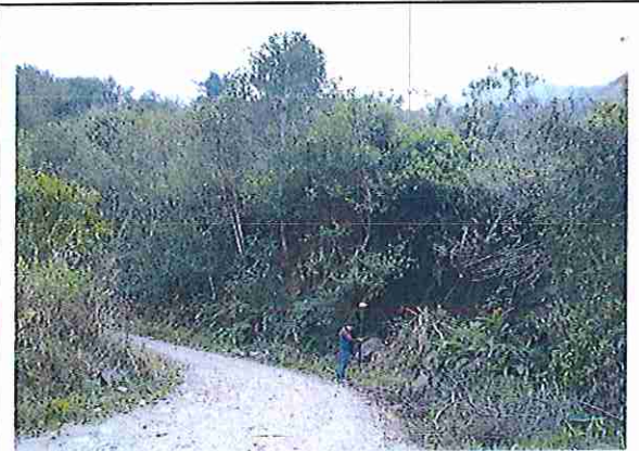
foto 359: KM 17 + 900, Ausencia de material de afirmado, con presencia de deformaciones y erosiones.
