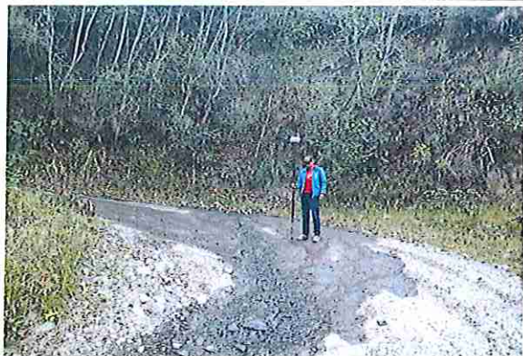
foto 191: KM 09 + 500, Ausencia de material de afirmado, con presencia de deformaciones y erosiones.
