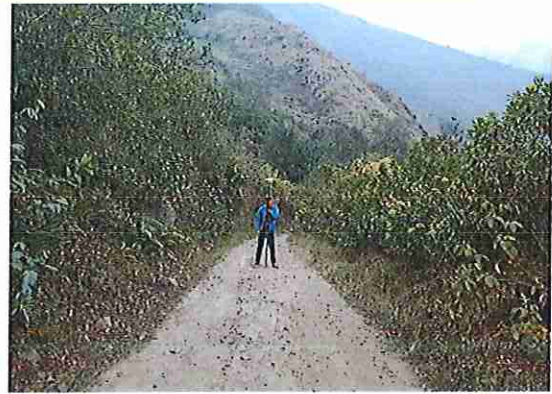
foto 242: KM 12 + 050, talud margen Der. Ausencia de material de afirmado, con presencia de deformaciones y erosiones.
