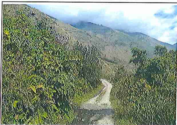
foto 431: KM 21 + 500, Ausencia de material de afirmado, con presencia de deformaciones y erosiones.
