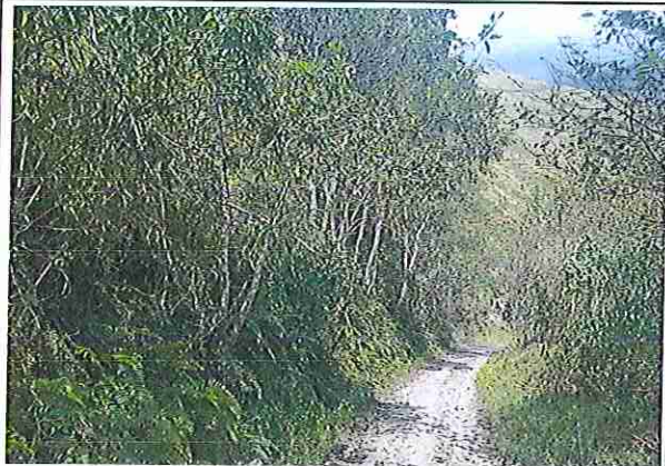
foto 81: KM 20 + 000, Ausencia de material de afirmado y erosiones por falta de baden.
