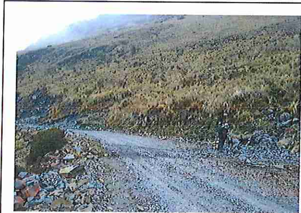
foto 122: KM 06 + 050, Ausencia de material de afirmado, con presencia de deformaciones y erosiones.
