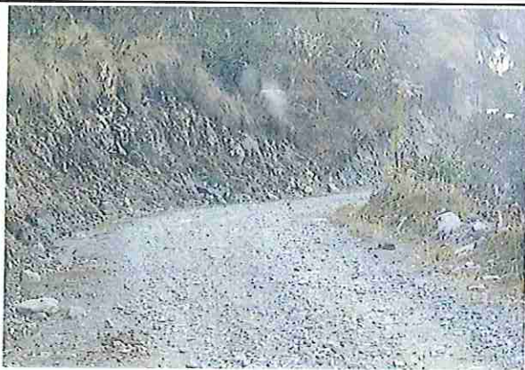
foto 177: KM 08 + 800, Ausencia de material de afirmado, con presencia de deformaciones y erosiones.
