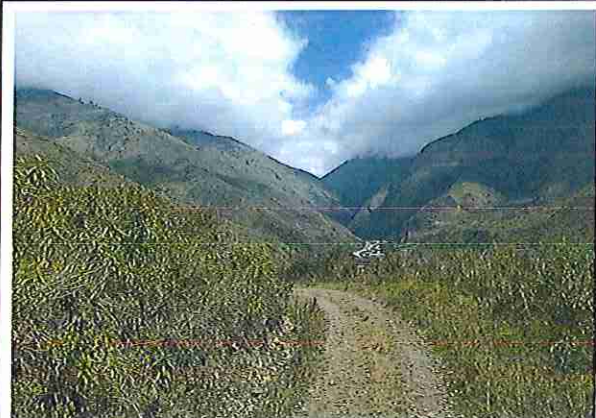
foto 385: KM 19 + 200, Ausencia de material de afirmado, con presencia de deformaciones y erosiones.
