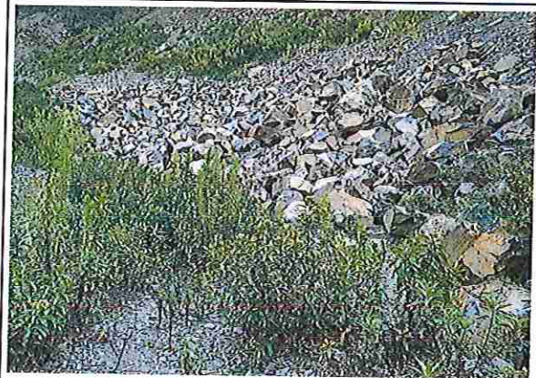
Foto 92: KM 04 + 550, donde se puede observar que tiene la capa de rodadura tiene erosión
