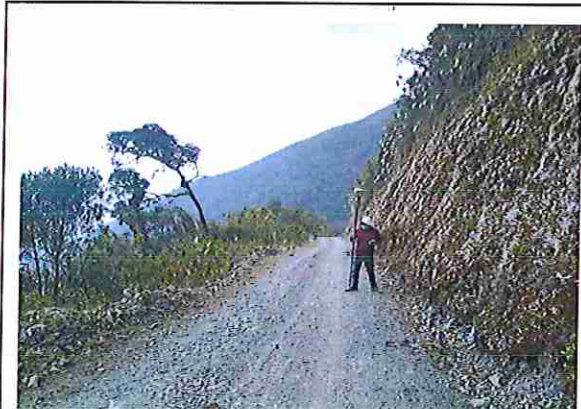
foto 147: KM 07 + 300, Ausencia de material de afirmado, con presencia de deformaciones y erosiones.
