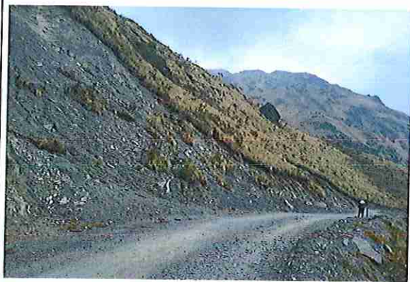
foto 91: KM 04 + 500, Ausencia de material de afirmado, con presencia de deformaciones y erosiones.
