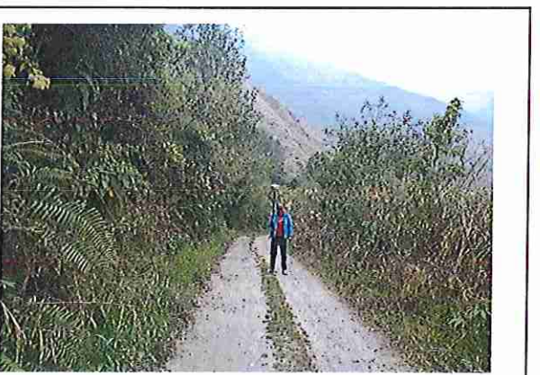
foto 312: KM 15 + 550, Ausencia de material de afirmado, con presencia de deformaciones y erosiones
