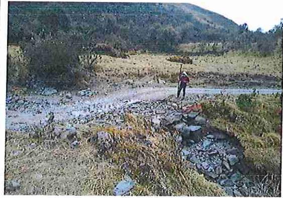
foto 118: KM 05 + 850, Ausencia de material de afirmado, con presencia de deformaciones y erosiones.
