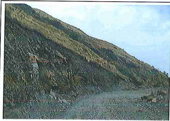
foto 97: KM 04 + 800, Ausencia de material de afirmado, con presencia de deformaciones y erosiones.
