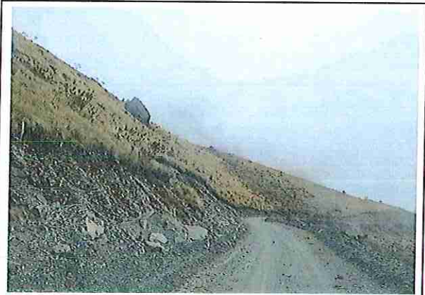
foto 135: KM 06 + 700, Talud margen lzd. Ausencia de material de afirmado, con presencia de deformaciones y erosiones.
