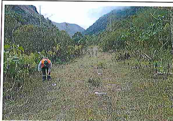
foto 136: KM 06 + 750, Ausencia de material de afirmado, con presencia de deformaciones y erosiones
