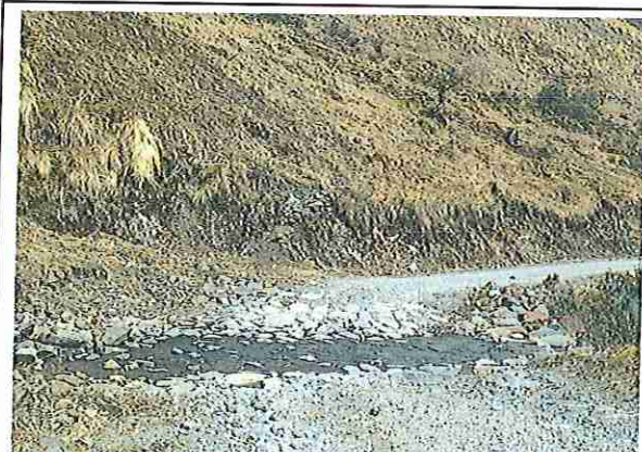
foto 77: KM 03 + 800, Ausencia de material de afirmado, con presencia de deformaciones y erosiones.
