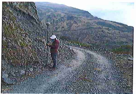
foto 298: KM 14 + 850, talud margen Izq. Ausencia de material de afirmado, con presencia de deformaciones y erosione.
