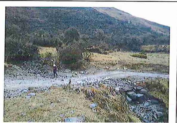
foto 39: KM 01 + 900, donde se puede observar que tiene la capa de rodadura tiene erosión
