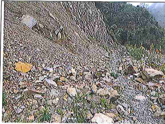
Tramo Pumachaca - Mapuaraya Foto n° 3: FALLA GEOLOGICA, zona de deslizamiento de la vía, derrumbe de talud, 07+550.
