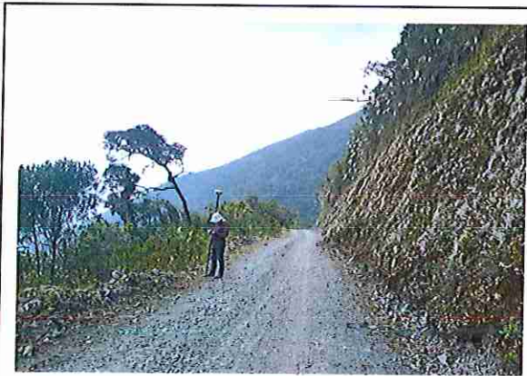
foto 151: KM 07 + 500, Ausencia de material de afirmado, con presencia de deformaciones y erosiones.
