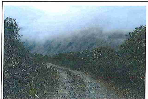
foto 12: KM 00 + 550, Ausencia de material de afirmado, con presencia de deformaciones y erosiones.
