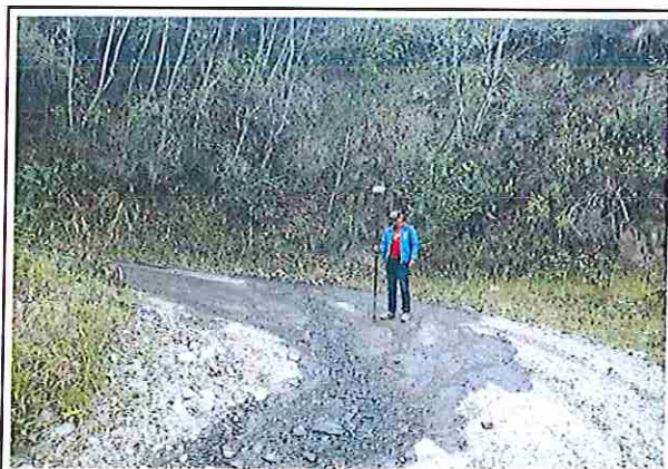
foto 35: KM 08 + 500, Ausencia de material de afirmado, con presencia de deformaciones y erosiones.
