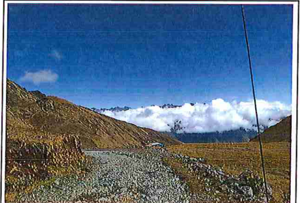
foto 04: KM 00 + 750, donde se puede observar que tiene la capa de rodadura tiene erosión
