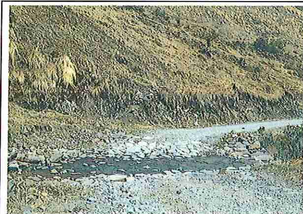
foto 07: Tajea KM 02 + 030, baden se encuentra en mal estado requiere de limpieza
