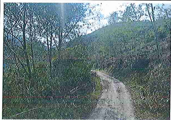
foto 361: KM 18 + 000, Ausencia de material de afirmado, con presencia de deformaciones y erosiones.
