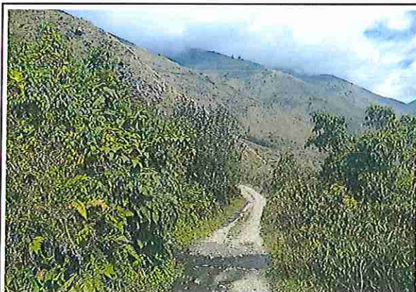
foto 448: KM 22 + 400, Ausencia de material de afirmado, con presencia de deformaciones y erosiones.
