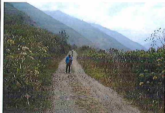
foto 226: KM 11 + 250, Ausencia de material de afirmado, con presencia de deformaciones y erosiones.
