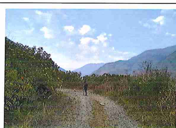
foto 292: KM 14 + 550, donde se puede observar que la capa de rodadura tiene baches y ausencia de material.
