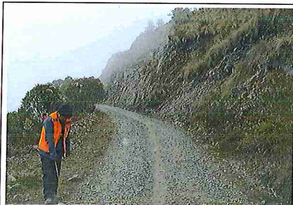
foto 153: KM 07 + 600, Ausencia de material de afirmado, con presencia de deformaciones y erosiones.
