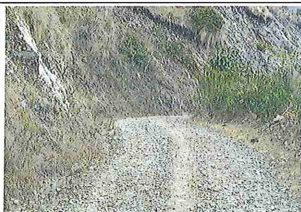
foto 233: KM 11 + 600, talud margen Izq. Ausencia de material de afirmado, con presencia de deformaciones y erosiones.
