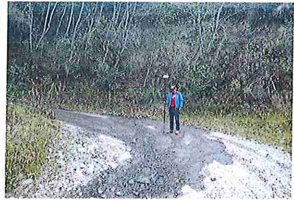
foto 190: KM 09 + 450. Ausencia de material de afirmado, con presencia de deformaciones y erosiones.
