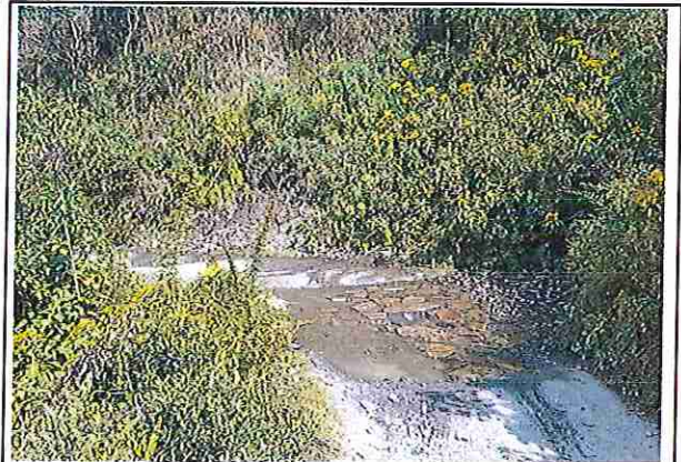
foto 22: baden KM 18 + 700 en regular estado pero está semi obstruida.
