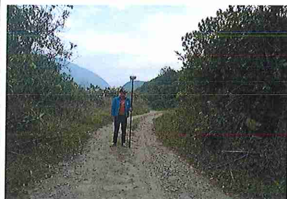
foto 366: KM 18 + 250, Ausencia de material de afirmado, con presencia de deformaciones y ahuellamiento.
