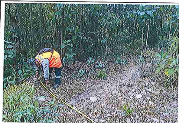
foto 133: KM 06 + 600, Ausencia de material de afirmado, con presencia de deformaciones y erosiones
