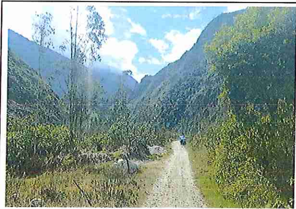
foto 450: KM 22 + 500, Ausencia de material de afirmado, con presencia de deformaciones y erosiones.
