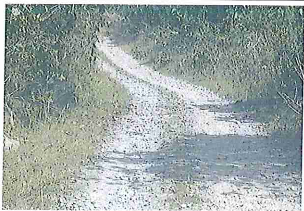
foto 345: KM 17 + 200, Ausencia de material de afirmado, con presencia de deformaciones y ahuellamiento.
