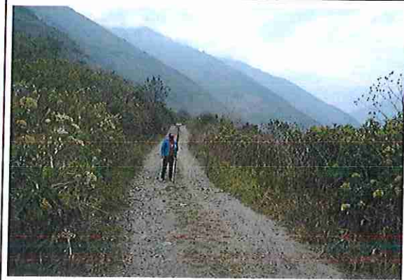
foto 416: KM 20 + 750, Ausencia de material de afirmado, con presencia de deformaciones y erosiones.
