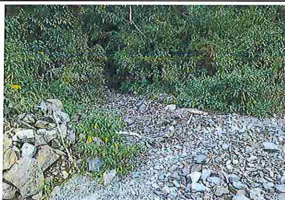
foto 83: KM 04 + 100, donde se puede observar que tiene la capa de rodadura tiene erosión
