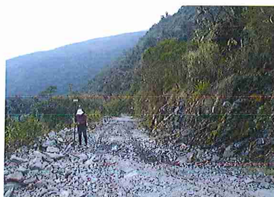
foto 266: KM 13 + 250, donde se puede observar que la capa de rodadura tiene baches y ausencia de material.
