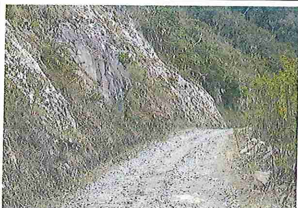
foto 237: KM 11 + 800, donde se puede observar que la capa de rodadura tiene baches y ausencia de material.
