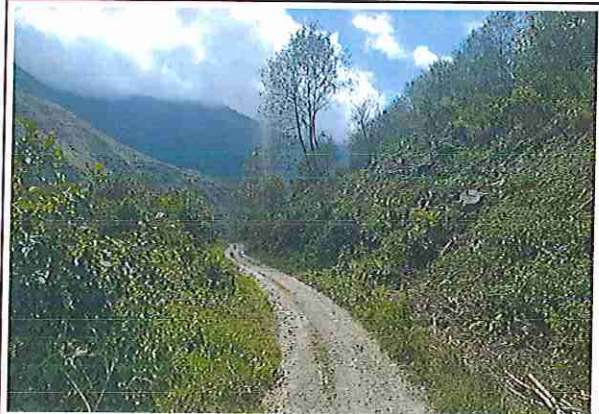
foto 82: KM 20 + 250. Ausencia de material de afirmado, con presencia de deformaciones y ahuellamiento.
