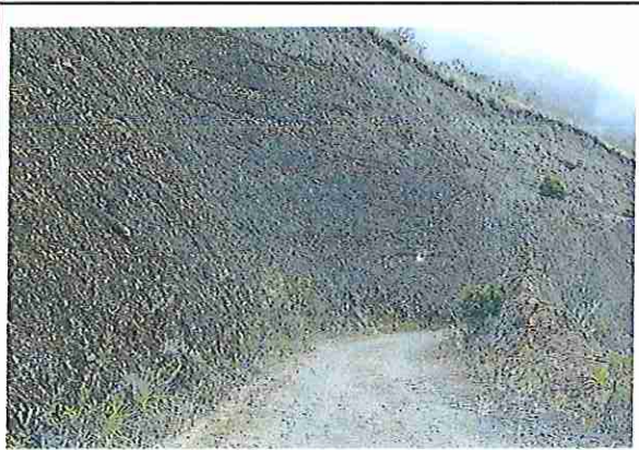
foto 35: KM 01 + 700, Ausencia de material de afirmado, con presencia de deformaciones y erosiones.
