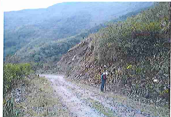
foto 330: KM 16 + 450, Ausencia de material de afirmado, con presencia de deformaciones y ahuellamiento.
