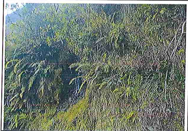
foto 428: KM 21 + 350, Ausencia de material de afirmado, con presencia de deformaciones y erosiones.
