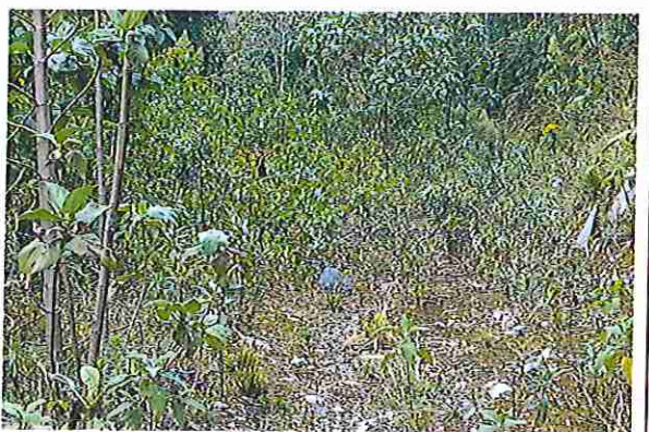
foto 141: KM 07 + 000, Ausencia de material de afirmado, con presencia de deformaciones y erosiones
