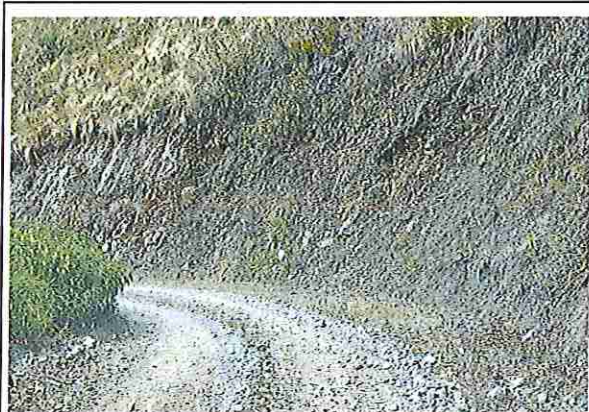
foto 301: KM 15 + 000 Terreno ondulado con un ancho de superficie de 3.99 m.
