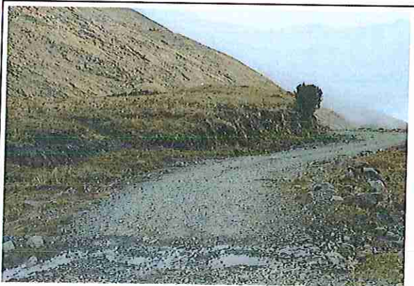
foto 88: KM 04 + 350, baden de piedra donde se puede observar que la capa de rodadura presenta ahuellamiento
