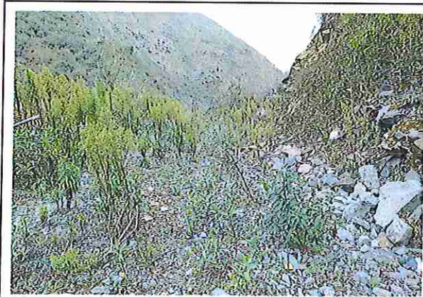
foto 97: KM 04 + 800, donde se puede observar que tiene la capa de rodadura tiene erosión
