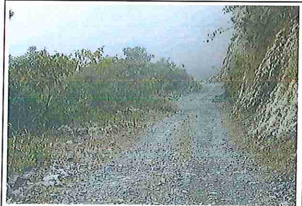
foto 38: KM 09 + 250.Talud margen Der.Ausencia de material de afirmado, con presencia de deformaciones y erosiones.
