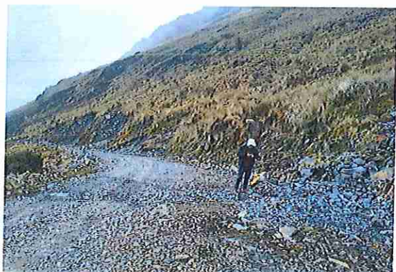
foto 95: KM 04 + 700, Ausencia de material de afirmado, con presencia de deformaciones y erosiones.
