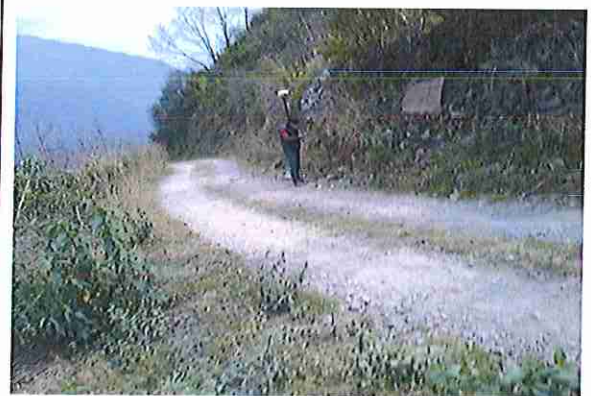
foto 324: KM 16 + 150, Ausencia de material de afirmado, con presencia de deformaciones y erosiones
