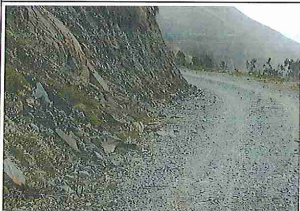
foto 21: KM 05 + 000, Ausencia de material de afirmado, con presencia de deformaciones y erosiones.
