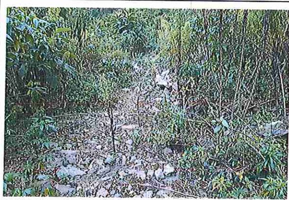
foto 127: KM 06 + 300, Ausencia de material de afirmado, con presencia de deformaciones y erosiones
