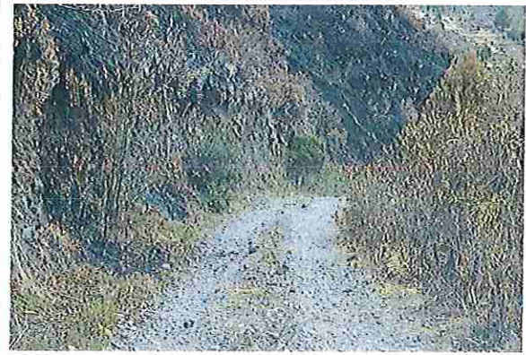
foto 32: KM 01 + 550, Ausencia de material de afirmado, con presencia de deformaciones y erosiones.
