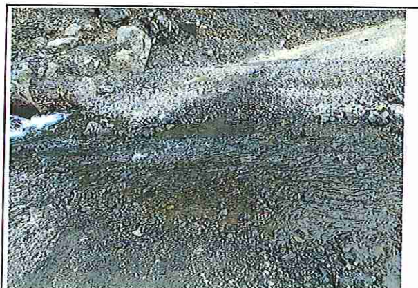
foto 18: baden KM 11 + 050 en regular estado pero está semi-obstruida.
