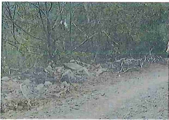
foto 285: KM 14 + 200, talud margen lsd. Ausencia de material de afirmado, con presencia de deformaciones y erosione.
