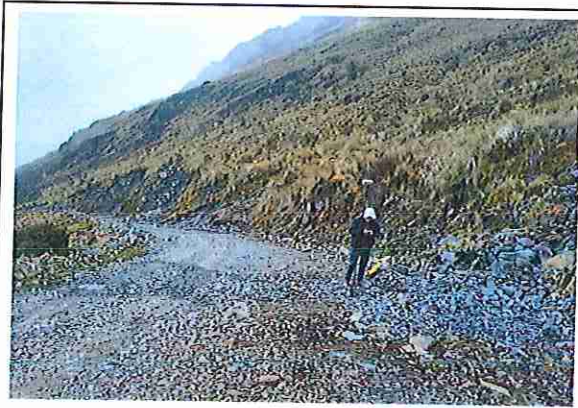
foto 67: KM 03 + 300, Ausencia de material de afirmado, con presencia de deformaciones y erosiones.
