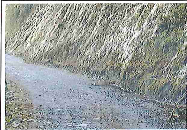
foto 193: KM 09 + 600 Talud margen Der. Ausencia de material de afirmado, con presencia de deformaciones y erosiones.
