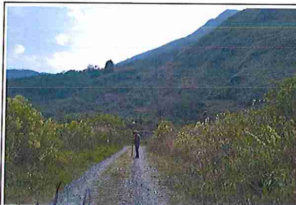
foto 66: KM 16 + 250, Ausencia de material de afirmado, con presencia de deformaciones y erosiones
