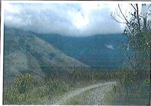
foto 333: KM 16 + 600, Ausencia de material de afirmado, con presencia de deformaciones y erosiones.
