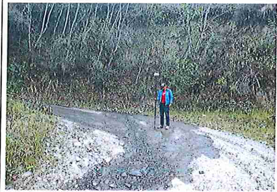
foto 182: KM 09 + 050, Ausencia de material de afirmado, con presencia de deformaciones y erosiones.
