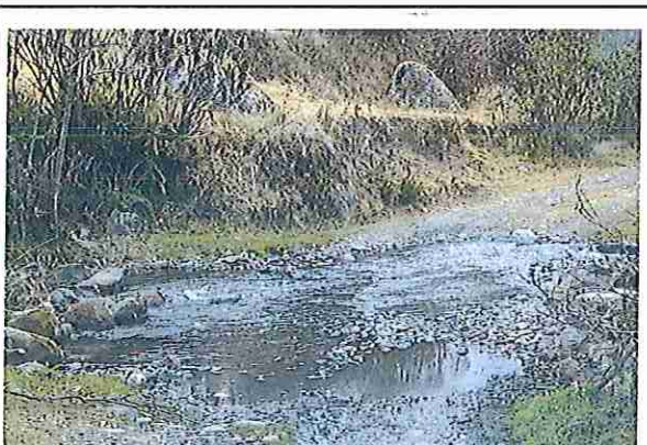
foto 29: KM 01 + 400, Ausencia de material de afirmado, con presencia de deformaciones y erosiones.
