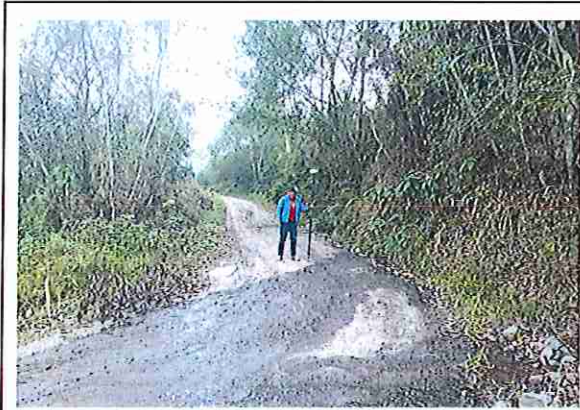
foto 247: KM 12 + 300, donde se puede observar que la capa de rodadura tiene baches y ausencia de material.
