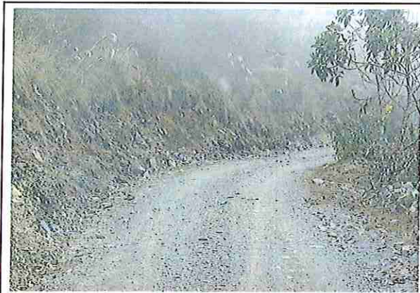
foto 169: KM 08 + 400, Ausencia de material de afirmado, con presencia de deformaciones y erosiones.
