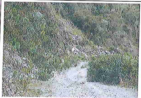
Foto 16: KM 03 + 750, donde se puede observar que tiene la capa de rodadura tiene erosión
