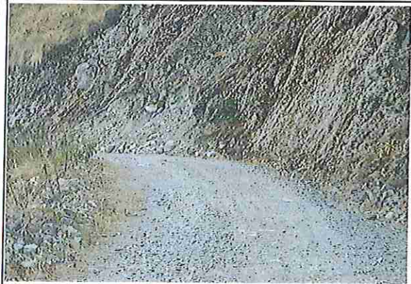
Foto 40: KM 09 + 750, Talud margen Der.Ausencia de material de afirmado, con presencia de deformaciones y erosiones.
