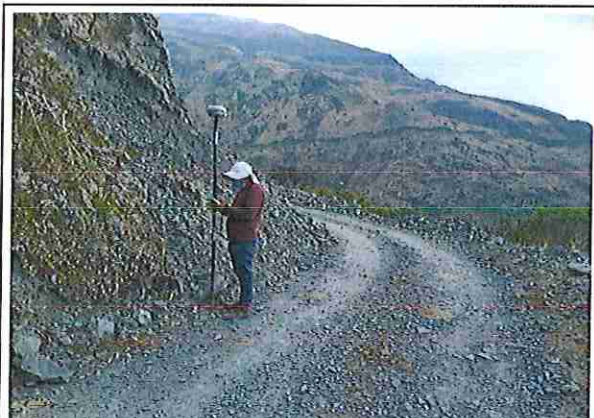
foto 55: KM 13 + 500, donde se puede observar que la capa de rodadura tiene baches y ausencia de material.
