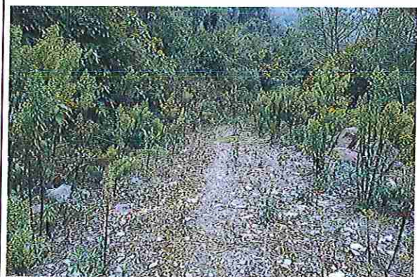
Foto 114: KM 05 + 650, donde se puede observar que tiene la capa de rodadura tiene erosión
