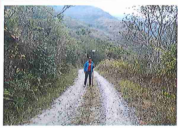
foto 258: KM 12 + 850, Ausencia de material de afirmado, con presencia de deformaciones y erosiones.
