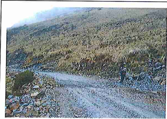
foto 127: KM 06 + 300, baden de piedra donde se puede observar que la capa de rodadura presenta ahuellamiento
