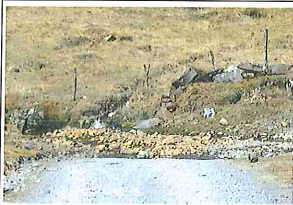
foto 19: KM 00 + 900, donde se puede observar que tiene la capa de rodadura tiene erosión severa.
