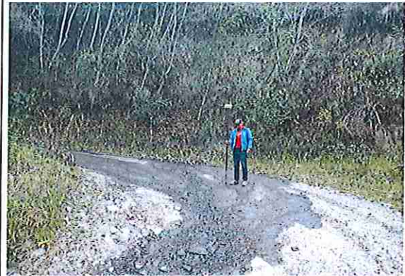
foto 248: KM 12 + 350, donde se puede observar que la capa de rodadura tiene baches y ausencia de material.
