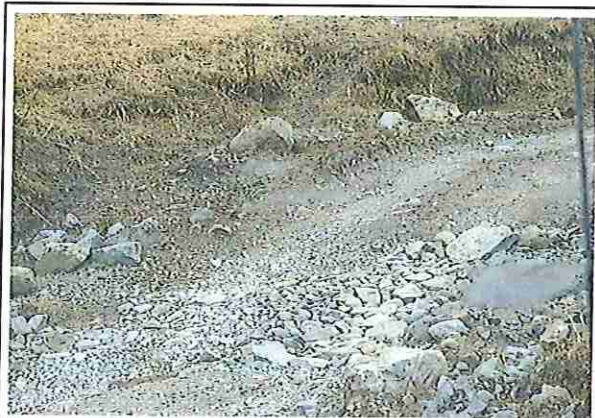
foto 121: KM 06 + 000, baden de piedra donde se puede observar que la capa de rodadura presenta ahuellamiento
