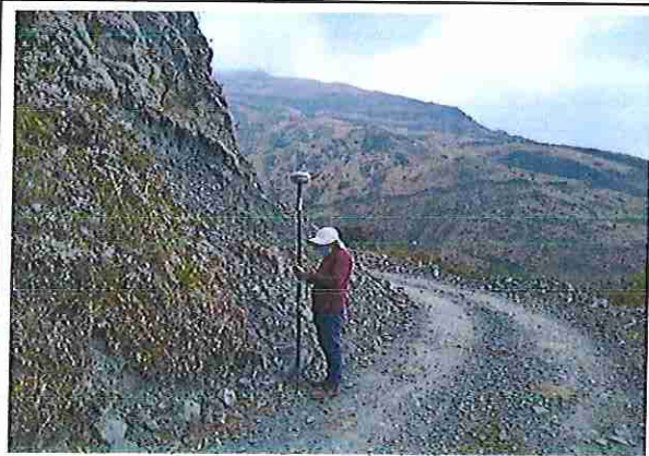
foto 27: KM 06 + 500, Talud margen Izd. Ausencia de material de afirmado, con presencia de deformaciones y erosiones.
