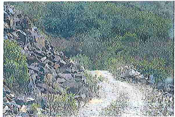
foto 50: KM 02 + 450, Ausencia de material de afirmado, con presencia de deformaciones y erosiones.
