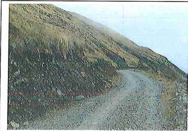
foto 13: KM 03 + 000 ,baden de piedra donde se puede observar que la capa de rodadura presenta ahuellamiento
