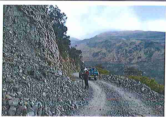
foto 187: KM 09 + 300, Talud margen Izq. Ausencia de material de afirmado, con presencia de deformaciones y erosiones.
