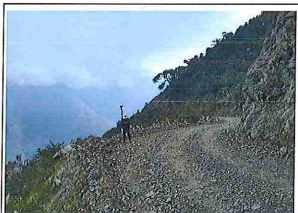
foto 168: KM 08 + 350, Ausencia de material de afirmado, con presencia de deformaciones y erosiones.
