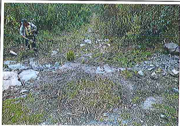
foto 107: KM 05 + 300, donde se puede observar que tiene la capa de rodadura tiene erosión
