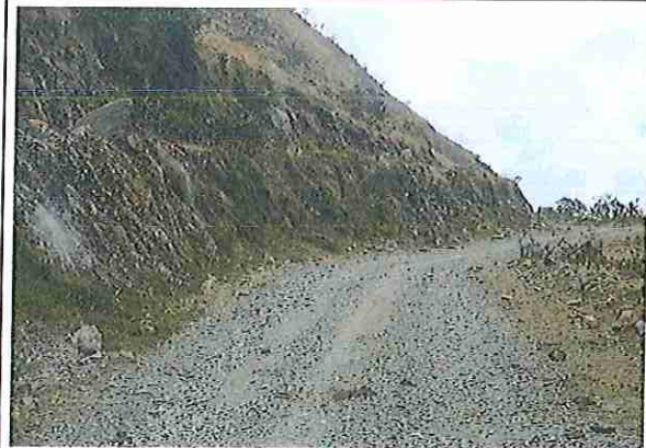
foto 120: KM 05 + 950, Talud margen izq. Ausencia de material de afirmado, con presencia de deformaciones y erosiones.
