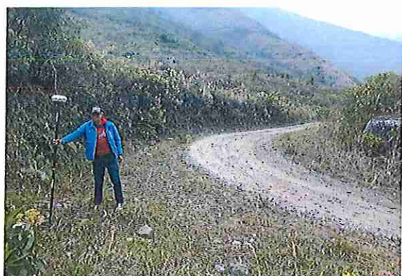
foto 407: KM 20 + 300, Ausencia de material de afirmado y erosiones por falta de baden.
