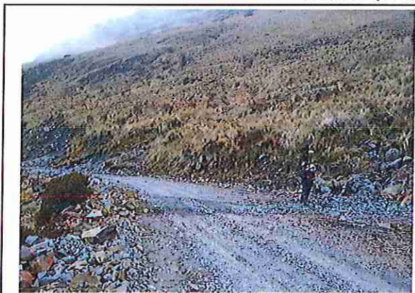
foto 01: Tajea , KM 00 + 320, estado regular.
