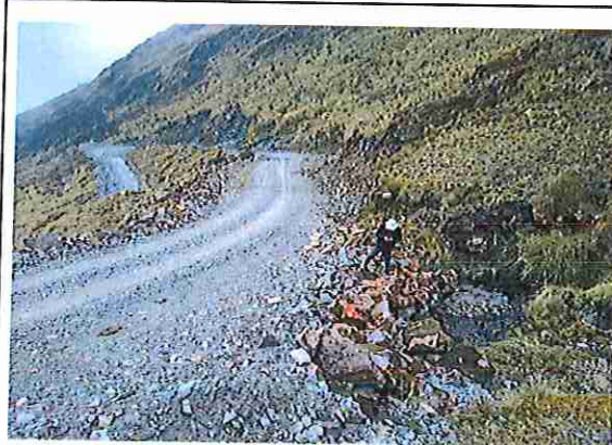
foto 86: KM 04 + 250, Ausencia de material de afirmado, con presencia de deformaciones y erosiones.
