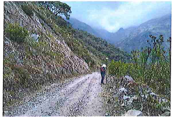
foto 328: KM 16 + 350, Ausencia de material de afirmado, con presencia de deformaciones y erosiones
