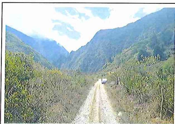
foto 441: KM 22 + 000, Ausencia de material de afirmado, con presencia de deformaciones y erosiones.
