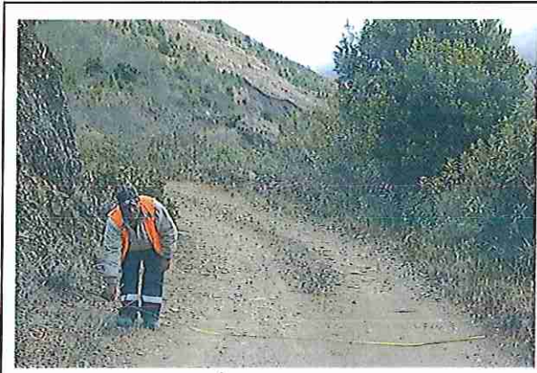
foto 19: KM 00 + 900, Ausencia de material de afirmado, con presencia de deformaciones y erosiones.
