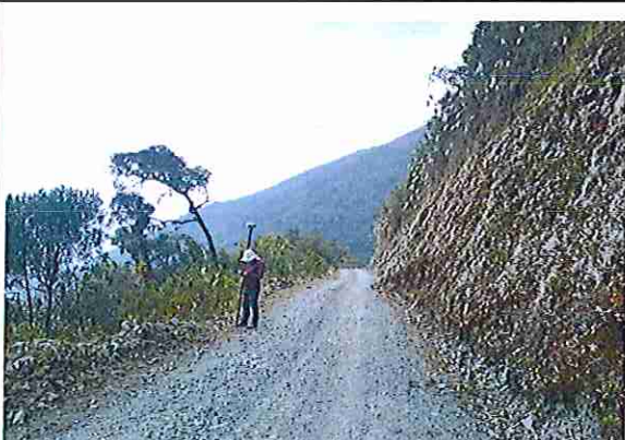
foto 299: KM 14 + 900 Terreno ondulado con un ancho de superficie de 3.99 m.
