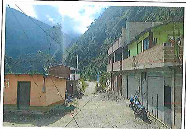
foto 91: KM 22 + 570 ,Ausencia de material de afirmado, con presencia de deformaciones y erosiones.
