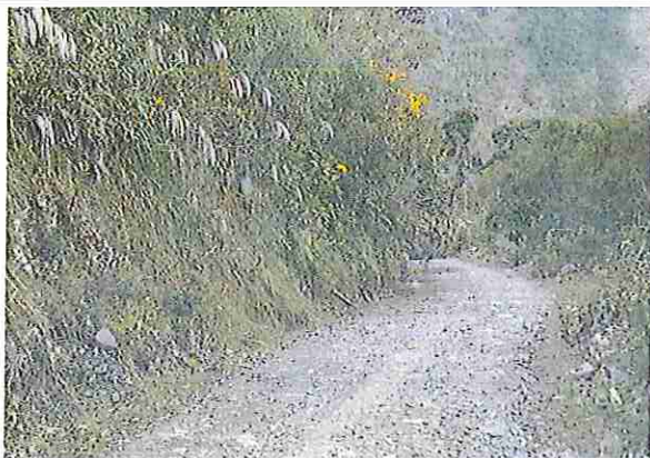
foto 257: KM 12 + 800, Ausencia de material de afirmado, con presencia de deformaciones y erosiones.
