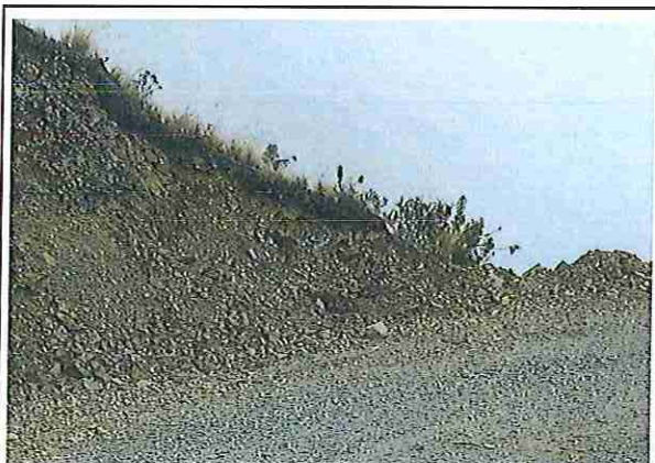
foto 149: KM 07 + 400, Ausencia de material de afirmado, con presencia de deformaciones y erosiones.
