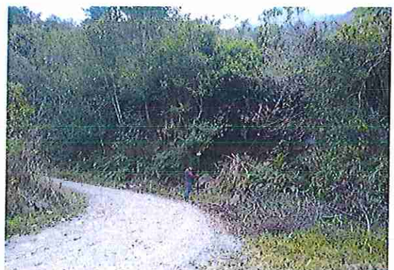
foto 376: KM 18 + 750, Ausencia de material de afirmado, con presencia de deformaciones y ahuellamiento.
