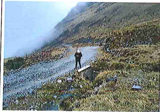
foto 62: KM 03 + 050,baden de piedra donde se puede observar que la capa de rodadura presenta ahuellamiento
