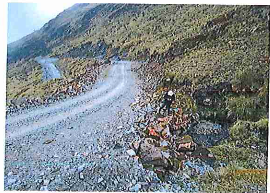
foto 92: KM 04 + 550, Ausencia de material de afirmado, con presencia de deformaciones y erosiones.
