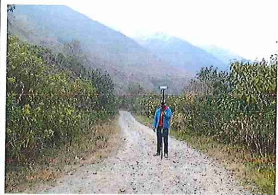
foto 296: KM 14 + 750, donde se puede observar que la capa de rodadura tiene baches y ausencia de material.
