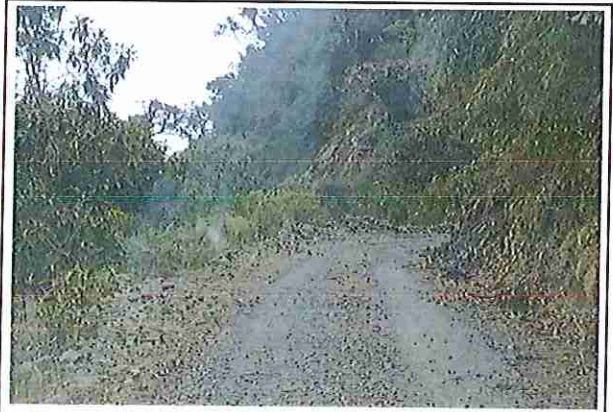
foto 44: KM 10 + 750, donde se puede observar que la capa de rodadura tiene baches y ausencia de material.
