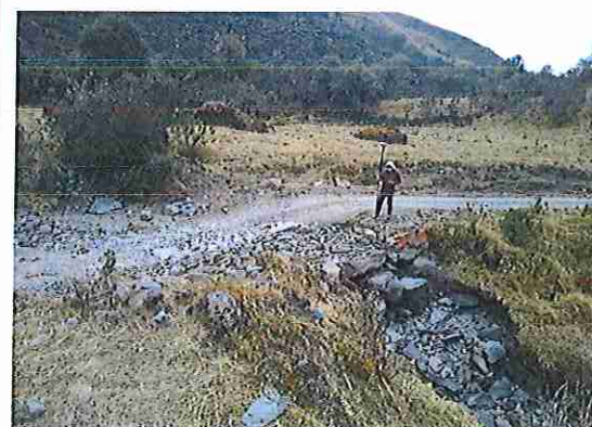
foto 24: KM 01 + 150, donde se puede observar que tiene la capa de rodadura tiene erosión.
