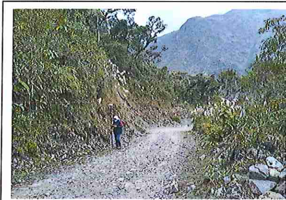
foto 223: KM 11 + 100, donde se puede observar que la capa de rodadura tiene baches y ausencia de material.
