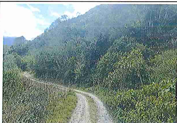
foto 365: KM 18 + 200, Ausencia de material de afirmado, con presencia de deformaciones y erosiones.
