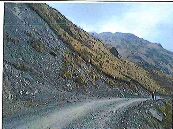
foto 12: KM 00 + 550, donde se puede observar que tiene la capa de rodadura tiene erosión
