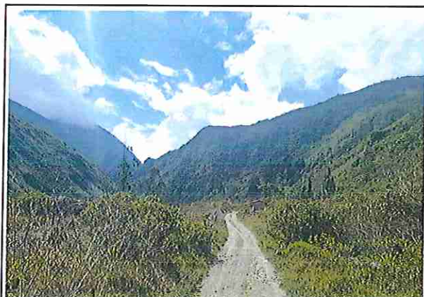
foto 442: KM 22 + 050, Ausencia de material de afirmado, con presencia de deformaciones y erosiones.
