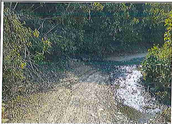
foto 15: Baden KM 06 + 380, se encuentra en regular estado, pero requiere de limpieza
