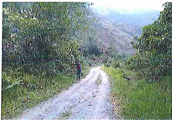
foto 375: KM 18 + 700, Ausencia de material de afirmado, con presencia de deformaciones y erosiones.
