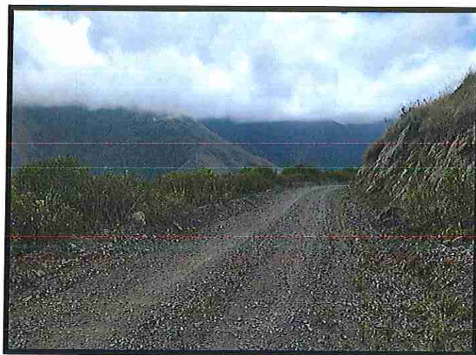
FOTO N° 15 Se puede apreciar el estado de la superficie de rodadura entre el Km 14 + 001- Km 15 + 000
