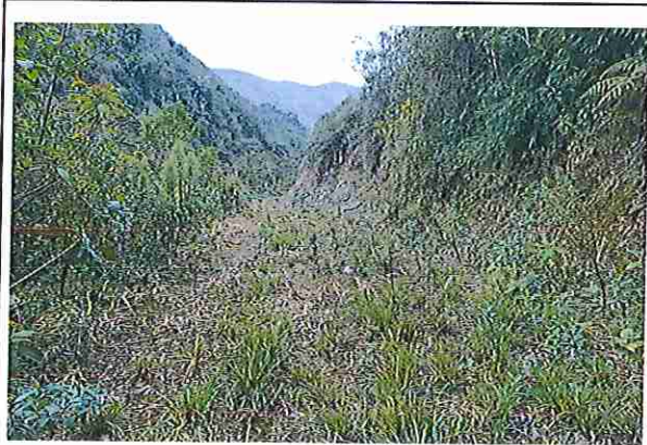
foto 139: KM 06 + 900, Ausencia de material de afirmado, con presencia de deformaciones y erosiones
