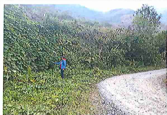
foto 263: KM 13 + 100, donde se puede observar que la capa de rodadura tiene baches y ausencia de material.
