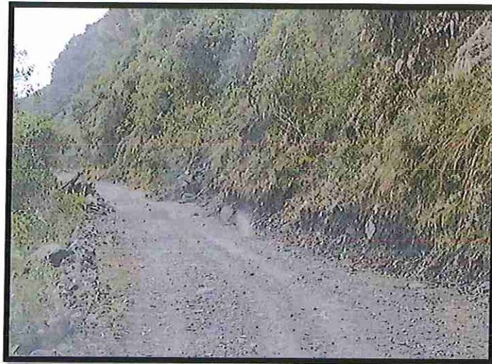
FOTO N° 11 Se puede apreciar el estado de la superficie de rodadura entre el Km 10 + 001- Km 11 + 000
