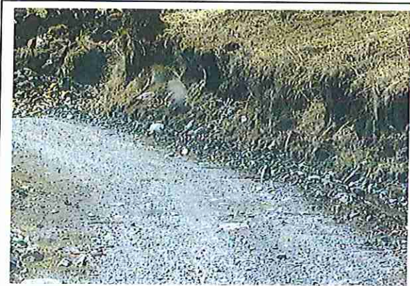
foto 37: KM 01 + 800, donde se puede observar que tiene la capa de rodadura tiene erosión
