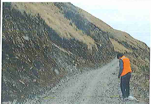
foto 18: KM 04 + 250,Ausencia de material de afirmado, con presencia de deformaciones y erosiones.
