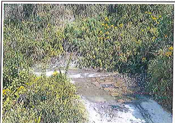
foto 07: baden KM 07 + 400, se encuentra en regular estado requiere de limpieza
