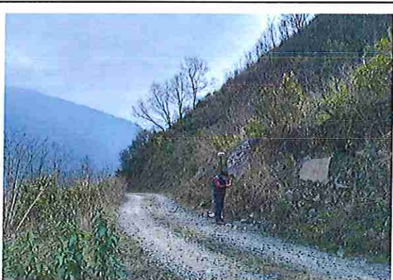
foto 395: KM 19 + 700, Ausencia de material de afirmado, con presencia de deformaciones y ahuellamiento.
