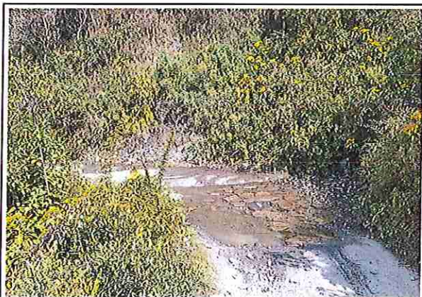
foto 17: baden KM 10+500, se encuentra en regular estado, pero requiere de limpieza
