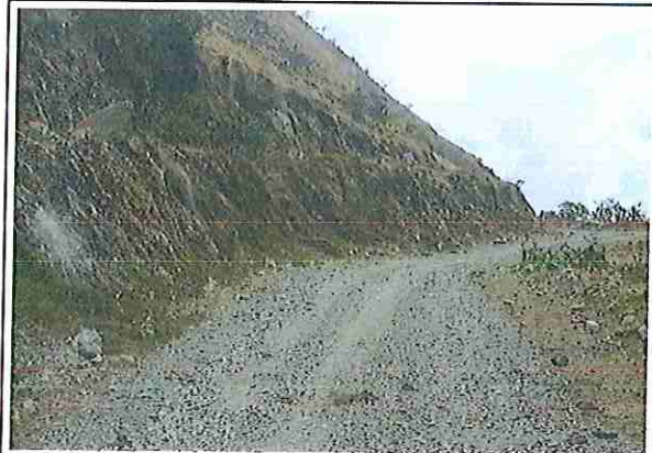
foto 26: KM 06 + 250, Talud margen Der. Ausencia de material de afirmado, con presencia de deformaciones y erosiones.
