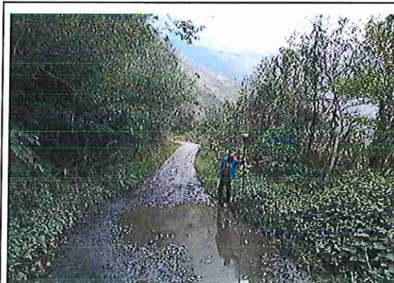
foto 412: KM 20 + 550, Ausencia de material de afirmado, con presencia de deformaciones y erosiones.
