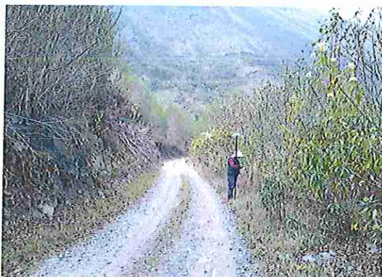
foto 323: KM 16 + 100, Ausencia de material de afirmado, con presencia de deformaciones y erosiones
