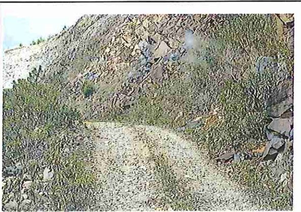
foto 54: KM 02 + 650, Ausencia de material de afirmado, con presencia de deformaciones y erosiones.
