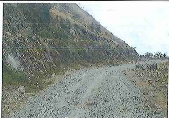
foto 23: KM 05 + 500, Talud margen izq. Ausencia de material de afirmado, con presencia de deformaciones y erosiones.
