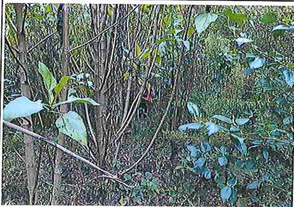
foto 152: KM 07 + 600, Ausencia de material de afirmado, con presencia de deformaciones y erosiones
