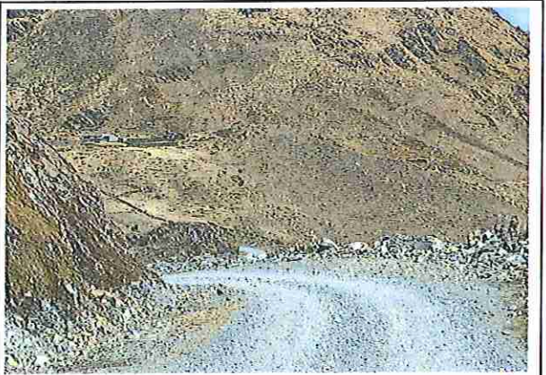
Foto 06: KM 01 + 250, donde se puede observar que tiene la capa de rodadura tiene erosión
