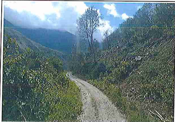
foto 420 KM 20 + 950, Ausencia de material de afirmado, con presencia de deformaciones y erosiones.
