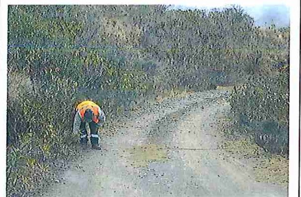
foto 24: KM 01 + 150, Ausencia de material de afirmado, con presencia de deformaciones y erosiones.
