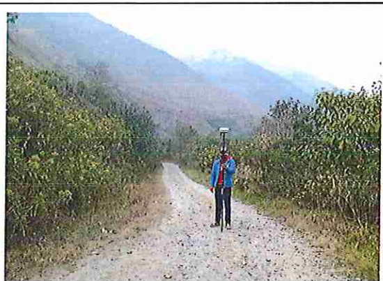
foto 262: KM 13 + 050, donde se puede observar que la capa de rodadura tiene baches y ausencia de material.
