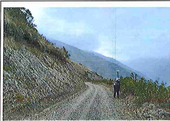
foto 211: KM 10 + 500, donde se puede observar que la capa de rodadura tiene baches y ausencia de material.
