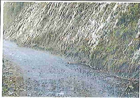
foto 37: KM 09 + 000, Talud margen Der.Ausencia de material de afirmado, con presencia de deformaciones y erosiones.
