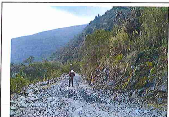
foto 267: KM 13 + 300, donde se puede observar que la capa de rodadura tiene baches y ausencia de material.
