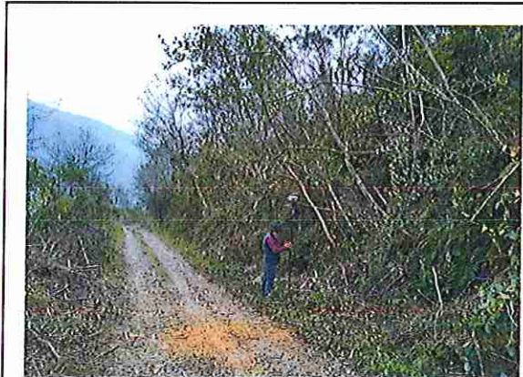
foto 350: KM 17 + 450, Ausencia de material de afirmado, con presencia de deformaciones y ahuellamiento.
