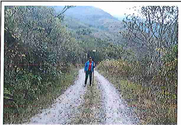
foto 392: KM 19 + 550, Ausencia de material de afirmado, con presencia de deformaciones y ahuellamiento.
