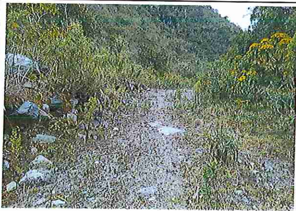
foto 21: KM 05 + 000, donde se puede observar que tiene la capa de rodadura tiene erosión
