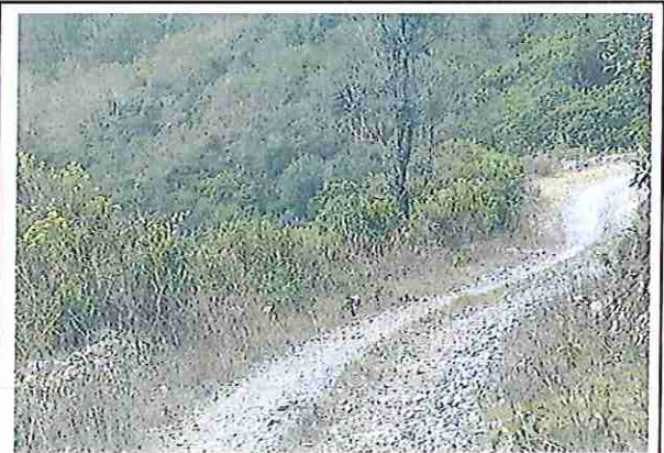
foto 309: KM 15 + 400 Terreno ondulado con un ancho de superficie de 3.92 m.
