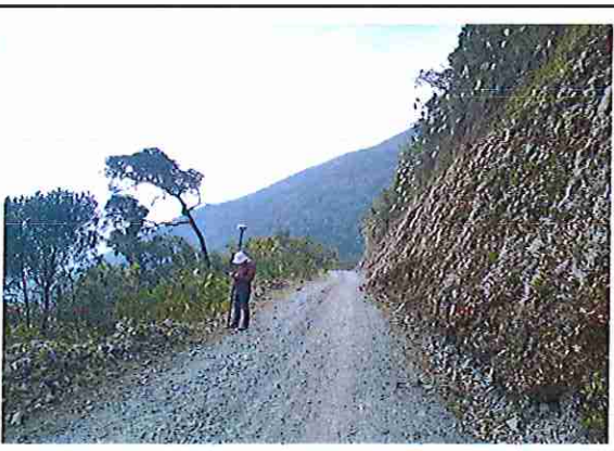
foto 276: KM 13 + 750, donde se puede observar que la capa de rodadura tiene baches y ausencia de material.
