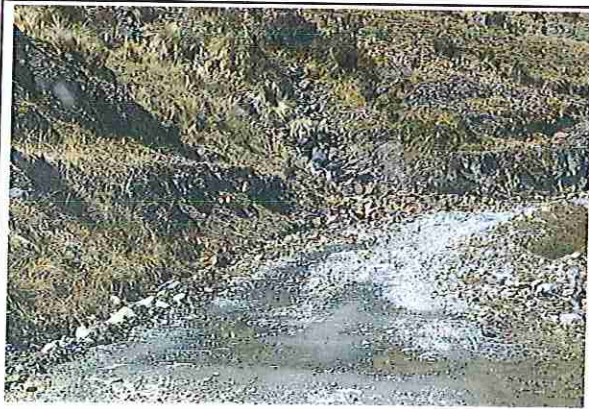
foto 57: KM 02 + 800 ,baden de piedra donde se puede observar que la capa de rodadura presenta ahuellamiento
