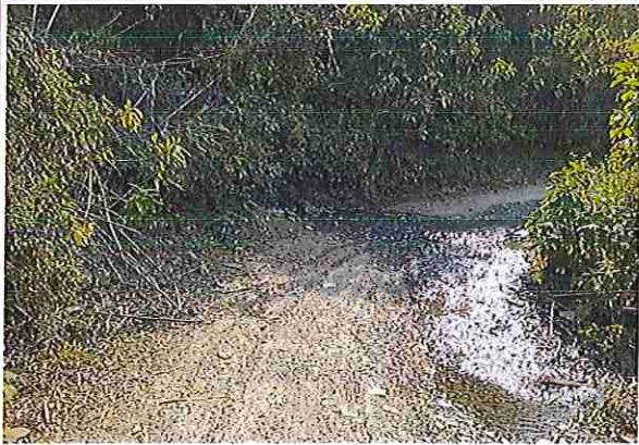
foto 09: baden KM 02 + 550, se encuentra en buen estado, parcialmente obstruida.
