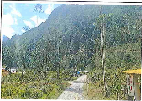
foto 90: KM 22 + 500, Ausencia de material de afirmado, con presencia de deformaciones y erosiones.
