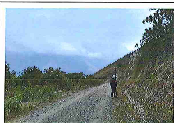
foto 291: KM 14 + 500, donde se puede observar que la capa de rodadura tiene baches y ausencia de material.
