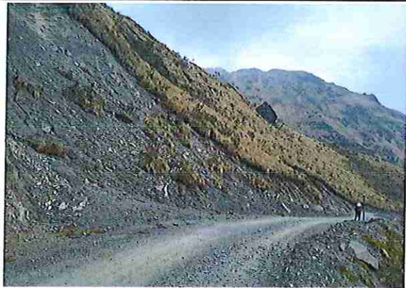
foto 27: KM 01 + 300, donde se puede observar que tiene la capa de rodadura tiene erosión.
