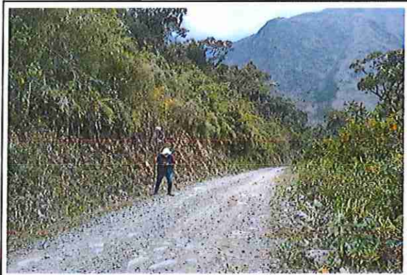
foto 254: KM 12 + 650, Ausencia de material de afirmado, con presencia de deformaciones y ahuellamiento.
