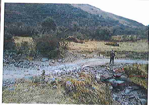
foto 80: KM 03 + 950,Ausencia de material de afirmado, con presencia de deformaciones y erosiones.
