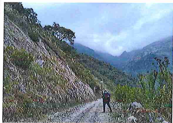
foto 206: KM 10 + 250, donde se puede observar que la capa de rodadura tiene baches y ausencia de material.
