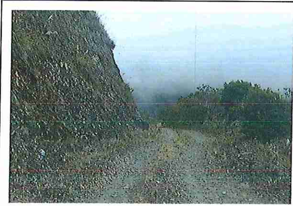
foto 79: KM 03 + 900, donde se puede observar que tiene la capa de rodadura tiene erosión
