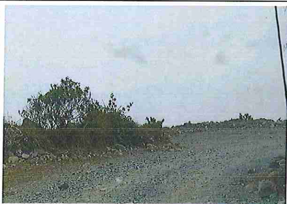
foto 183: KM 09 + 100, Ausencia de material de afirmado, con presencia de deformaciones y erosiones.
