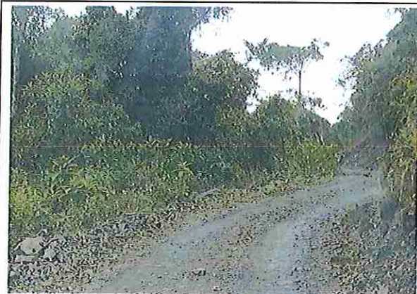
foto 217: KM 10 + 800, donde se puede observar que la capa de rodadura tiene baches y ausencia de material.
