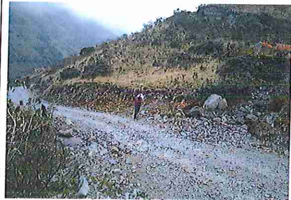
foto 64: KM 03 + 150,baden de piedra donde se puede observar que la capa de rodadura presenta ahuellamiento
