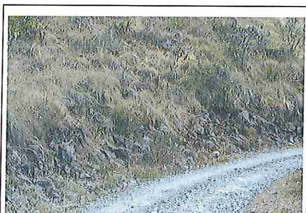
foto 30: KM 07 + 250, Talud margen Der. Ausencia de material de afirmado, con presencia de deformaciones y erosiones.
