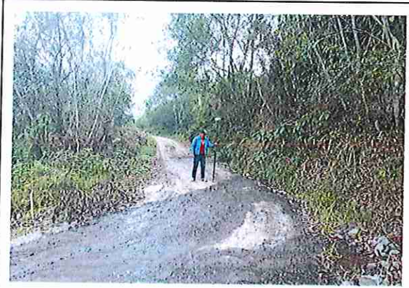
foto 314: KM 15 + 650, Ausencia de material de afirmado, con presencia de deformaciones y erosione
