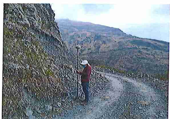
foto 131: KM 06 + 500, Talud margen Izd. Ausencia de material de afirmado, con presencia de deformaciones y erosiones.
