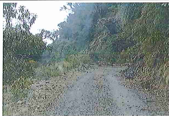
foto 213: KM 10 + 600, donde se puede observar que la capa de rodadura tiene baches y ausencia de material.
