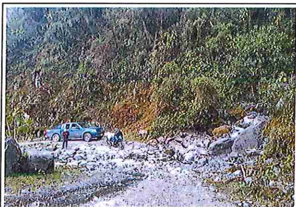
foto 03: tajea, KM 07 + 670, se encuentra en estado regular requiere de limpieza.
