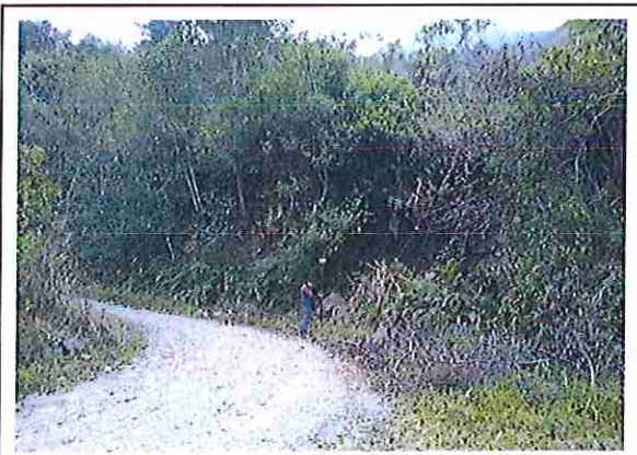
foto 354: KM 17 + 650, Ausencia de material de afirmado, con presencia de deformaciones y erosiones.
