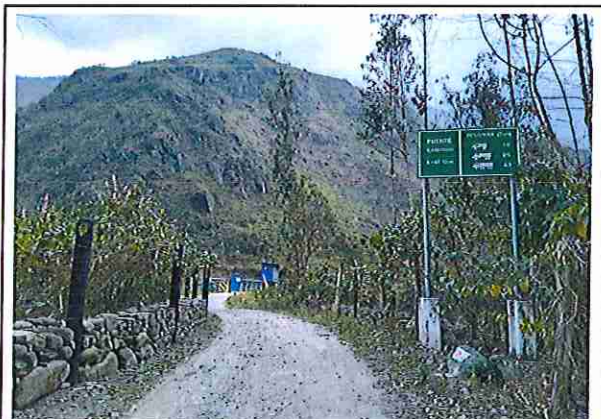
FOTO N°05: SEÑAL INFORMATIVA KM 22 + 894, estado regular. Falta pintura
