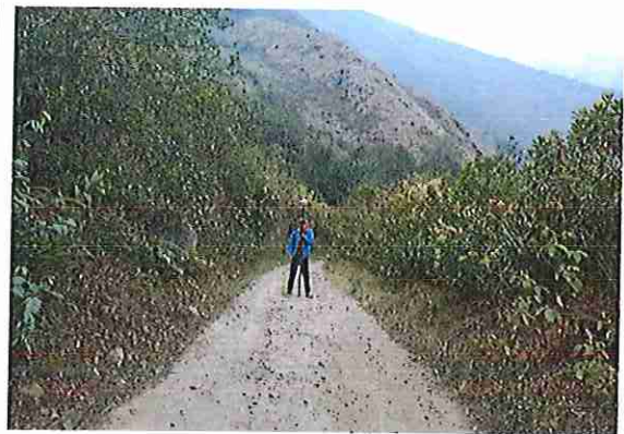
foto 236: KM 11 + 750, donde se puede observar que la capa de rodadura tiene baches y ausencia de material.
