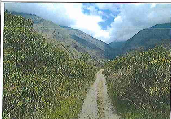
foto 425: KM 21 + 200, Ausencia de material de afirmado, con presencia de deformaciones y erosiones.
