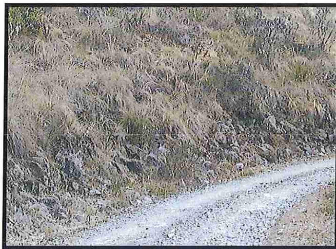
FOTO N° 08 Se puede apreciar el estado de la superficie de rodadura entre el Km 7 + 001- Km 8 + 000
