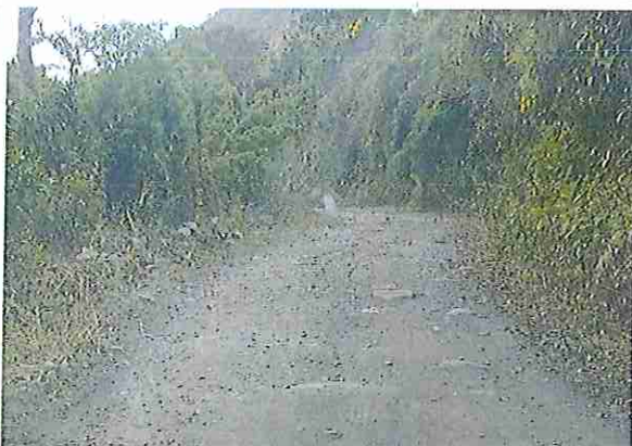
foto 53: KM 13 + 000, donde se puede observar que la capa de rodadura tiene baches y ausencia de material.
