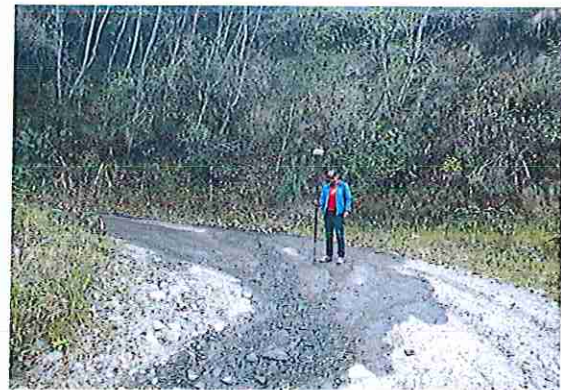
foto 364: KM 18 + 150, Ausencia de material de afirmado, con presencia de deformaciones y erosiones.
