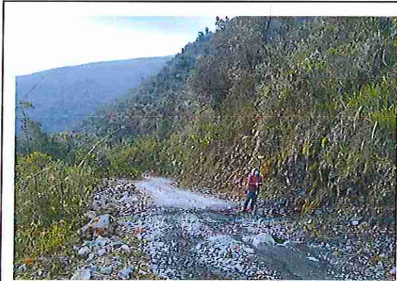
foto 199: KM 09 + 900 Talud margen Der.Ausencia de material de afirmado, con presencia de deformaciones y erosiones.
