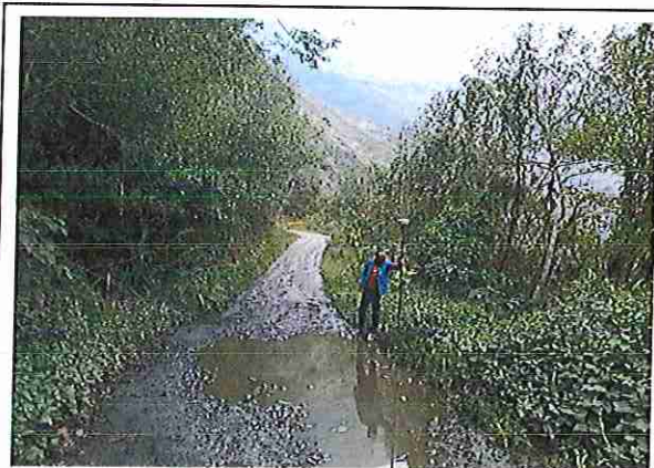
foto 64: KM 15 + 750, Ausencia de material de afirmado, con presencia de deformaciones y erosiones
