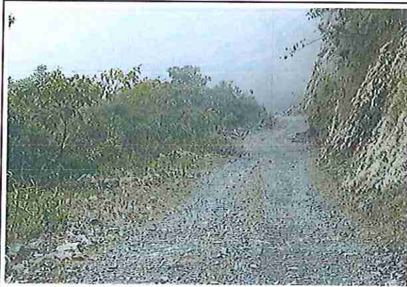
foto 175: KM 08 + 700, Ausencia de material de afirmado, con presencia de deformaciones y erosiones.
