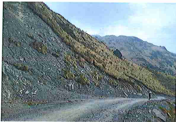
foto 07: KM 00 + 300, inicio del camino vecinal donde se ve ahuellamiento en la capa de rodadura.
