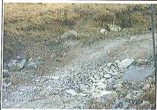
foto 134: KM 06 + 650, Ausencia de material de afirmado, con presencia de deformaciones y erosiones.
