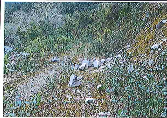
foto 109: KM 05 + 400, donde se puede observar que tiene la capa de rodadura tiene erosión
