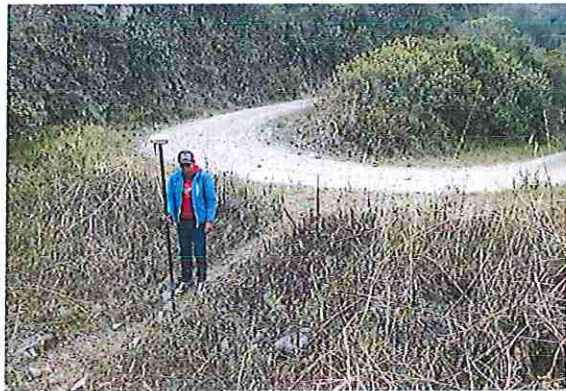
foto 243: KM 12 + 100, Ausencia de material de afirmado, con presencia de deformaciones y erosiones.
