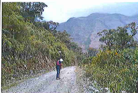
foto 251: KM 12 + 500, Ausencia de material de afirmado, con presencia de deformaciones .
