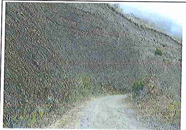
foto 08: KM 01 + 750, Ausencia de material de afirmado, con presencia de deformaciones y erosiones.
