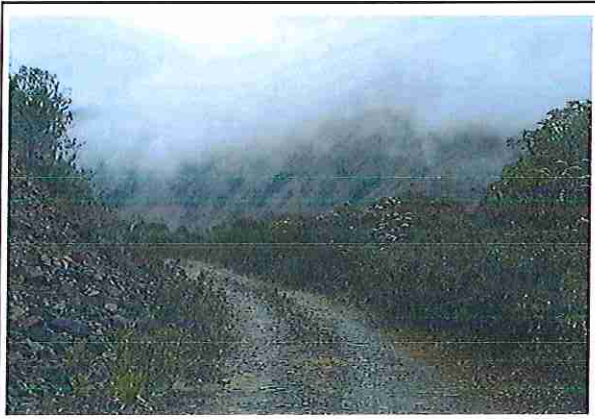
foto 04: KM 00 + 750, Ausencia de material de afirmado, con presencia de deformaciones y erosiones.
