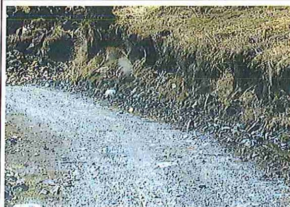
foto 18: KM 00 + 850, donde se puede observar que tiene la capa de rodadura tiene erosión.
