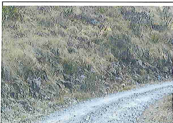
foto 167: KM 08 + 300, Ausencia de material de afirmado, con presencia de deformaciones y erosiones.
