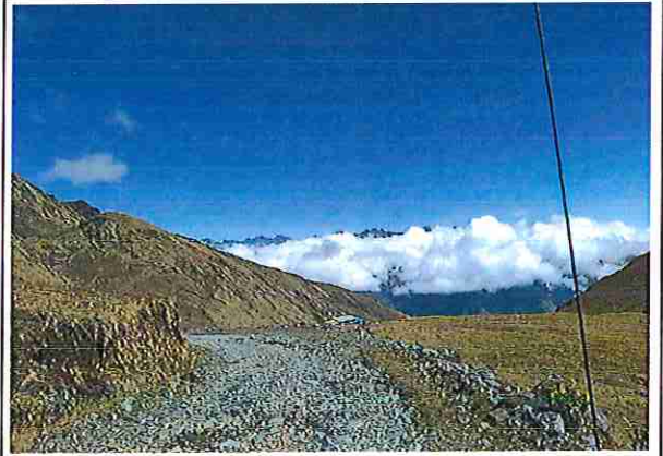
foto 04: KM 00 + 750, donde se puede observar que tiene la capa de rodadura tiene erosión
