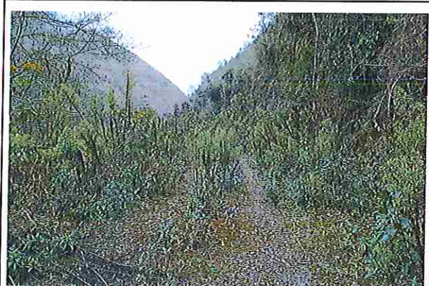
Foto 102: KM 05 + 050, donde se puede observar que tiene la capa de rodadura tiene erosión
