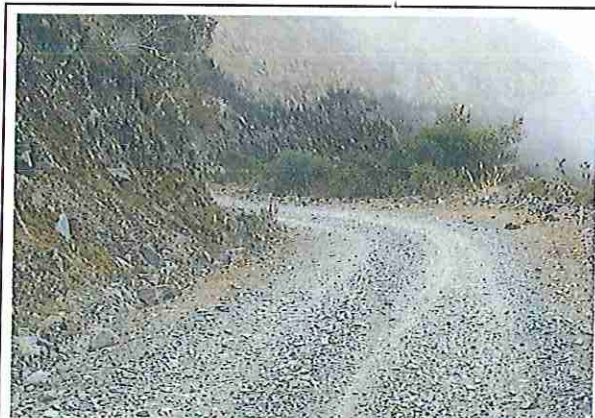
foto 113: KM 05 + 600, Talud margen izq. Ausencia de material de afirmado, con presencia de deformaciones y erosiones.
