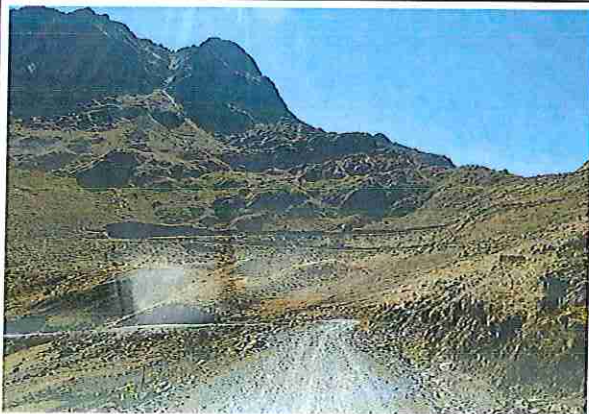
foto 09: KM 00 + 400, donde se puede observar que tiene la capa de rodadura tiene erosión
