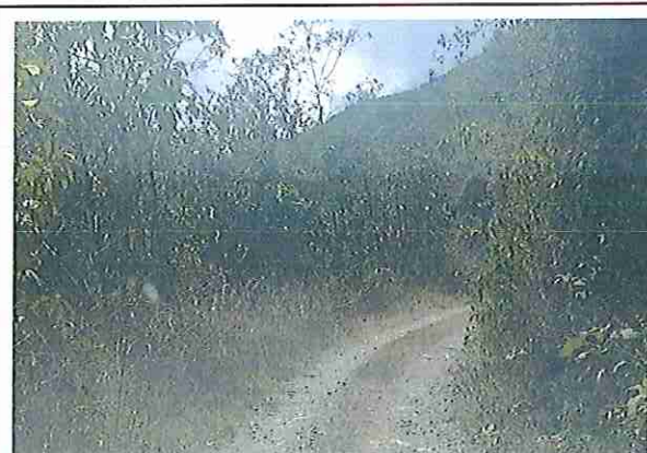
foto 341: KM 17 + 000, Ausencia de material de afirmado, con presencia de deformaciones y erosiones.
