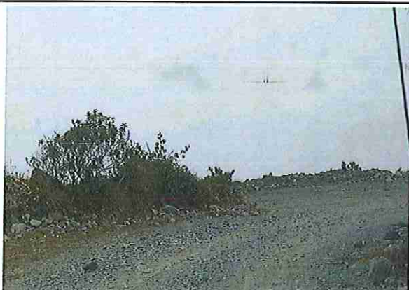
foto 161: KM 08 + 000, Ausencia de material de afirmado, con presencia de deformaciones y erosiones.
