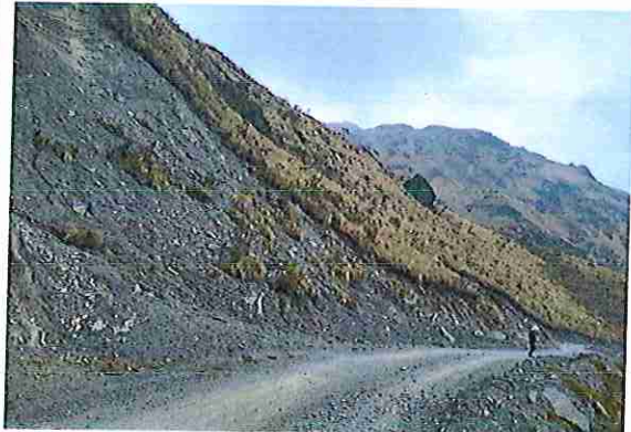
foto 75: KM 03 + 700, Ausencia de material de afirmado, con presencia de deformaciones y erosiones.
