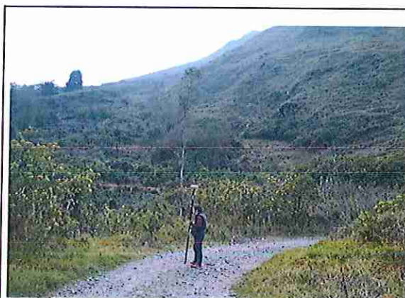
foto 344: KM 17 + 150, Ausencia de material de afirmado, con presencia de deformaciones y ahuellamiento.
