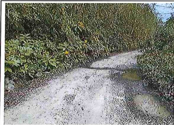
foto 13: baden KM 05 + 910 en regular estado.
