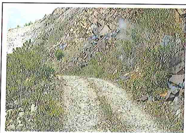
foto 11: KM 02 + 500, Ausencia de material de afirmado, con presencia de deformaciones y erosiones.
