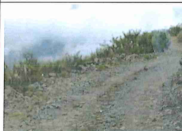
foto 225: KM 11 + 200, Ausencia de material de afirmado, con presencia de deformaciones y erosiones
