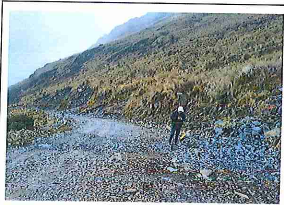
foto 55: KM 02 + 700, Ausencia de material de afirmado, con presencia de deformaciones y erosiones.
