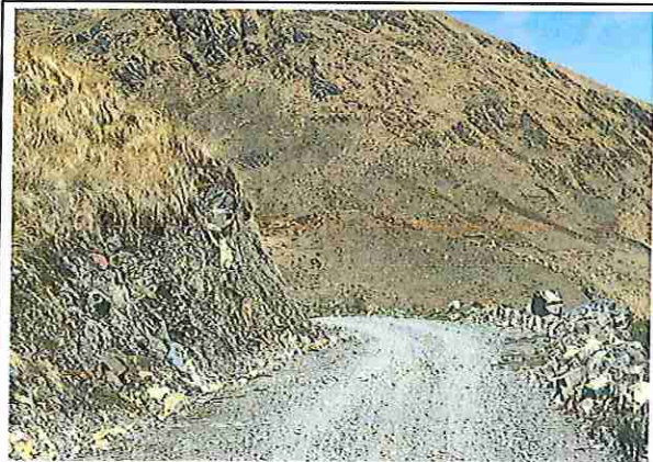
foto 25: KM 01 + 200, donde se puede observar que tiene la capa de rodadura tiene erosión.
