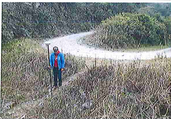
foto 287: KM 14 + 300, talud margen lsd. Ausencia de material de afirmado, con presencia de deformaciones y erosione.
