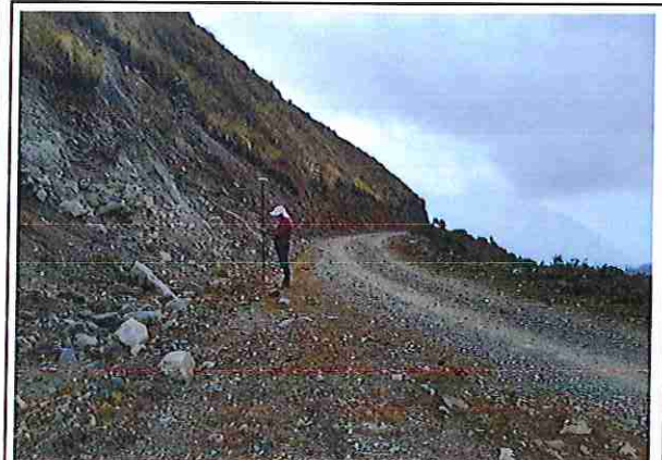
foto 08: KM 01 + 750, donde se puede observar que tiene la capa de rodadura tiene erosión.
