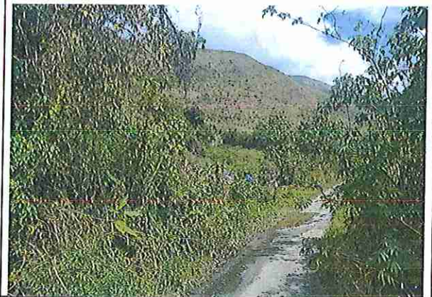
foto 86: KM 21 + 250, Ausencia de material de afirmado, con presencia de deformaciones y erosiones.
