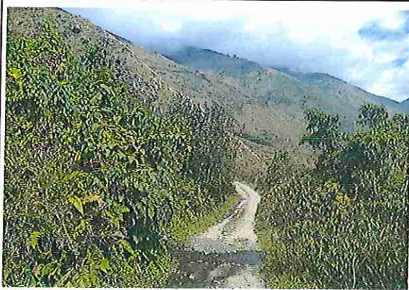
foto 435: KM 21 + 700, Ausencia de material de afirmado, con presencia de deformaciones y erosiones.
