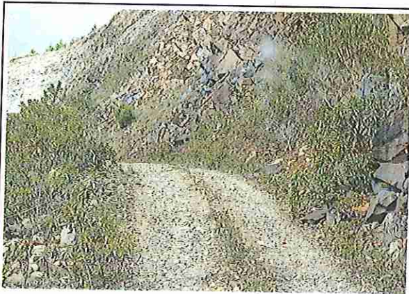
foto 13: KM 03 + 000, Ausencia de material de afirmado, con presencia de deformaciones y erosiones.
