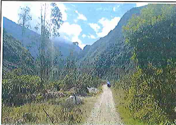
foto 424: KM 21 + 150, Ausencia de material de afirmado, con presencia de deformaciones y erosiones.
