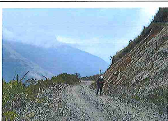
foto 215: KM 10 + 700, donde se puede observar que la capa de rodadura tiene baches y ausencia de material.
