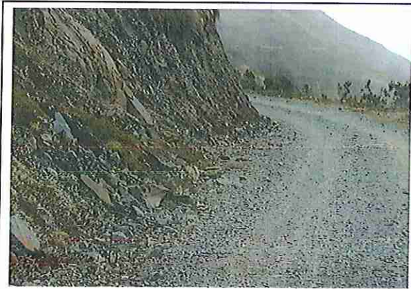
foto 103: KM 05 + 100, Ausencia de material de afirmado, con presencia de deformaciones y erosiones.
