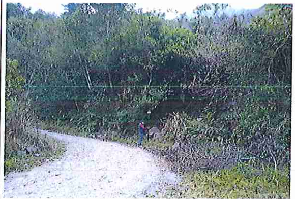
foto 382: KM 19 + 050, Ausencia de material de afirmado, con presencia de deformaciones y erosiones.
