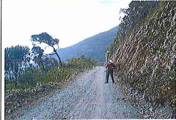
foto 302: KM 15+ 050, donde se puede observar que la capa de rodadura tiene baches y ausencia de material.
