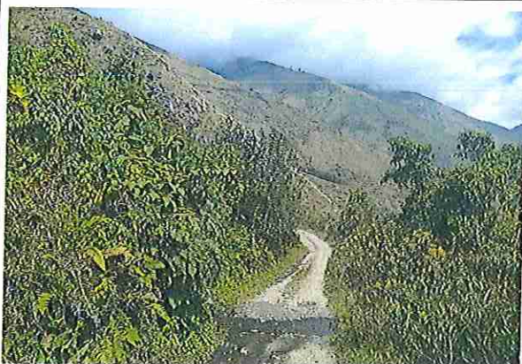
foto 419: KM 20 + 900, Ausencia de material de afirmado, con presencia de deformaciones y erosiones.
