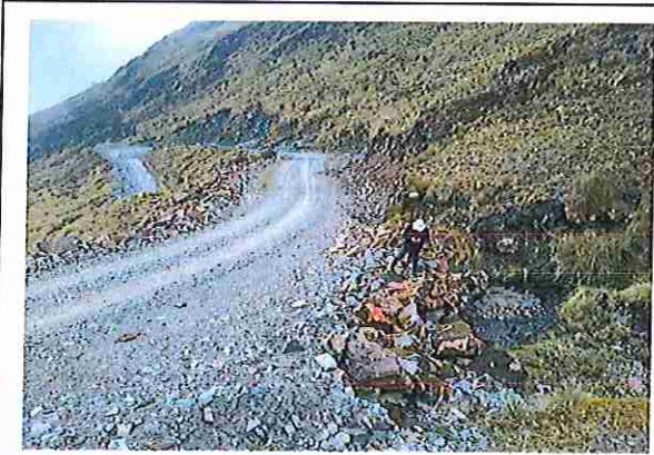
foto 43: KM 02 + 100, donde se puede observar que tiene la capa de rodadura tiene erosión
