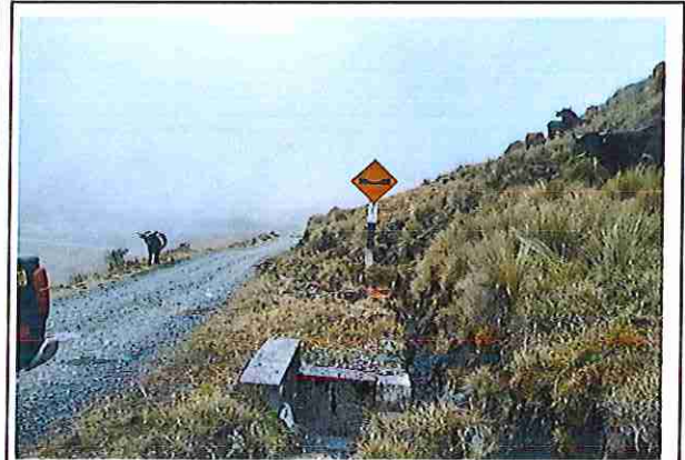
FOTO N°02: SEÑAL PREVENTIVA KM 06 + 110, estado regular. Falta pintura.
