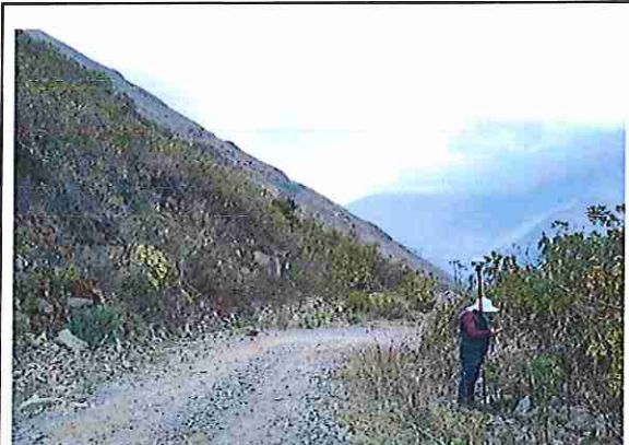
foto 216: KM 10 + 750, donde se puede observar que la capa de rodadura tiene baches y ausencia de material.
