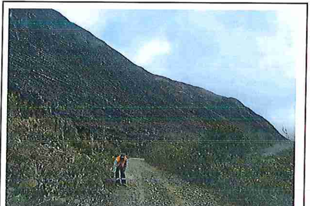
foto 16: KM 00 + 750, Ausencia de material de afirmado, con presencia de deformaciones y erosiones.
