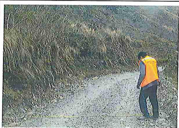
foto 129: KM 06 + 400, Talud margen Izd. Ausencia de material de afirmado, con presencia de deformaciones y erosiones.
