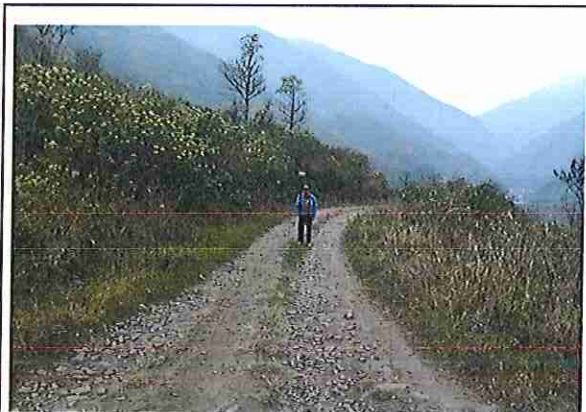
foto 403: KM 20 + 100, Ausencia de material de afirmado y erosiones por falta de baden.
