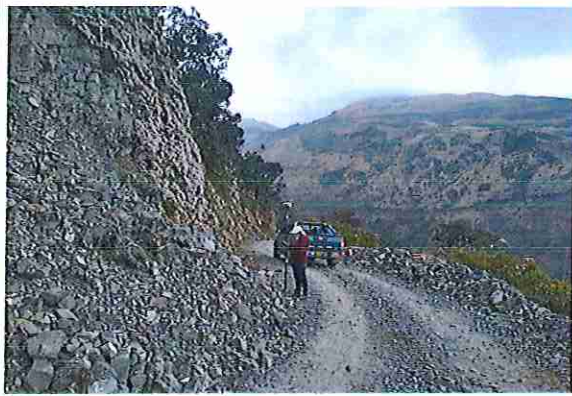
foto 279: KM 13 + 900, donde se puede observar que la capa de rodadura tiene baches y ausencia de material.
