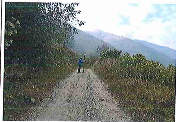
foto 418: KM 20 + 850, Ausencia de material de afirmado, con presencia de deformaciones y erosiones.
