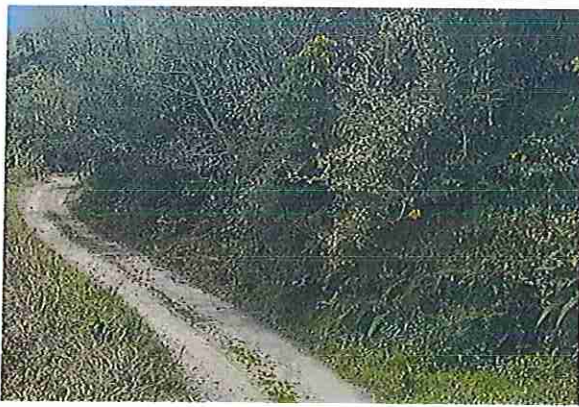
foto 321: KM 16 + 000, Ausencia de material de afirmado, con presencia de deformaciones y erosiones
