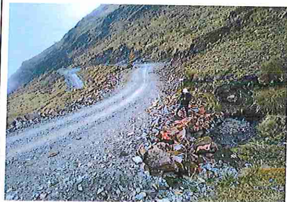
foto 82: KM 04 + 050,Ausencia de material de afirmado, con presencia de deformaciones y erosiones.
