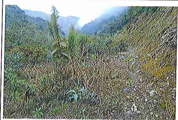
foto 130: KM 06 + 450, Ausencia de material de afirmado, con presencia de deformaciones y erosiones
