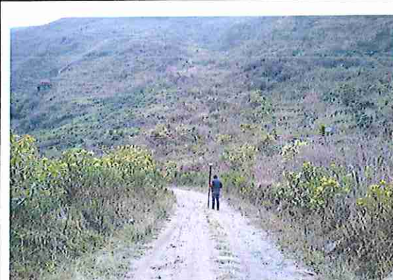
foto 306: KM 15 + 250, Ausencia de material de afirmado, con presencia de deformaciones y erosiones
