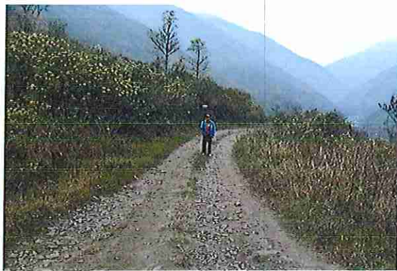
foto 351: KM 17 + 500, Ausencia de material de afirmado, con presencia de deformaciones y ahuellamiento.
