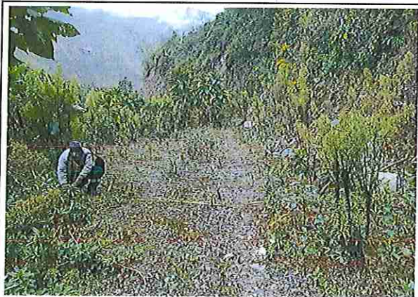
foto 25: KM 06 + 000, Ausencia de material de afirmado, con presencia de deformaciones y erosiones
