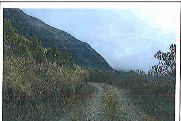
foto 30: KM 01 + 450, Ausencia de material de afirmado, con presencia de deformaciones y erosiones.
