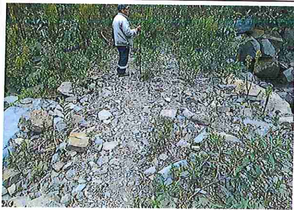
foto 93: KM 04 + 600, donde se puede observar que tiene la capa de rodadura tiene erosión
