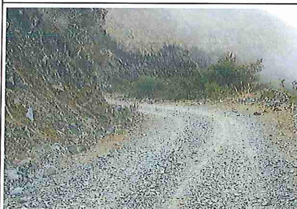
foto 22: KM 05 + 250, Ausencia de material de afirmado, con presencia de deformaciones y erosiones.
