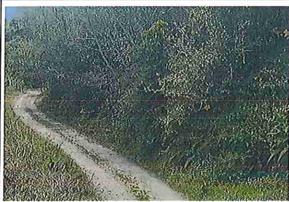
foto 325: KM 16 + 200, Ausencia de material de afirmado, con presencia de deformaciones y erosiones
