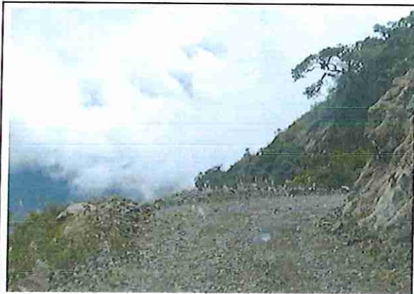
foto 45: KM 11 + 000, donde se puede observar que la capa de rodadura tiene baches y ausencia de material.
