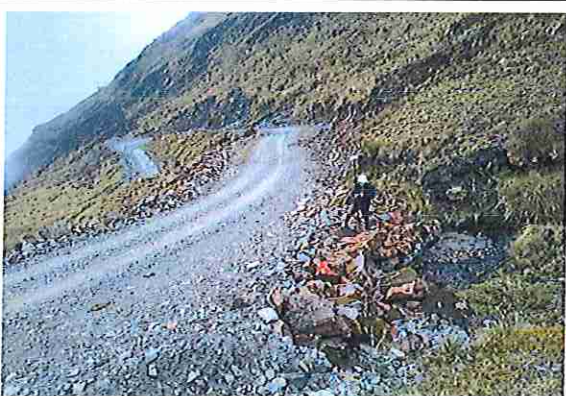
foto 107: KM 05 + 300, Talud margen der. Ausencia de material de afirmado, con presencia de deformaciones y erosiones.
