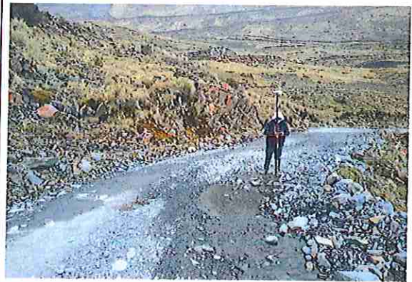
foto 128: KM 06 + 350, Ausencia de material de afirmado, con presencia de deformaciones y erosiones.
