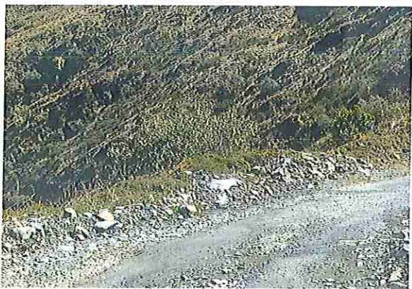
foto 53: KM 02 + 600, Ausencia de material de afirmado, con presencia de deformaciones y erosiones.
