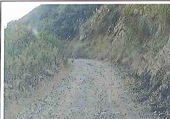
foto 245: KM 12 + 200, donde se puede observar que la capa de rodadura tiene baches y ausencia de material.
