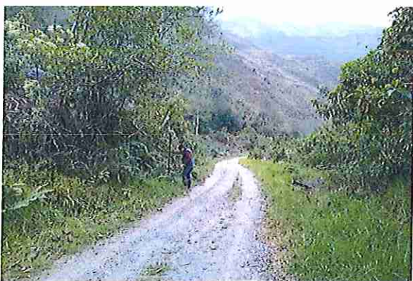
foto 383: KM 19 + 100, Ausencia de material de afirmado, con presencia de deformaciones y erosiones.
