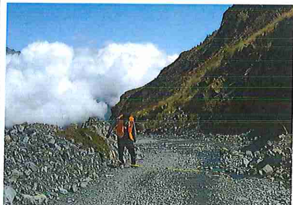
Foto 10: KM 00 + 450, donde se puede observar que tiene la capa de rodadura tiene erosión
