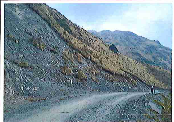
foto 03: KM 00 + 500, donde se puede observar que tiene la capa de rodadura tiene erosión
