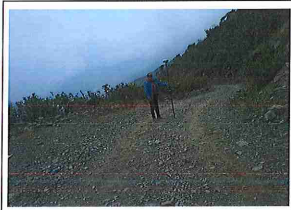
foto 212: KM 10 + 550, donde se puede observar que la capa de rodadura tiene baches y ausencia de material.
