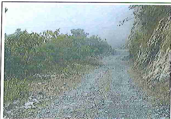
foto 33: KM 08 + 000, Ausencia de material de afirmado, con presencia de deformaciones y erosiones.
