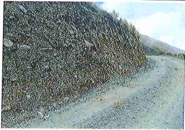
foto 117: KM 05 + 800, Talud margen izq. Ausencia de material de afirmado, con presencia de deformaciones y erosiones.
