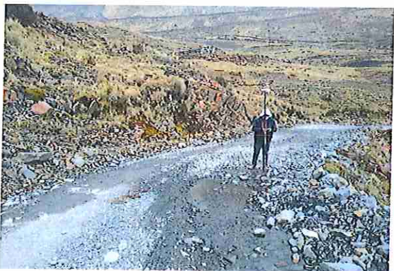
foto 59: KM 02 + 900 ,baden de piedra donde se puede observar que la capa de rodadura presenta ahuellamiento
