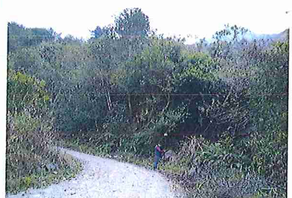
foto 384: KM 19 + 150, Ausencia de material de afirmado, con presencia de deformaciones y erosiones.
