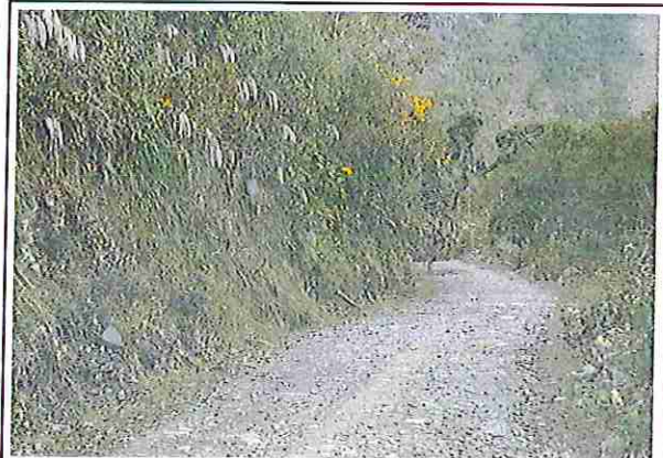
foto 52: KM 12 + 750, Ausencia de material de afirmado, con presencia de deformaciones y ahuellamiento.
