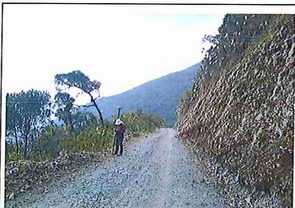
foto 299: KM 14 + 900, Ausencia de material de afirmado, con presencia de deformaciones y ahuellamiento.
