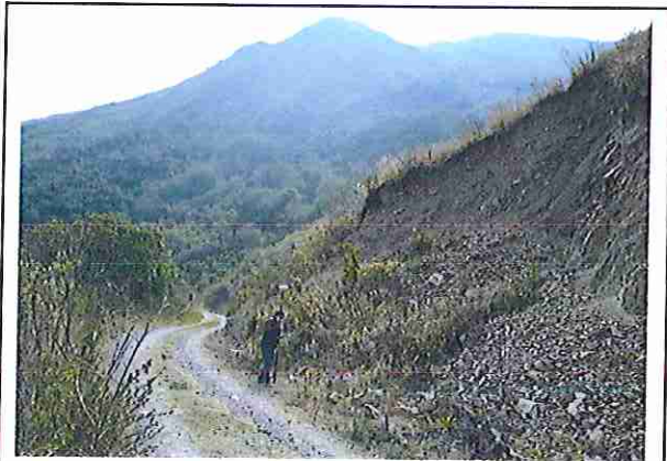
foto 320: KM 15 + 950, Ausencia de material de afirmado, con presencia de deformaciones y erosiones
