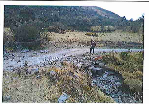
foto 124: KM 06 + 150, Ausencia de material de afirmado, con presencia de deformaciones y erosiones.
