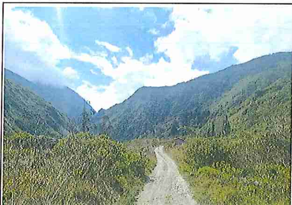
foto 89: KM 22 + 000, Ausencia de material de afirmado, con presencia de deformaciones y erosiones.
