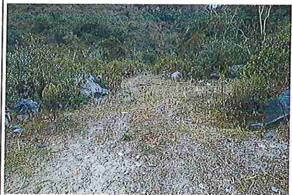
Foto 112: KM 05 + 550, donde se puede observar que tiene la capa de rodadura tiene erosión
