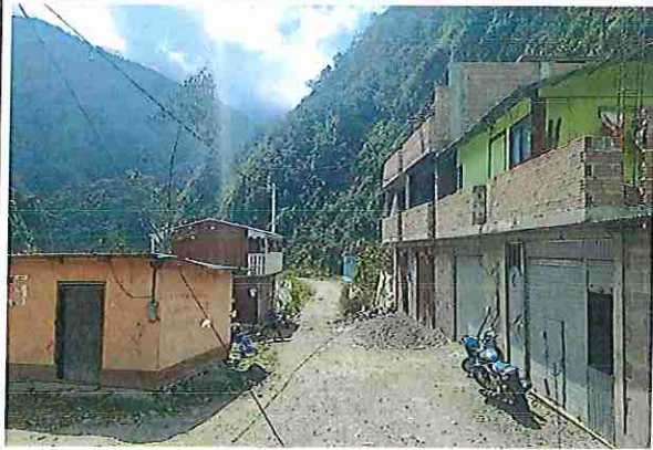
foto 452: KM 22 + 570, Ausencia de material de afirmado, con presencia de deformaciones y erosiones.
