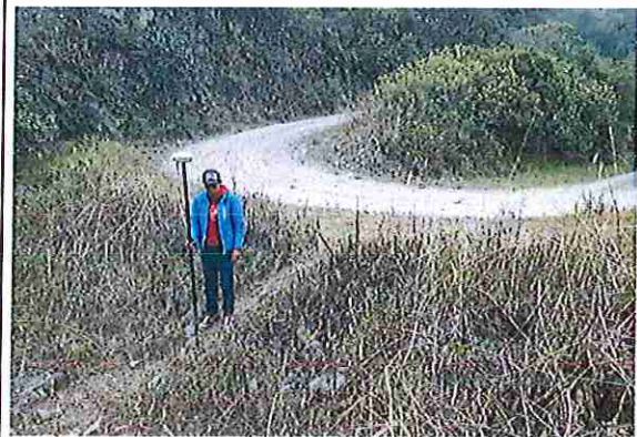
foto 374: KM 18 + 650, Ausencia de material de afirmado, con presencia de deformaciones y ahuellamiento.
