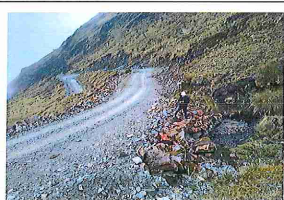
foto 15: KM 00 + 700, donde se puede observar que tiene la capa de rodadura tiene erosión
