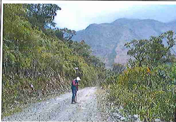
foto 51: KM 12 + 500, Ausencia de material de afirmado, con presencia de deformaciones .
