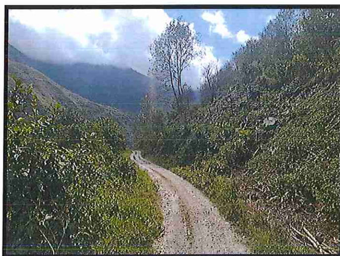
FOTO N° 20 Se puede apreciar el estado de la superficie de rodadura entre el Km 19 + 001- Km 20 + 000
