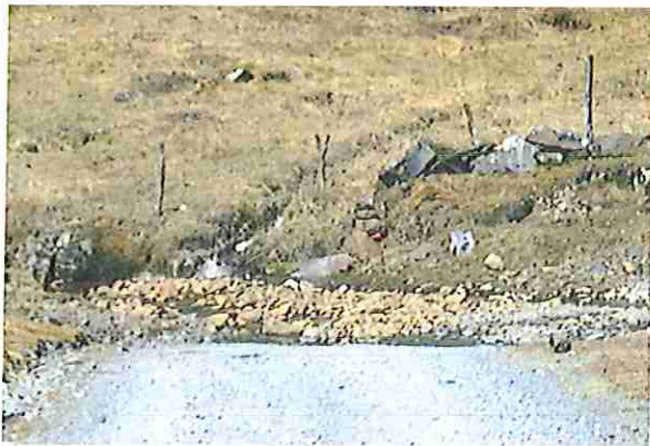
foto 33: KM 01 + 600, donde se puede observar que tiene la capa de rodadura tiene erosión
