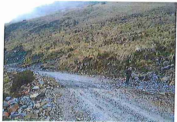
foto 94: KM 04 + 650, Ausencia de material de afirmado, con presencia de deformaciones y erosiones.
