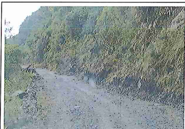
foto 209: KM 10 + 400, donde se puede observar que la capa de rodadura tiene baches y ausencia de material.
