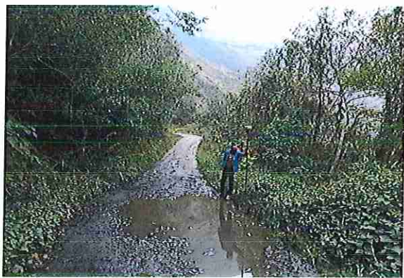
foto 363: KM 18 + 100, Ausencia de material de afirmado, con presencia de deformaciones y erosiones.
