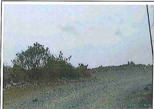
foto 171: KM 08 + 500, Ausencia de material de afirmado, con presencia de deformaciones y erosiones.
