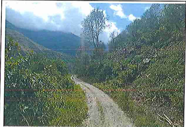
foto 80: KM 19 + 750, Ausencia de material de afirmado, con presencia de deformaciones y ahuellamiento.
