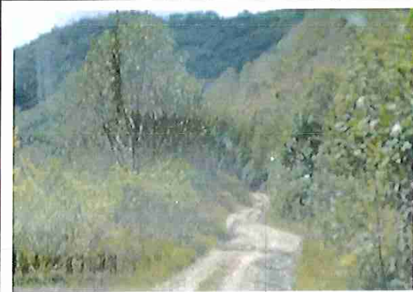
foto 357: KM 17 + 800, Ausencia de material de afirmado, con presencia de deformaciones y erosiones.
