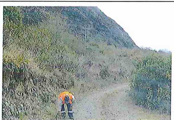
foto 27: KM 01 + 300, Ausencia de material de afirmado, con presencia de deformaciones y erosiones.
