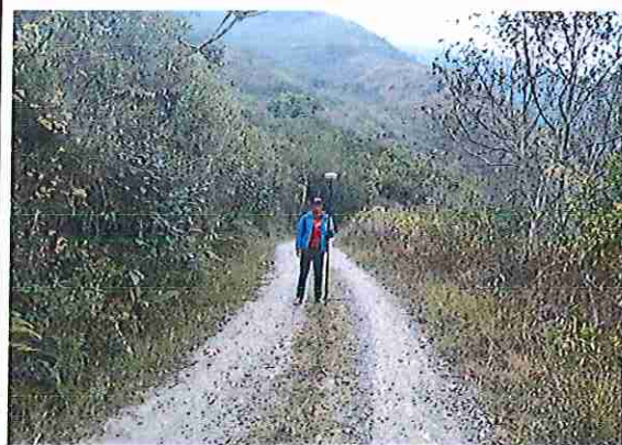
foto 406: KM 20 + 250. Ausencia de material de afirmado, con presencia de deformaciones y ahuellamiento.
