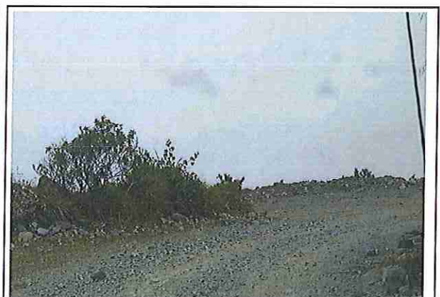
foto 174: KM 08 + 650, Ausencia de material de afirmado, con presencia de deformaciones y erosiones.
