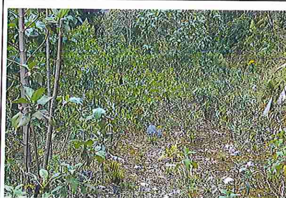
foto 138: KM 06 + 850, Ausencia de material de afirmado, con presencia de deformaciones y erosiones
