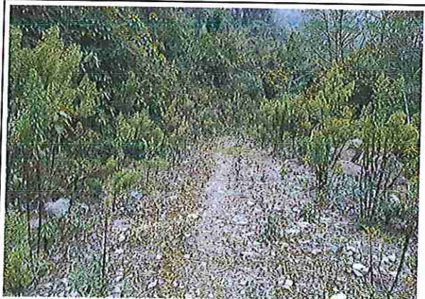
Foto 22: KM 05 + 250, donde se puede observar que tiene la capa de rodadura tiene erosión
