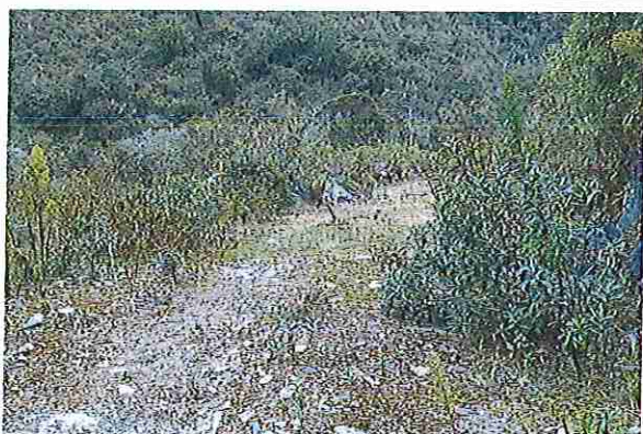
foto 113: KM 05 + 600, donde se puede observar que tiene la capa de rodadura tiene erosión
