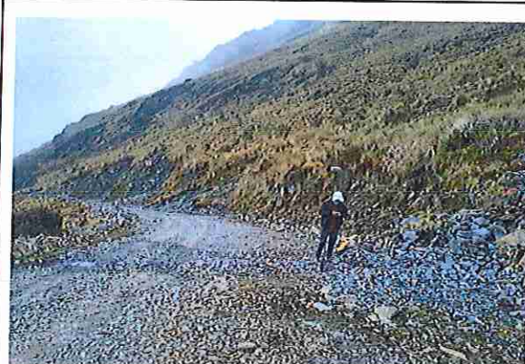
foto 112: KM 05 + 550, Ausencia de material de afirmado, con presencia de deformaciones y erosiones.
