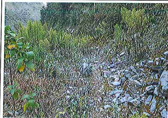
Foto 100: KM 04 + 950, donde se puede observar que tiene la capa de rodadura tiene erosión
