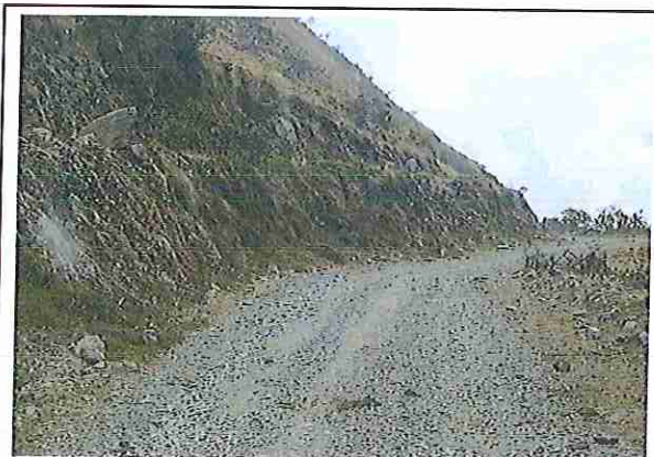
foto 111: KM 05 + 500, Talud margen izq. Ausencia de material de afirmado, con presencia de deformaciones y erosiones.
