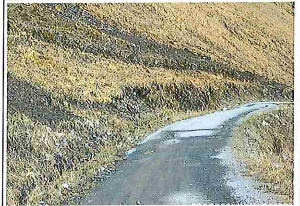
foto 02: KM 00 + 250, donde se puede observar el desgaste de la capa de rodadura y afuercia de agua.
