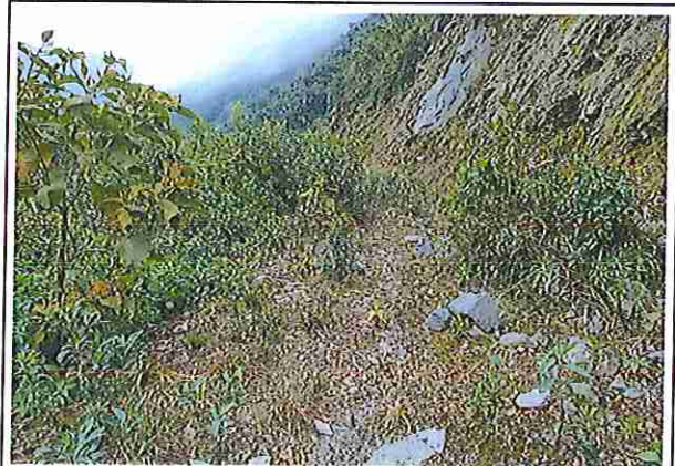
foto 26: KM 06 + 250, Ausencia de material de afirmado, con presencia de deformaciones y erosiones
