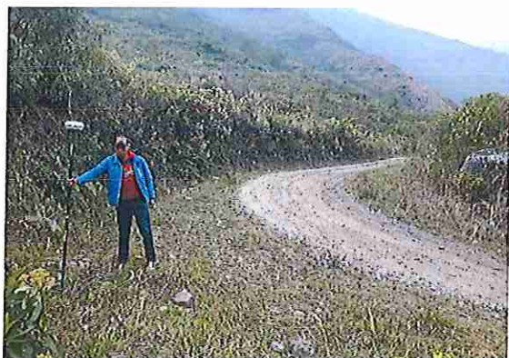
foto 239: KM 11 + 900, donde se puede observar que la capa de rodadura tiene baches y ausencia de material.
