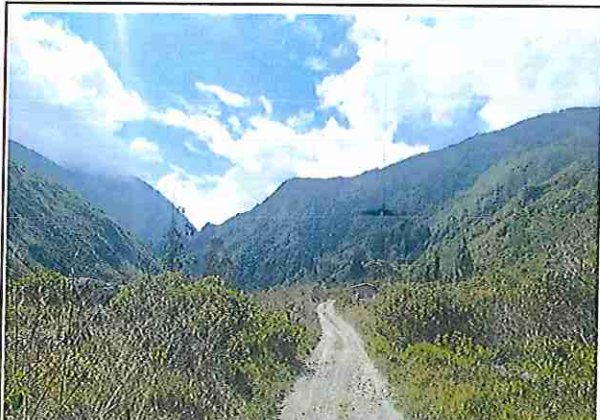
foto 437: KM 21 + 800, Ausencia de material de afirmado, con presencia de deformaciones y erosiones.
