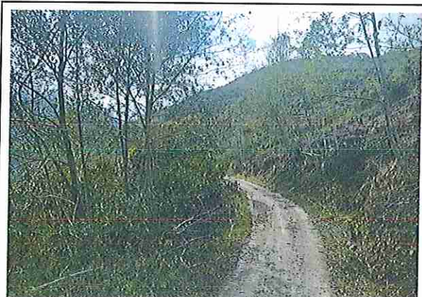
foto 73: KM 18 + 000, Ausencia de material de afirmado, con presencia de deformaciones y erosiones.
