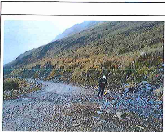
foto 32: KM 01 + 550, donde se puede observar que tiene la capa de rodadura tiene erosión.
