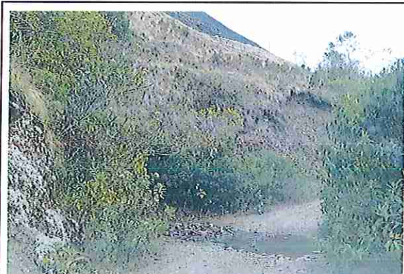
foto 25: KM 01 + 200, Ausencia de material de afirmado, con presencia de deformaciones y erosiones.
