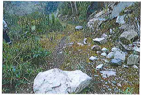
Foto 110: KM 05 + 450, donde se puede observar que tiene la capa de rodadura tiene erosión
