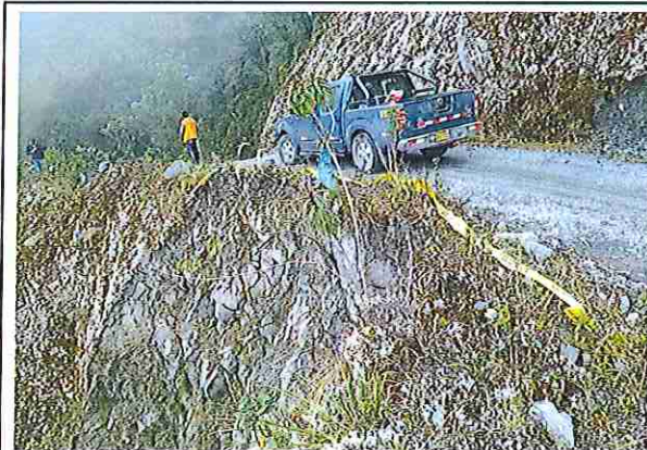
foto 201: KM 10 + 000, Talud margen Der.Ausencia de material de afirmado, con presencia de deformaciones y erosiones.
