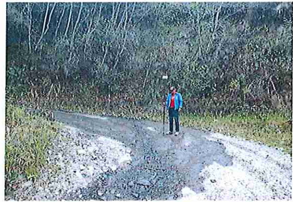
foto 386: KM 19 + 250, Ausencia de material de afirmado, con presencia de deformaciones y ahuellamiento.
