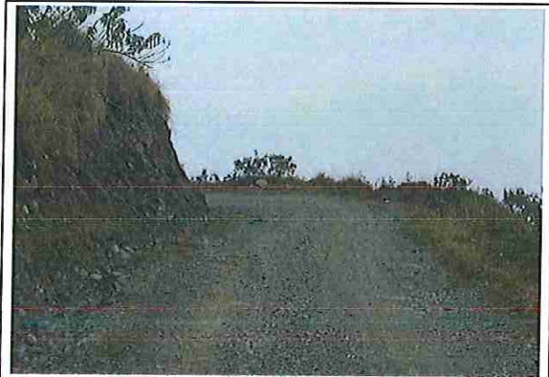
foto 176: KM 08 + 750, Ausencia de material de afirmado, con presencia de deformaciones y erosiones.
