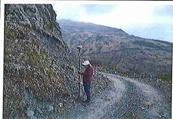
foto 132: KM 06 + 550, Talud margen Izd. Ausencia de material de afirmado, con presencia de deformaciones y erosiones.
