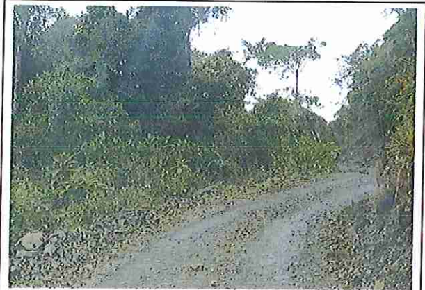
foto 46: KM 11 + 250, donde se puede observar que la capa de rodadura tiene baches y ausencia de material.
