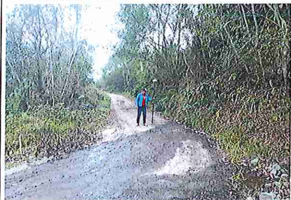
foto 244: KM 12 + 150, Ausencia de material de afirmado, con presencia de deformaciones y erosiones.
