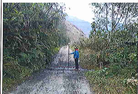
foto 378: KM 18 + 850, Ausencia de material de afirmado, erosiones por falta de baden.
