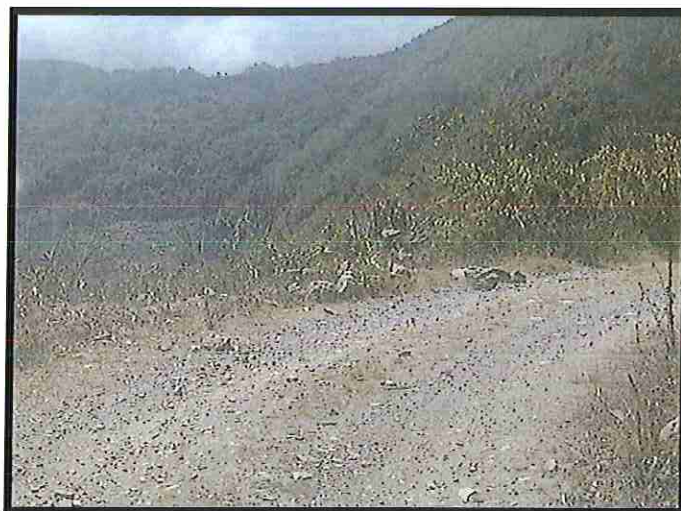
FOTO N° 17 Se puede apreciar el estado de la superficie de rodadura entre el Km 16 + 001- Km 17 + 000
