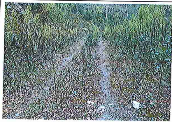
foto 103: KM 05 + 100, donde se puede observar que tiene la capa de rodadura tiene erosión
