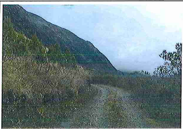
foto 03: KM 00 + 500, Ausencia de material de afirmado, con presencia de deformaciones y erosiones.
