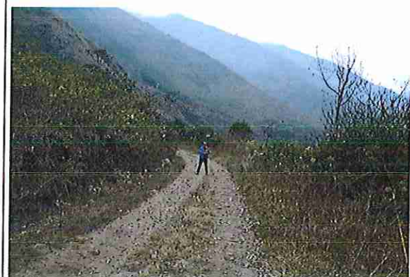
foto 352: KM 17 + 550, Ausencia de material de afirmado, con presencia de deformaciones y ahuellamiento.
