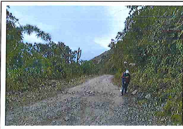
foto 203: KM 10 + 100, donde se puede observar que la capa de rodadura tiene baches y ausencia de material.
