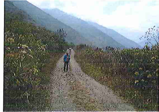
foto 256: KM 12 + 750, Ausencia de material de afirmado, con presencia de deformaciones y ahuellamiento.
