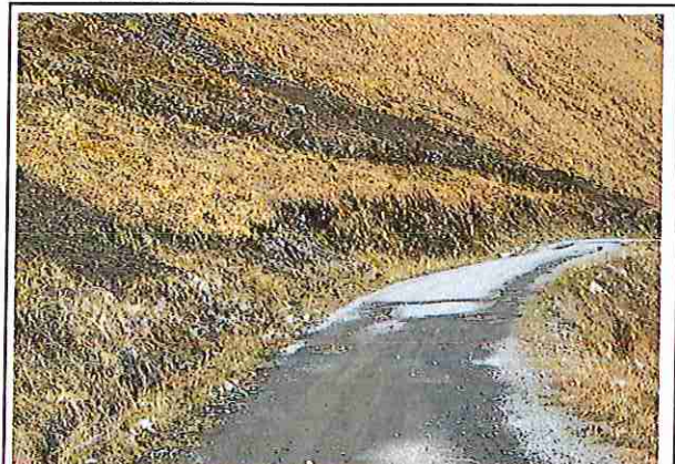
foto 02: KM 00 + 250, donde se puede observar el desgaste de la capa de rodadura y afuencía de agua.
