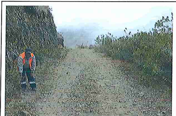
foto 26: KM 01 + 250, Ausencia de material de afirmado, con presencia de deformaciones y erosiones.
