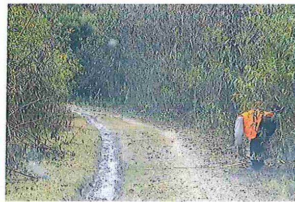
foto 39: KM 01 + 900, Ausencia de material de afirmado, con presencia de deformaciones y erosiones.
