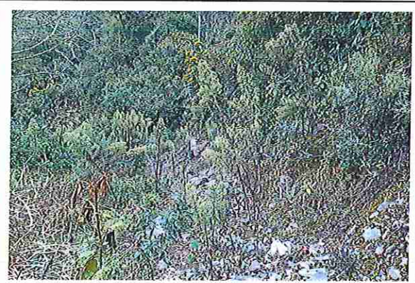
foto 117: KM 05 + 800, Ausencia de material de afirmado, con presencia de deformaciones y erosiones
