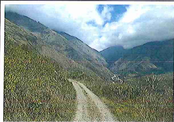
foto 373: KM 18 + 600, Ausencia de material de afirmado, con presencia de deformaciones y erosiones.
