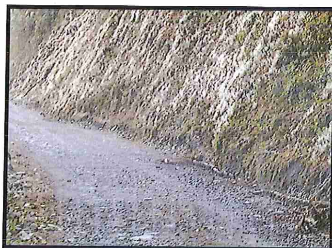
FOTO N° 10 Se puede apreciar el estado de la superficie de rodadura entre el Km 9 + 001- Km 10 + 000
