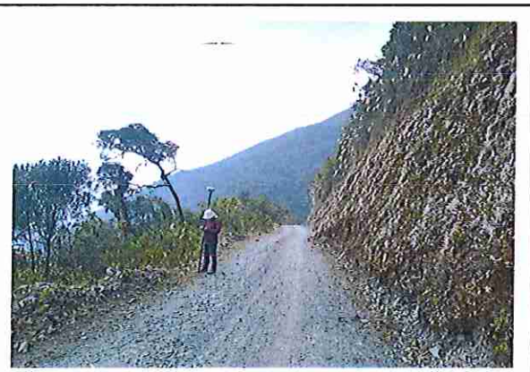
foto 275: KM 13 + 700, donde se puede observar que la capa de rodadura tiene baches y ausencia de material.
