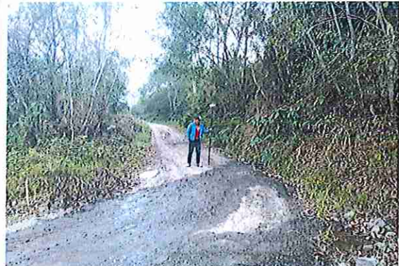
foto 388: KM 19 + 350, Ausencia de material de afirmado, con presencia de deformaciones y ahuellamiento.
