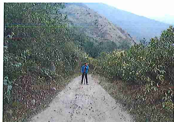
foto 408: KM 20 + 350. Ausencia de material de afirmado, con presencia de deformaciones y ahuellamiento.
