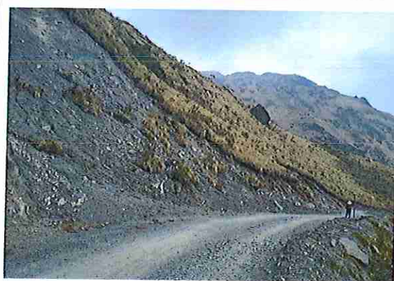
foto 90: KM 04 + 450, Ausencia de material de afirmado, con presencia de deformaciones y erosiones.
