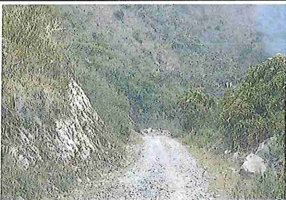
foto 281: KM 14 + 000, talud margen lsd. Ausencia de material de afirmado, con presencia de deformaciones y erosione.
