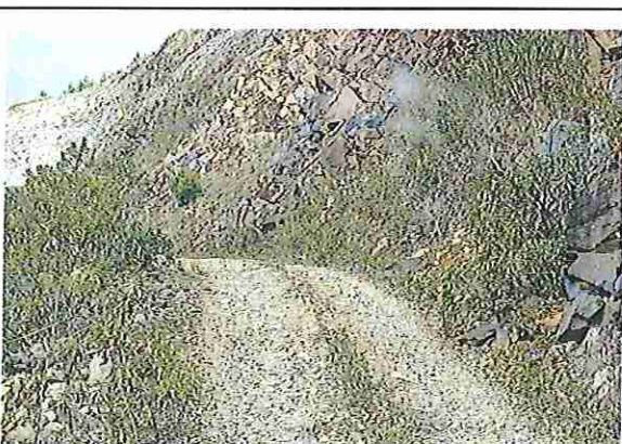
foto 77: KM 03 + 800, donde se puede observar que tiene la capa de rodadura tiene erosión
