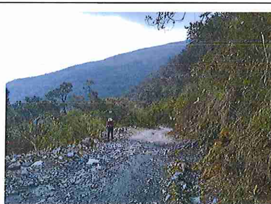
foto 270: KM 13 + 450, donde se puede observar que la capa de rodadura tiene baches y ausencia de material.
