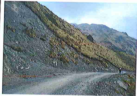
foto 74: KM 03 + 650, Ausencia de material de afirmado, con presencia de deformaciones y erosiones.
