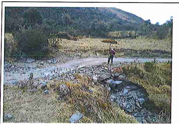
foto 40: KM 01 + 950, donde se puede observar que tiene la capa de rodadura tiene erosión severa.
