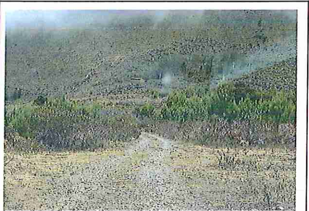
foto 58: KM 02 + 850, Ausencia de material de afirmado, con presencia de deformaciones y erosiones.
