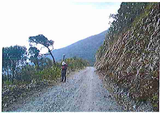
foto 280: KM 13 + 950, donde se puede observar que la capa de rodadura tiene baches y ausencia de material.
