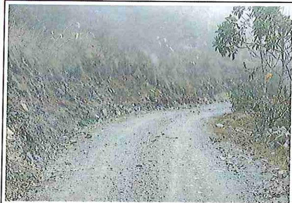
foto 158: KM 07 + 850, Ausencia de material de afirmado, con presencia de deformaciones y erosiones.
