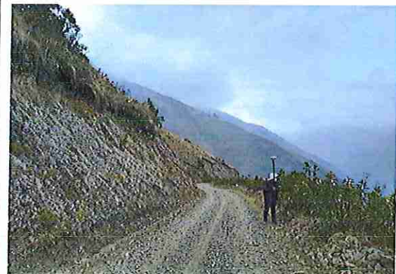
foto 208: KM 10 + 350, donde se puede observar que la capa de rodadura tiene baches y ausencia de material.
