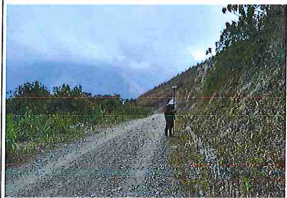
foto 290: KM 14 + 450 Terreno ondulado con un ancho de superficie de 3.97 m.
