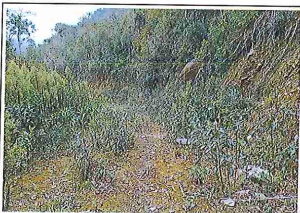
foto 23: KM 05 + 500, donde se puede observar que tiene la capa de rodadura tiene erosión
