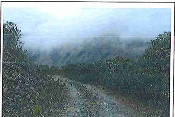
foto 17: KM 00 + 800, Ausencia de material de afirmado, con presencia de deformaciones y erosiones.
