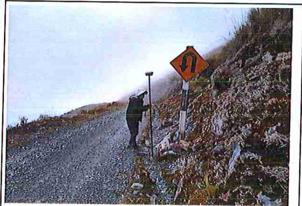
FOTO N°04: SEÑAL PREVENTIVA KM 17 + 110, se encuentra en mal estado.
