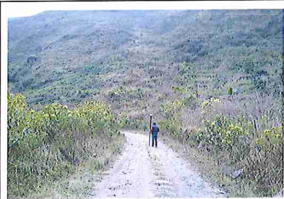
foto 303: KM 15 + 100, donde se puede observar que la capa de rodadura tiene baches y ausencia de material.
