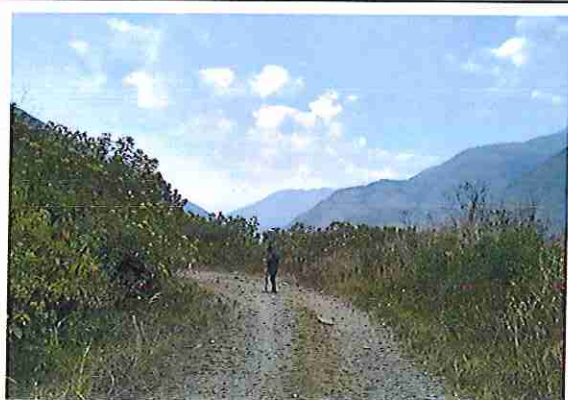
foto 335: KM 16 + 700, Ausencia de material de afirmado, con presencia de deformaciones y erosiones.
