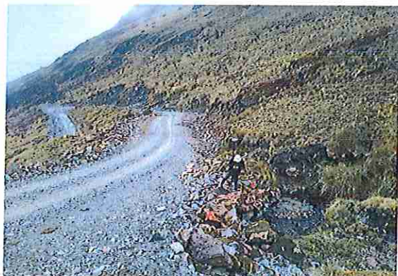
foto 119: KM 05 + 900, Ausencia de material de afirmado, con presencia de deformaciones y erosiones.
