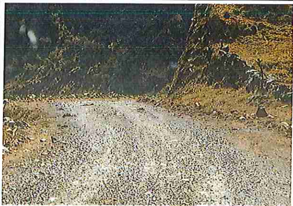
foto 09: KM 02 + 000, donde se puede observar que tiene la capa de rodadura tiene erosión
