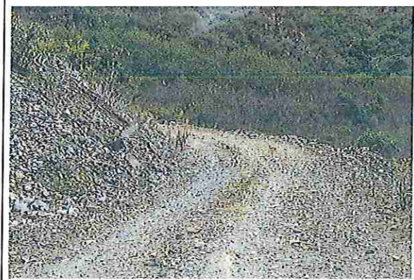
foto 66: KM 03 + 250, Ausencia de material de afirmado, con presencia de deformaciones y erosiones.
