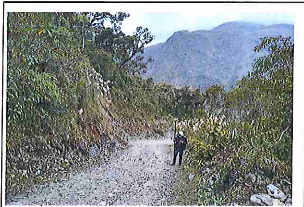
foto 204: KM 10 + 150, donde se puede observar que la capa de rodadura tiene baches y ausencia de material.
